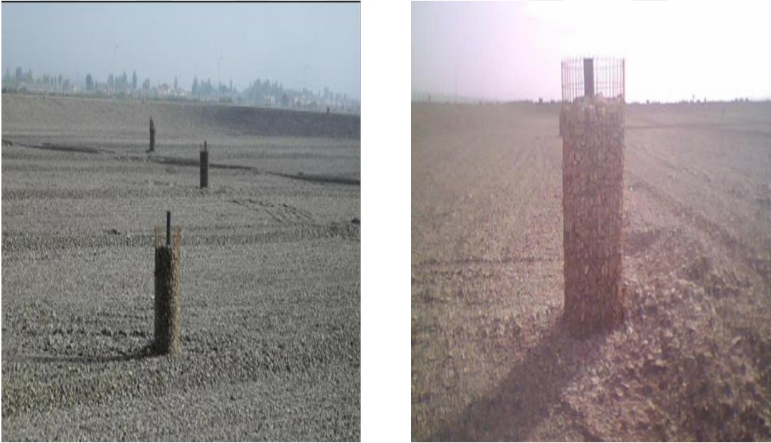
Şekil 5.32-5.33 Gaz tahliye borularının ıslah edilmiş sahadaki görünümü(MBB, 2016)
