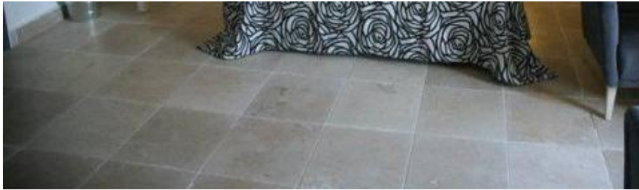
Şekil 6.6. Yatak odası zemin kaplaması, Anemos Hotel [62].
