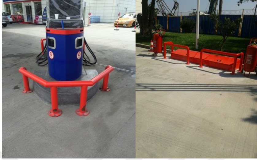
Resim 5.5. Moil Türen Petrol Pompa Yanı Ada Bariyeri , Çöp Kovası ve Yangın Teçhizat Koruma Bariyeri
