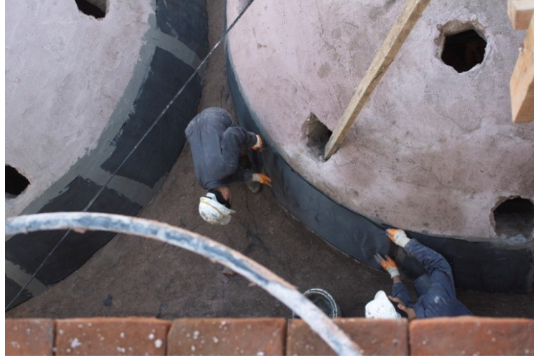
Şekil 4.2.5.1.59: Ilıklık kubbeleri karbon kumaş ile kuşaklama yapılarak sağlamlaştırması (Tevfik İlter Arşivi EK-2[12])
