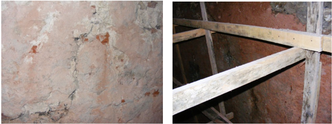
Şekil 4.2.5.1.83a - 4.2.5.1.83b: Sıcak su deposu iç duvar çatlağı ( Tevfik İlder Arşivi EK-2[12])
