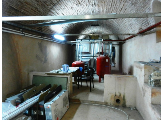
Şekil 4.1.5.4.24c: Yeni işlev için gerekli olan çağdaş ısıtma, soğutma ve aydınlatma ekipmanları (Deniz Alkan, Temmuz 2014)
