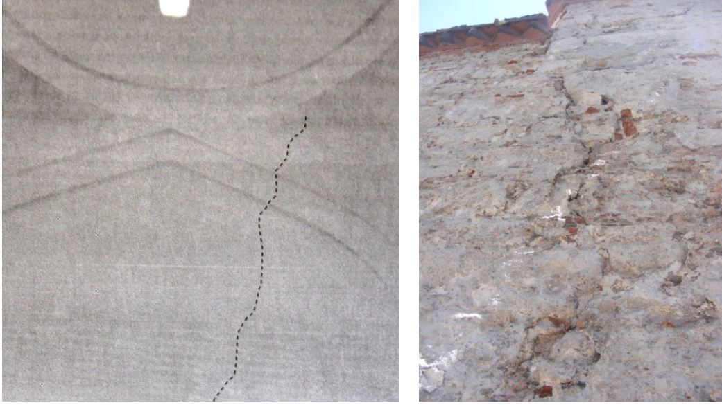
Şekil 4.2.5.1.41: Kuzeybatı duvarından başlayıp pandantife ulaşan çatlak (K.V.K.K.Arşivi, EK-2[1])
