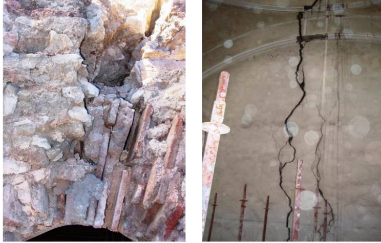
Şekil 4.1.5.1.19a – 4.1.5.1.19b: Doğu cephesi duvarındaki dıştan ve içten görülen çatlaklar (R. A. Arşivi)
