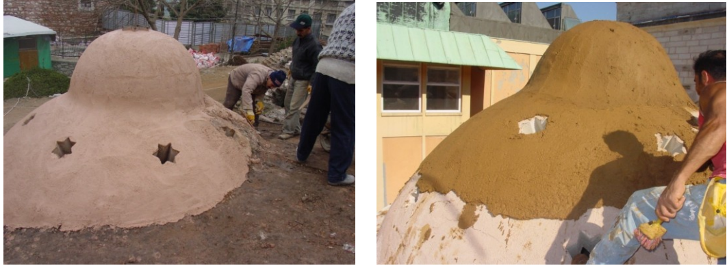
Şekil 4.1.5.3.36a - 4.1.5.3.36b: Kubbelerdeki kurşun kaplama altına yapılan harç ve üstüne yapılan çamur harç (R. A. Arşivi)
