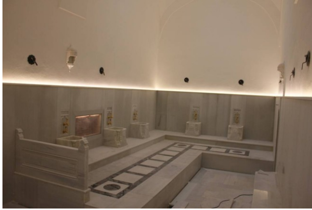
Şekil 4.2.5.3.9: Kadınlar ılıklik eyvan döşeme ve seki mermerlerinin yeniden yapımı (V.B.M. Arşivi EK-2[8])
