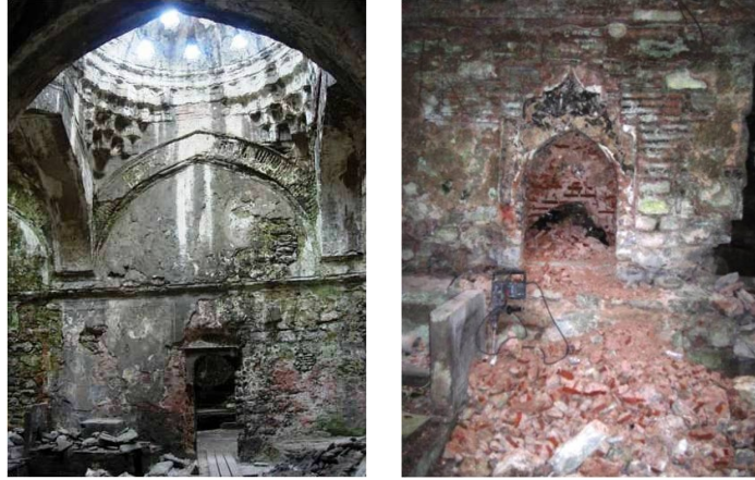
Şekil 4.1.5.1.28a – 4.1.5.1.28b: Restorasyon öncesi ılıklik duvarlarındaki hasarlar (K.V.K.K. Arşivi –EK-1 [13])
