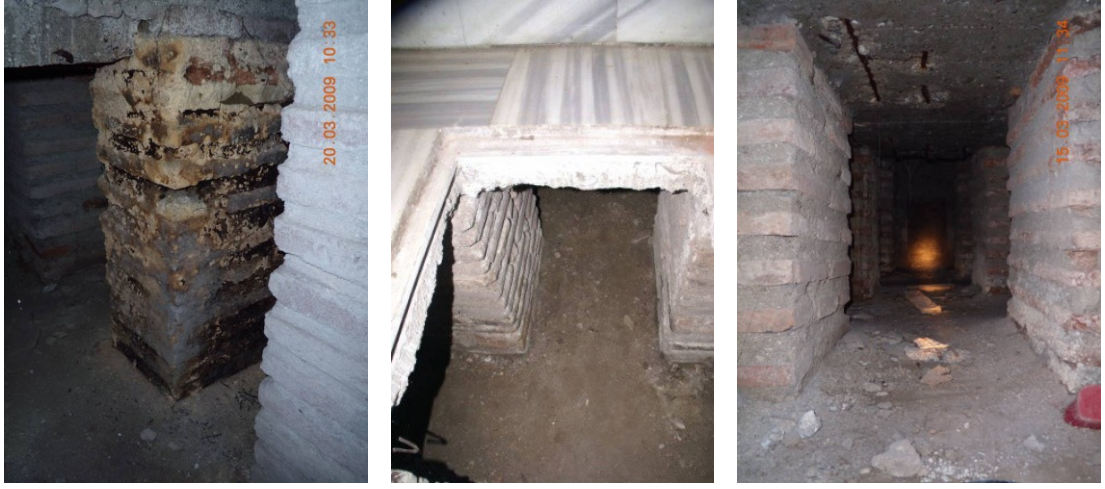
Şekil 4.2.5.1.3a - 4.2.5.1.3b - 4.2.5.1.3c: Cehennemlik ayakları (hipokast) üzerindeki betonarme döşemesi (V.B.M.Arşivi EK-2[9])
