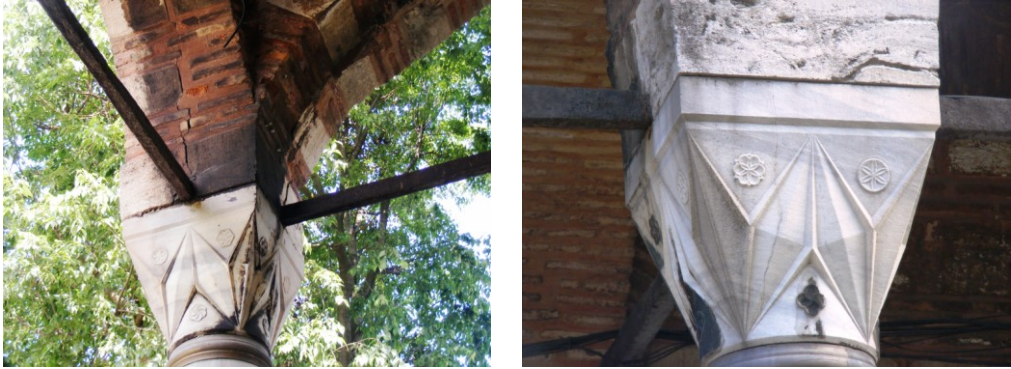
Şekil 4.2.5.1.6a - 4.2.5.1.6b: Revaklı girişin sütun başlıklarında oluşan çatlaklar(Tevfik İlter Arşivi EK-2[12])
