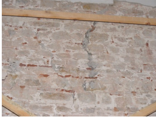
Şekil 4.2.5.1.38: Güneydoğu cephesi iç duvar çatlağı (Tevfik İter Arşivi EK-2[12])
