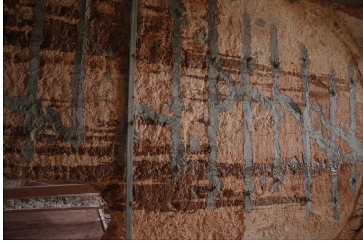
Şekil 4.2.5.1.26: Duvardaki çatlaklara tamir harcı ve enjeksiyon hortumları yardımı ile epoksi enjeksiyonu yapılması ( Tevfik İlter Arşivi EK-2[12])
