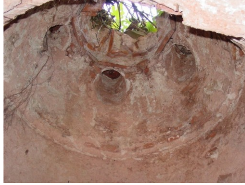
Şekil 4.1.5.2.20: Restorasyon çalışmalarından önce kubbelerdeki hasar ve deformasyonlar (R. A. Arşivi)
