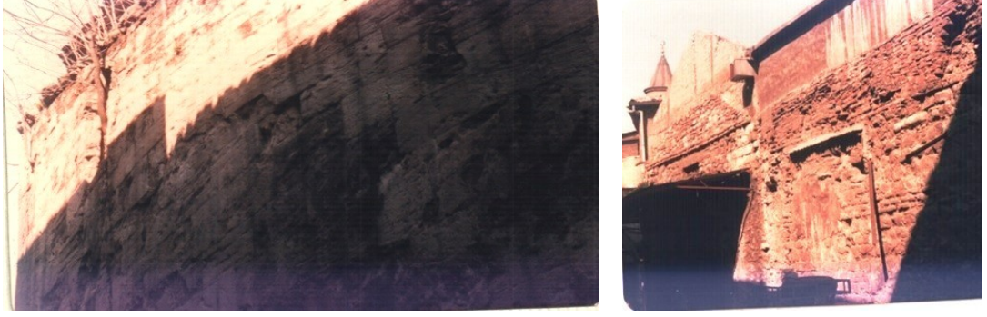
Şekil 4.3.5.2.9: Dış duvarlarda oluşan ağaçlar (K.V.K.K. Arşivi, EK-3[4])
