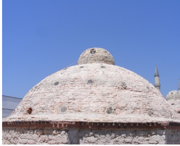
Şekil 4.2.5.1.61: Erkek sıcaklık orta kubbe hasarları (Tevfik İltter Arşivi EK-2[12])
