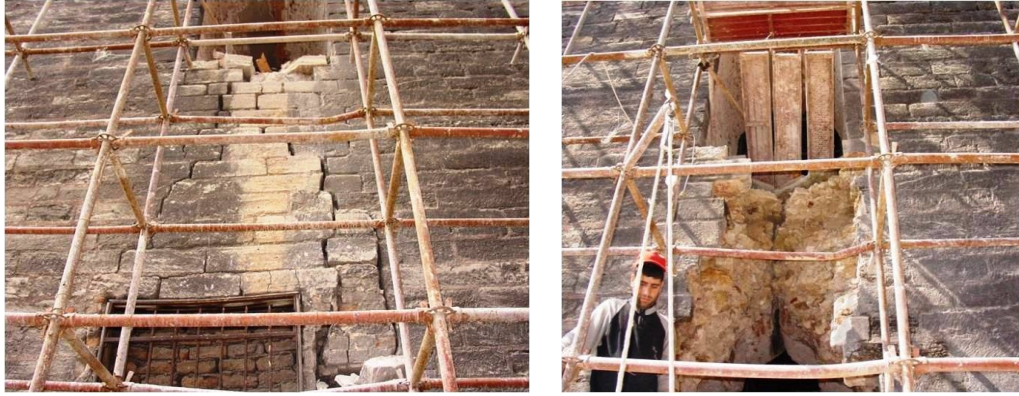
Şekil 4.1.5.1.18a – 4.1.5.1.18b: Doğu cephesi duvarındaki çatlaklar (R. A. Arşivi)
