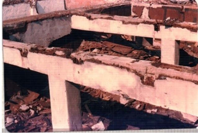
Şekil 4.3.5.2.6: Hamamın içine yapılan betonarme katların kolon ve kirişleri yıkılarak temizlenmesi (K.V.K.K. Arşivi, EK-3[4])
