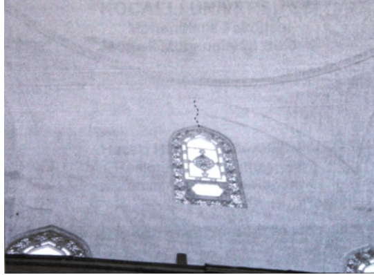
Şekil 4.2.5.1.39: Kuzeydoğu ve kuzeybatı duvarlarında pencere kemerlerinde oluşan çatlaklar (K.V.K.K. Arşivi, EK-2[1])
