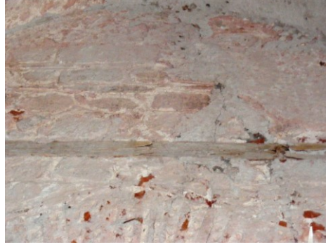
Şekil 4.2.5.1.9: Soğukluk beden duvarında iç yüzeye konan mevcutta kalan ahşap kuşak (Tevfik İlder Arşivi EK-2[12])
