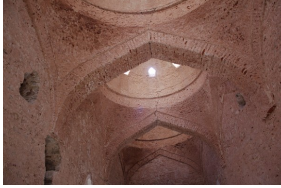
Şekil 4.2.5.1.29: İlklik kubbelerini taşıyan kemerlerde oluşan çatlaklar (Tevfik İter Arşivi EK-2[12])
