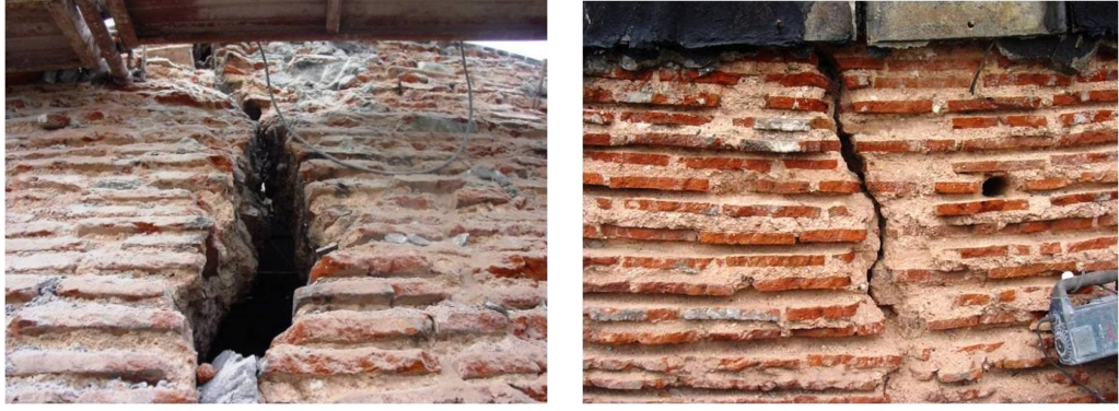
Şekil 4.1.5.1.37a – 4.1.5.1.37b: Kubbede oluşan çatlak ve hasarlar (R. A. Arşivi)
