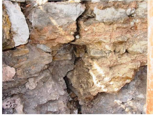
Şekil 4.1.5.1.29: Duvarda oluşan hasarlar ve çatlaklar (R. A. Arşivi)
