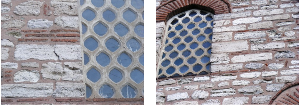
Şekil 4.2.5.1.37a - 4.2.5.1.37b: Kuzeybatı cephesi dış duvar çatlağı (Tevfik İter Arşivi EK-2[12])
