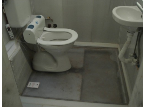
Şekil 4.2.5.4.6: Ilıklıktan geçilen tuvaletlere konan çağdaş klozetler (V.B.M.Arşivi EK-2[8])
