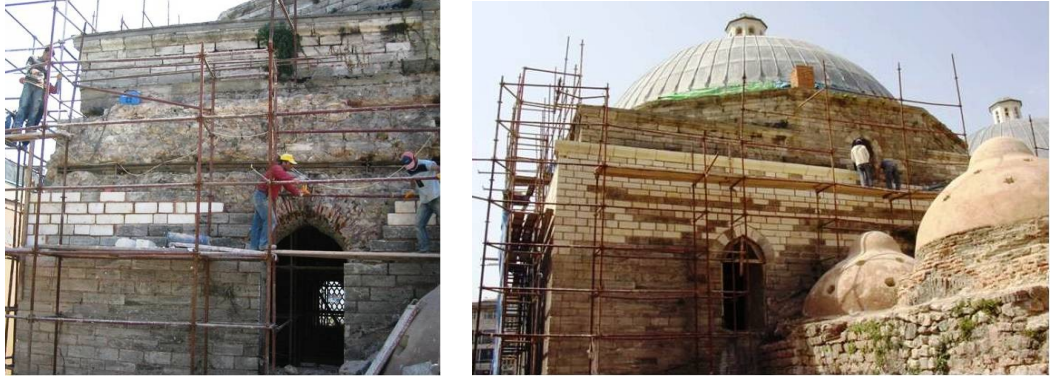
Şekil 4.1.5.3.12a - 4.1.5.3.12b: Kuzey cephesinde dış duvar cidarında kısmi olarak bütünleme yapılması (R. A. Arşivi)
