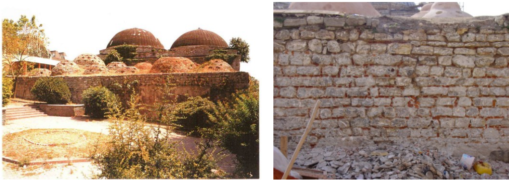
Şekil 4.1.5.2.11a - 4.1.5.2.11b: Su deposunun olduğu kuzey cephesindeki duvardaki sıva raspaları (R. A. Arşivi)
