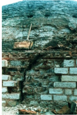
Şekil 4.3.5.1.1: Erkekler sıcaklık kubbesinin oturduğu duvarda oluşan çatlak (K.V.K.K. Arşivi, EK-3[4])
