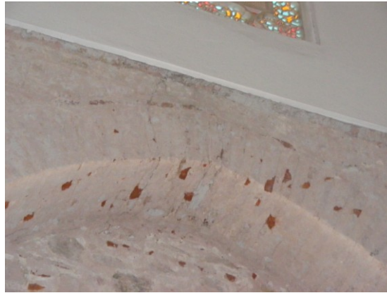
Şekil 4.2.5.1.18: Erkek soğukluk Kuzeybatı cephesi iç duvar kemer çatlağı
