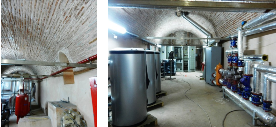
Şekil 4.1.5.4.24a - 4.1.5.4.24b: Yeni işlev için gerekli olan çağdaş ısıtma, soğutma ve aydınlatma ekipmanları (Deniz Alkan, Temmuz 2014)
