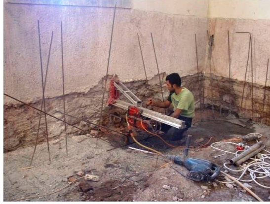
Şekil 4.1.5.1.26a – 4.1.5.1.26b: Zemin seviyesinde duvarda yapılan bağlantı çubukları için karot delgisi açılması (R. A. Arşivi)
