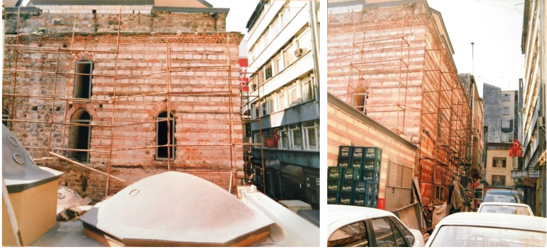
Şekil 4.4.5.3.1: Yıkılan muhdes eklerden sonra ortaya çıkan pencere açıklığı ve kemerlerin tuğla ile bütünleme yapılması (K.V.K.K. Arşivi, EK-4[1])
