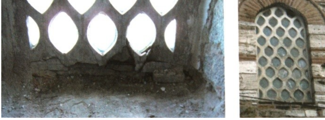
Şekil 4.2.5.2.52a - 4.2.5.2.52b: Dışlık pencerelerin yenilemeden önceki hasarlı durumu (K.V.K.K. Arşivi, EK-2[4])
