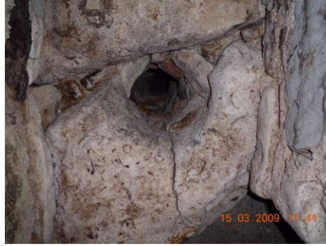
Şekil 4.2.5.3.1: Cehennemlikte bulunan hava bacası (V.B.M. Arşivi EK-2[8])
