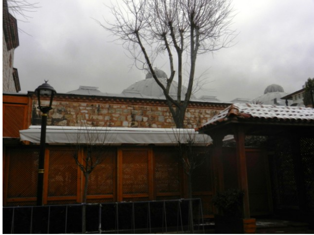
Őekil 4.2.5.3.60: G neydoĐu cephesi soĐuk su deposu duvarı  n ne yapılan hareketli bez  rt  (Deniz Alkan, Ocak 2015)
