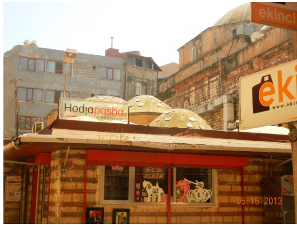
Şekil 4.4.5.4.4: Bütünleme yapılan sıcaklık duvarında sonradan açılan vitrin (Deniz Alkan, Mart 2015)
