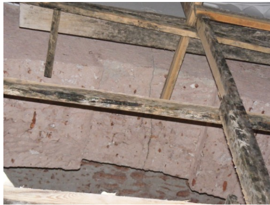
Şekil 4.2.5.1.33: Sıcaklık eyvanlarının Bursa kemerlerinde oluşan çatlaklar (Tevfik İlder Arşivi EK-2[12])
