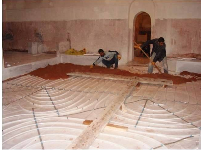
Şekil 4.1.5.4.2: Yerden ısıtma için yapılan tesisat (R. A. Arşivi)
