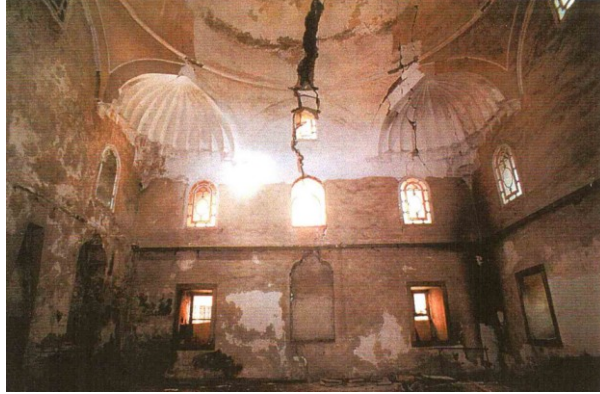
Şekil 4.1.5.1.50: Kubbe ve duvarlarda oluşan çatlakların sağlamlaştırma öncesi durumu (R. A. Arşivi)
