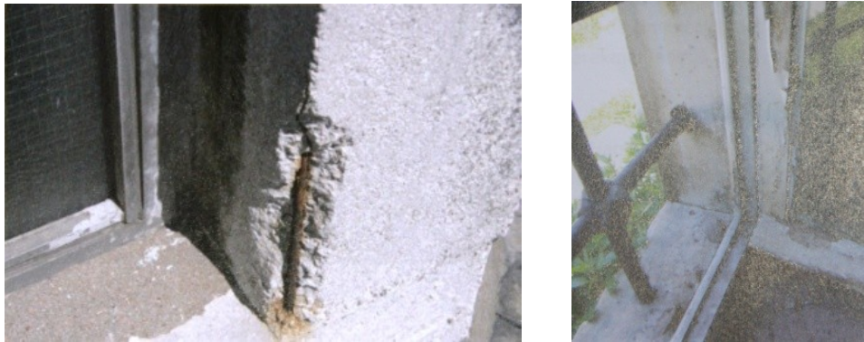
Şekil 4.2.5.2.56a - 4.2.5.2.56b: Pencere doğramalarının hasarlı durumları (K.V.K.K. Arşivi, EK-2[4])
