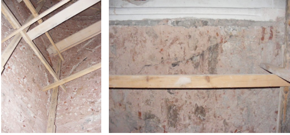
Şekil 4.2.5.1.24a - 4.2.5.1.24b: Güneydoğu cephesi iç duvar çatlağı ( Tevfik İlater Arşivi EK-2[12])
