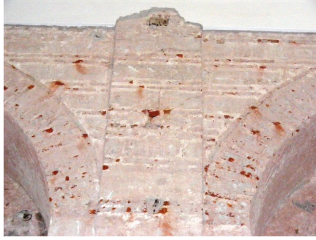
Şekil 4.2.5.1.19: Erkek soğukluk Güneybatı cephesi iç kemer çatlağı (Tevfik İlter Arşivi EK-2[12])
