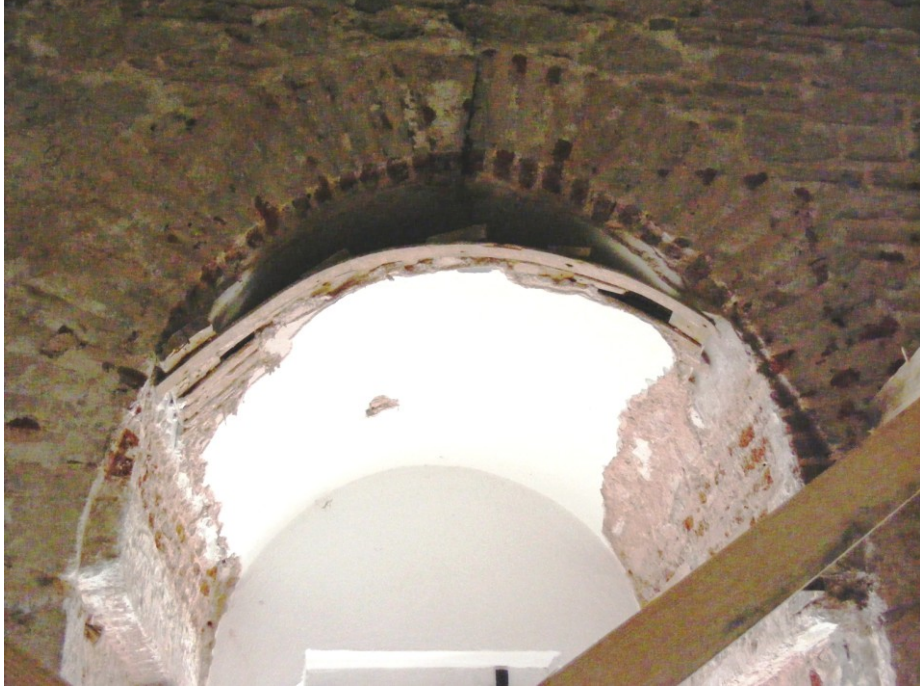
Şekil 4.2.5.1.45: Sıcaklık kemerlerindeki çatlaklar (Tevfik İlter Arşivi EK-2[12])
