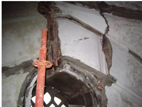
Şekil 4.1.5.1.20a – 4.1.5.1.20b: Soyunmalık duvarlarında oluşan çatlak ve hasarlar (R. A. Arşivi)
