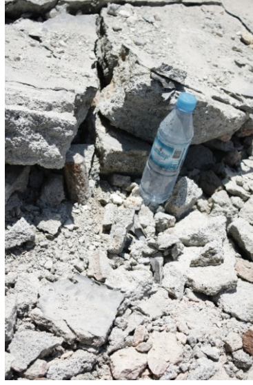
Şekil 4.2.5.2.43: Raspa yapılarak yapıdan uzaklaştırılmış olan sıcak su deposunun üstündeki çimentolu harçların çökme sonucu parçalanması(Tevfik İlder Arşivi EK-2[12])
