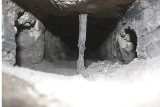
Şekil 4.2.5.1.12: Çürüyüp yok olan ahşap kuşak ve kayıtların kestiği noktada kalan demir mih(Tevfik İlder Arşivi EK-2[12])
