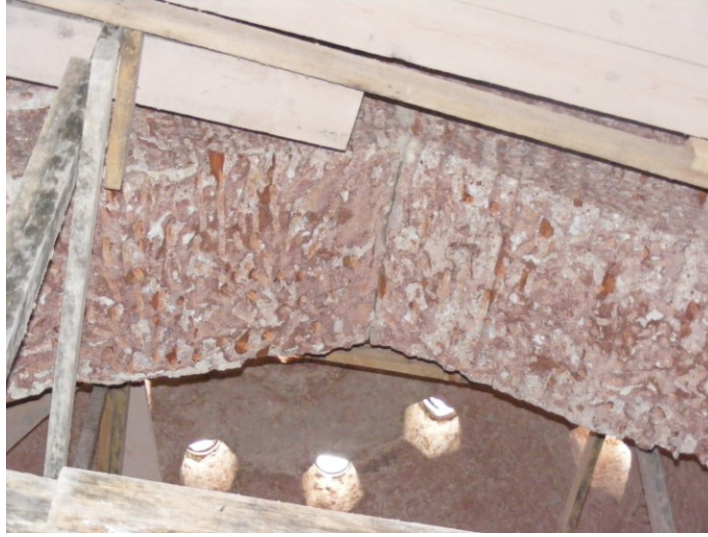
Şekil 4.2.5.1.27: ılıkılık kubbeler arasındaki kemer çatlağı (Tevfik İlter Arşivi EK-2[12])
