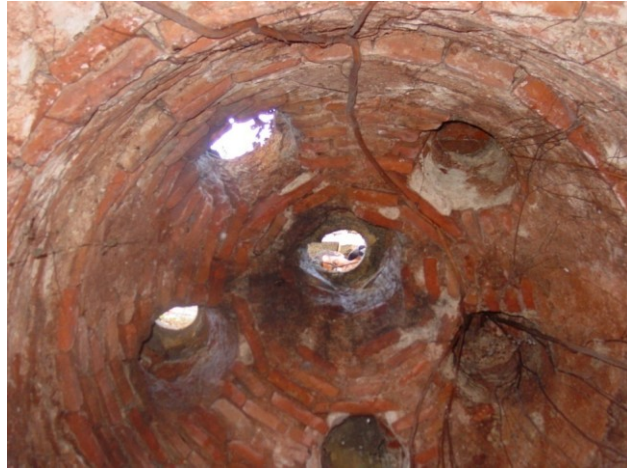
Şekil 4.1.5.2.23: Restorasyon çalışmalarından önce kubbelerdeki hasar ve deformasyonlar (R. A. Arşivi)
