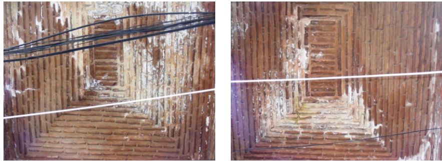
Şekil 4.2.5.1.48a - 4.2.5.1.48b : Revakların tonozlarında oluşan hasarlar(Tevfik İlter Arşivi EK-2[12])
