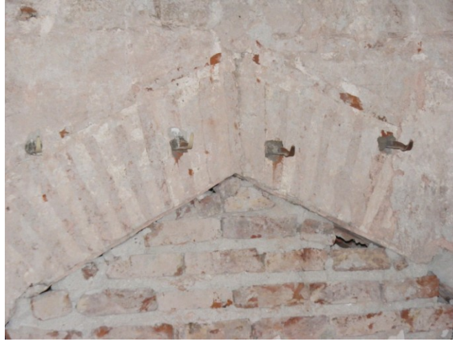
Şekil 4.2.5.1.16: Kuzeydoğu cephesine bakan iç duvar kemer çatlağı ve depremler sonrası güçlendirme için çakılan mihlar ( Tevfik İltar Arşivi EK-2[12]).
