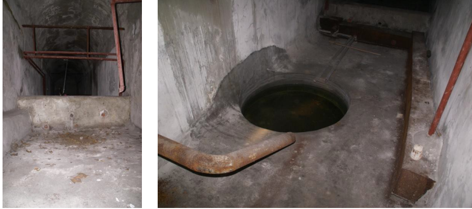
Şekil 4.2.5.2.40: Sıcak su deposunda bulunan kazan
