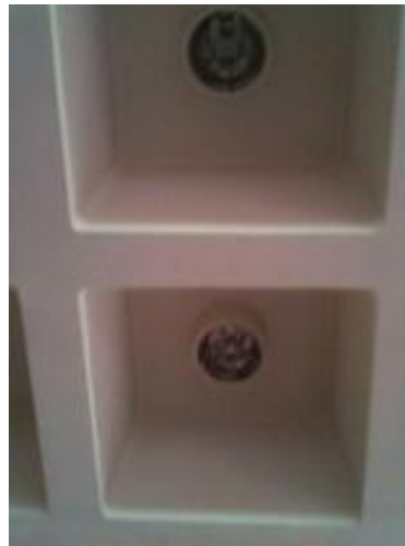
Şekil 3.8.7. Yedpa Cami Alt Kat İbadet Mekanı Aydınlatma [55]
