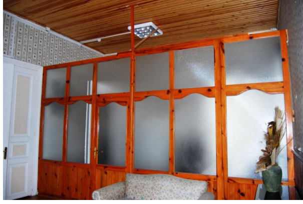
Ek 30. Reşit Paşa Konağı-Dinlenme mekanı ahşap doğramalı camekan [48]
