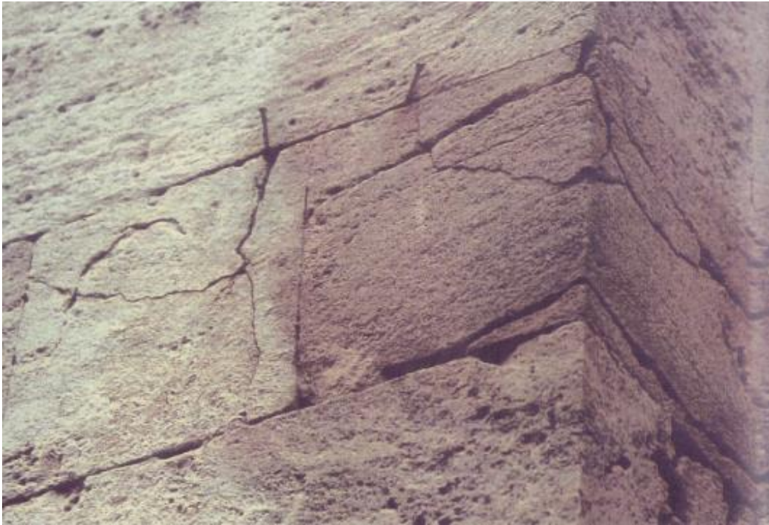
Şekil 5.40 Taş yüzeylerde oluşan çatlakların görünümü (Yılmaz Yapı, 2008)
