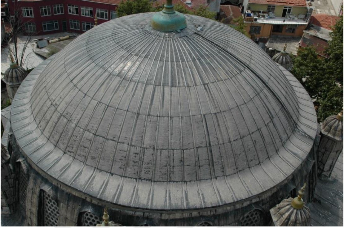
Şekil 6.92 Ana kubbe üst örtü kurşun kaplaması restorasyon öncesi (Vakıflar Arşivi) ve sonrası (An-sa Abide)
