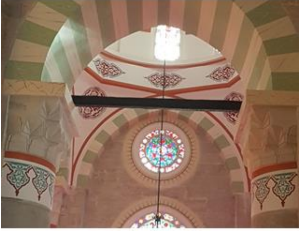
Şekil 4.33 Fil ayaklarındaki kalemişi (Kasım, 2017)
