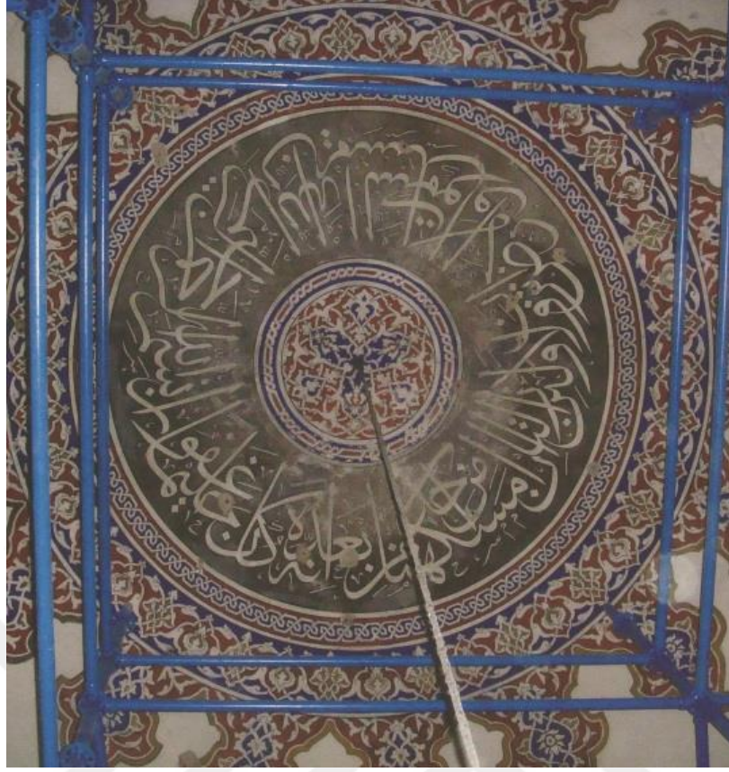
Şekil 5.39 Cami ana kubbede kalem işi bozulmaları (Yılmaz Yapı, 2008)
