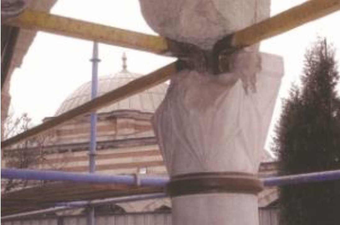
Şekil 5.43 Medresenin taşıyıcı sütunlarında oluşan bozulmaları (Yılmaz Yapı, 2009)
