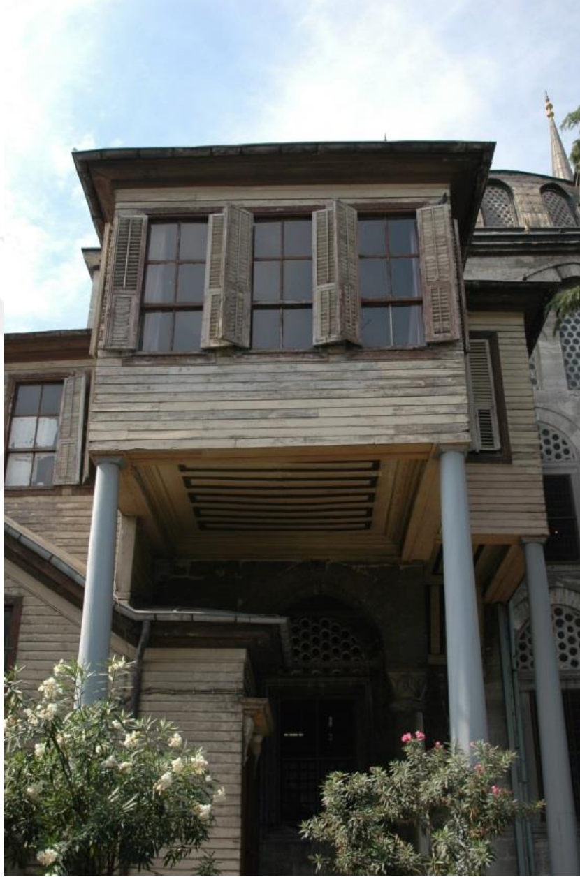
Şekil 6.73 Hünkar Köşkü ön cephe bozulmalarının görünümü (Vakıflar Arşivi)
