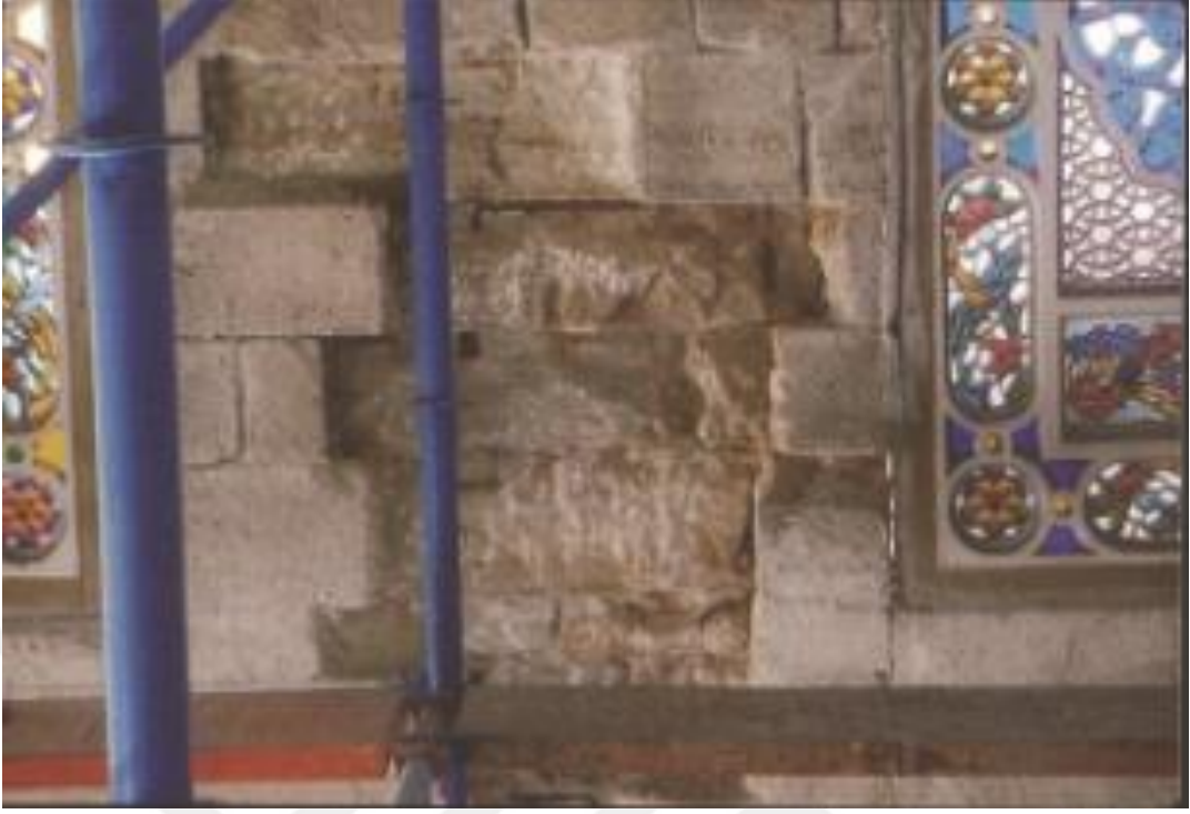
Şekil 5.41 Cephe duvarlarında oluşan taş boşalmalarının ve onarımlarının görüntüsü (Yılmaz Yapı, 2008-2010)
