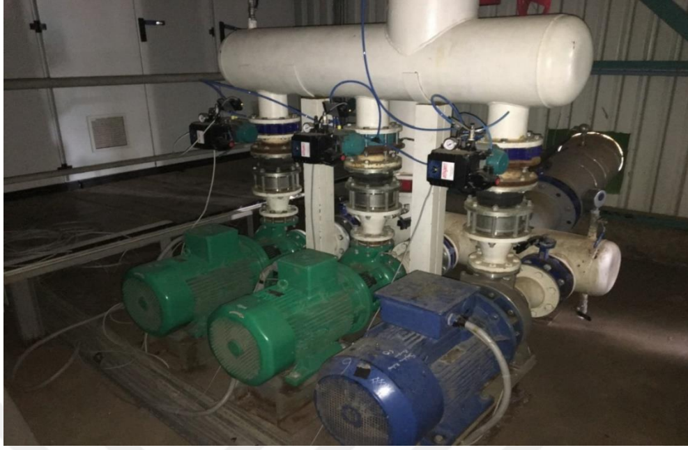
Şekil 4.4. Yeni Pompa Grubu
