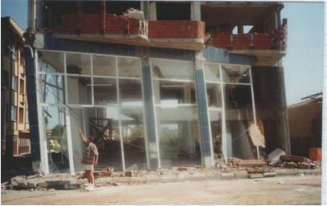
Şekil 7. Zayıf Kat Hasarından Dolayı Zarar Görmüş Yapı [25]
