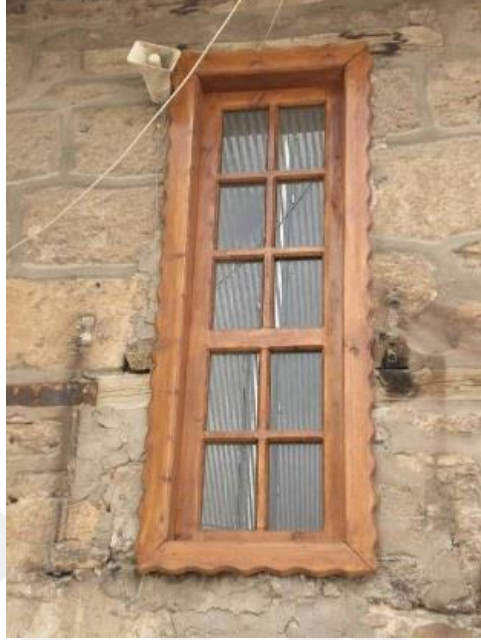
Şekil 4. 54: Batı Cephesinde Bulunan, Özgün Durumu Mahfil Giriş Kapısı Olan Açıklığın, Ahşap Doğrama ile Kapatılması (Korar, 2007).
