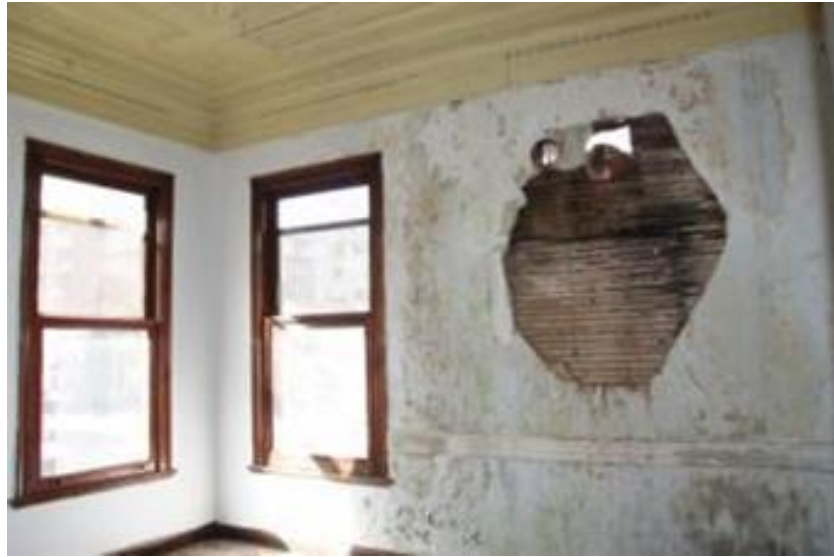
Şekil 5. 46: Dış Cephedeki Bacanın Yıkılması Nedeni ile Duvarın Su Alması Sonucu Oluşan Bozulma (Sarızeybek, 2017).
