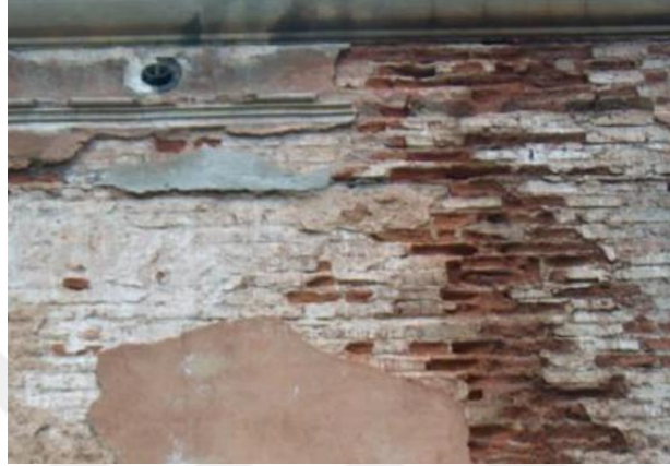
Şekil 3. 22: “Nemin ve donmanın etkisiyle dökülmenin ve parça kopmasının oluşması” (Arun, 2016).
