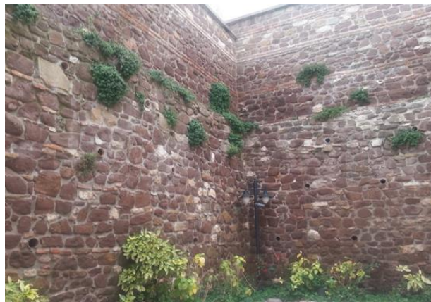
Şekil 3. 23: Taş duvarda bitki yetişmesi /Sırrı Paşa Konağı Avlu Duvarları/İzmit (Sarızeybek, 2018).
