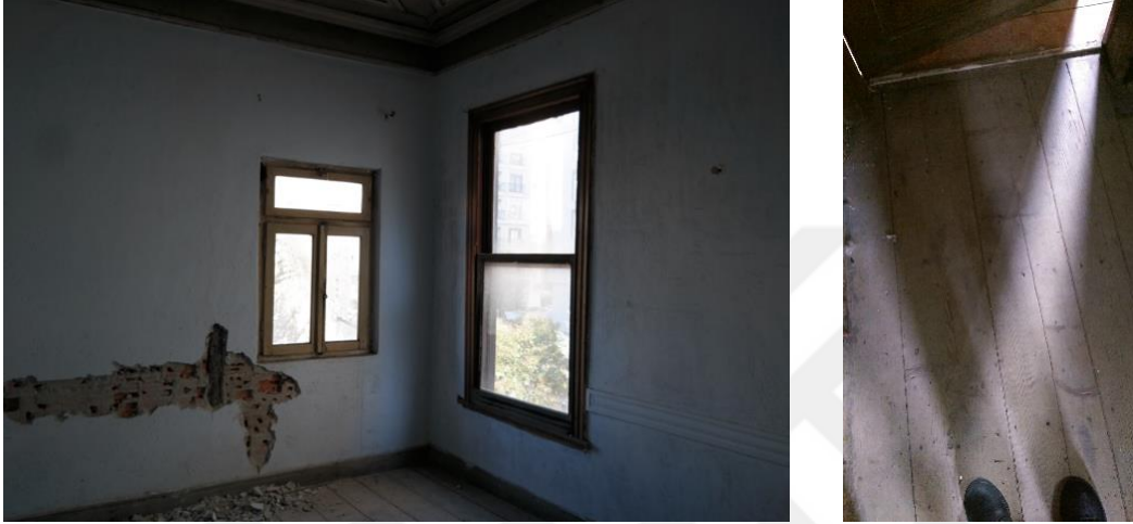
Şekil 5. 37: 1 06 Oda Niteliksiz Duvar ve Pencere (Sarızeybek, 2017). Şekil 5.38: Ahşap Zemin Kaplaması (Sarızeybek, 2017).
