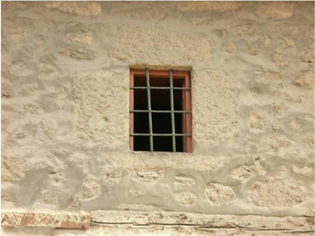
Şekil 4. 32: Ahşap Hatılda Çatlama (Korar, 2007).
