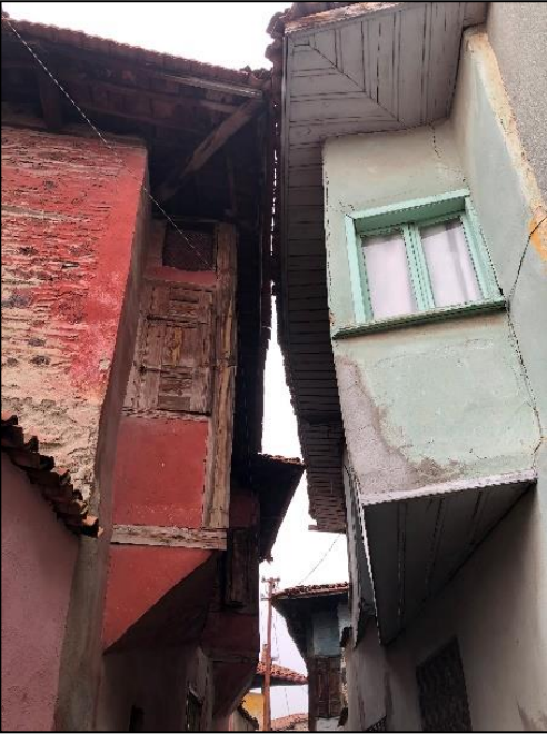
Şekil 3. 61. Saçak altının ahşap malzeme ile kapatılmadığı (solda) ve kapatıldığı (sağda) örnek (Dizman, 2019)
