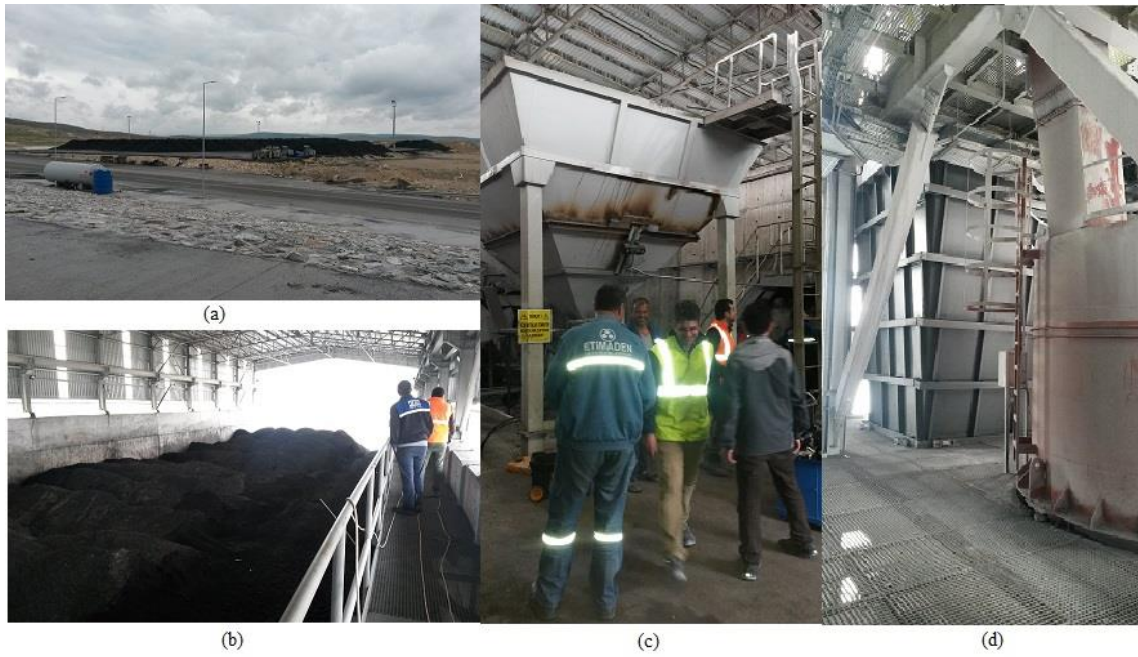
Şekil 5.4. Kömürün hazırlanış aşamaları (a) açık kömür depo sahası (b) kapalı kömür depo sahası (c) kömür hazırlama (d) bunker.
