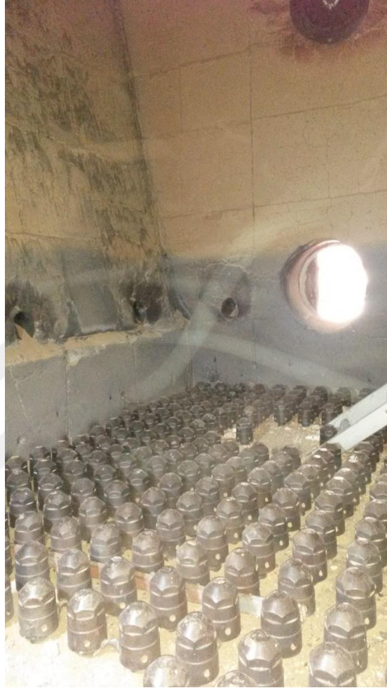
Şekil 3.6. Yatak bölgesindeki akışkanlaştırma nozulları.
