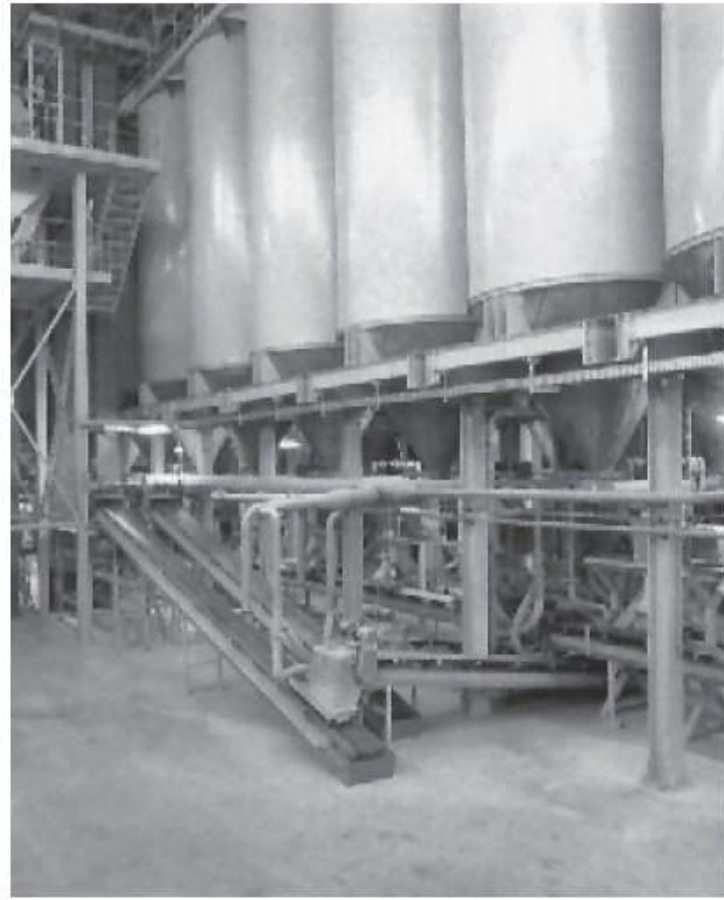
Şekil 4.12. Granül depolama siloları (Özkan, 2002/2008).
