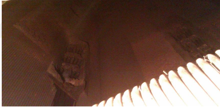
Şekil 5.6. Kazanın ekran duvarlarında meydana gelen cüruf.
