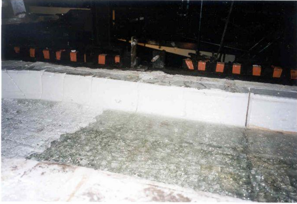
Şekil 12.2. Alfa beta yüksek alumina kullanılmış bir fırının kanal taşlarının kampanya ömrü sonrası görünümü, tekrar kullanılabilir durumda olduğu görülüyor.
