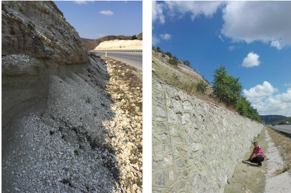
Şekil 4.11. Çalışma alanı içerisinde bulunan karayolu drenaj hendeklerinin kil içeren kayaların dağılması sonucu meydana gelen moloz malzemeleriyle dolmasına ilişkin örnekler (Kütahya Eskişehir yolu, Ilıca mevki).
