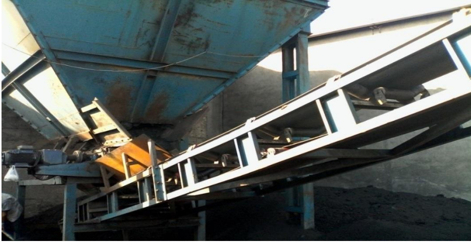
Şekil 5.14. Tesis içi kömür nakliye bantları.
