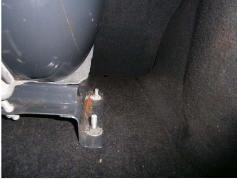
Şekil 4.38. Cıvatalarla zemine montajı uygun bir şekilde yapılmış silindirik tank örneği.
