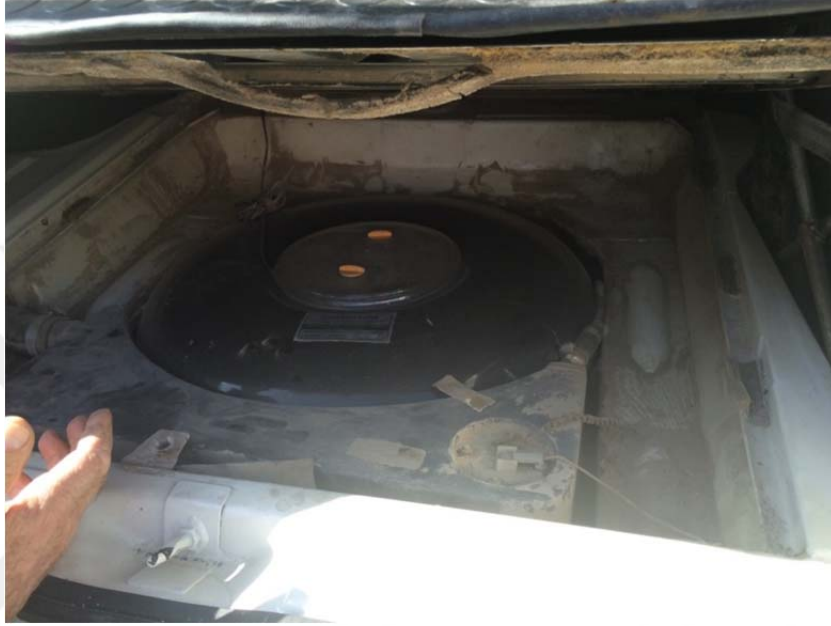
Şekil 4.43. Benzin deposu ile tank arası mesafenin yetersiz olduğu tank montajı örneği.
