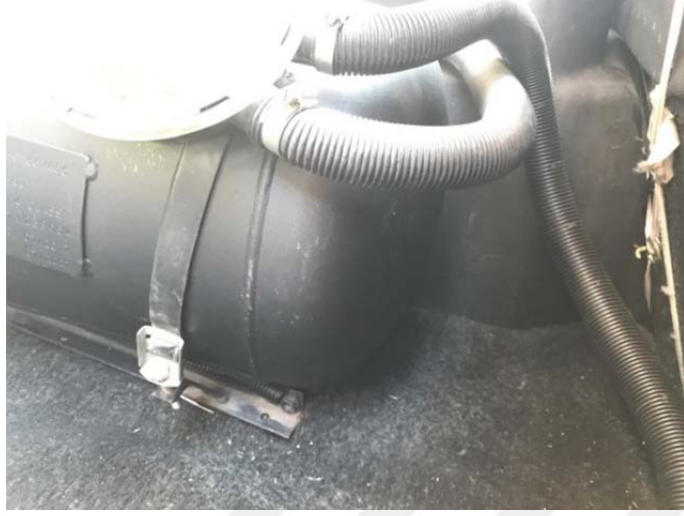
Şekil 4.51. Tank koruma saçı ve üçüncü kuşak geçirilmemiş, uygunsuz montaj örneği.
