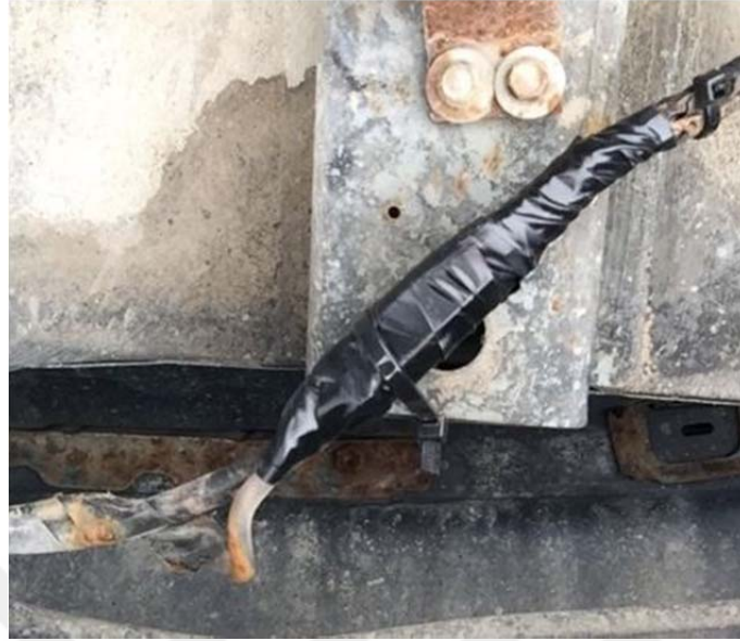
Şekil 4.108. LPG bakır borularının dışı sargısız olmalıdır, uygunsuz montaj örneği.
