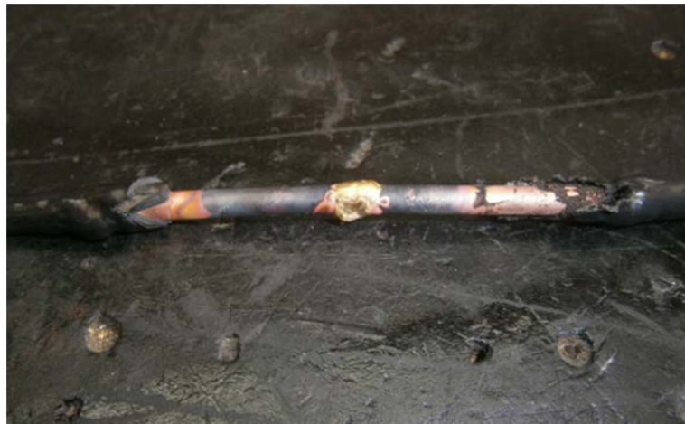
Şekil 4.107. Tahrip olmuş uygunsuz LPG bakır boru örneği (MMO, 2017).
