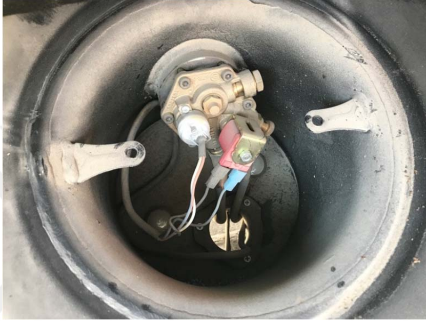
Şekil 4.85. Simit tanka açılmış uygun havalandırma montajı örneği.
