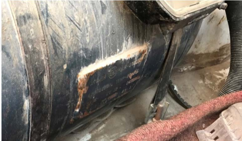
Şekil 4.23. Yüzey korozyonu sebebiyle etiket bilgileri okunamayan tank örneği.
