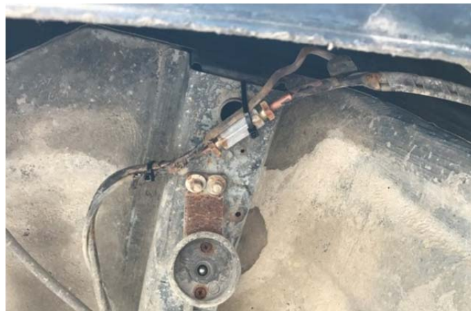
Şekil 4.109. LPG bakır boruları eksiz olmalıdır, uygunsuz montaj örneği.
