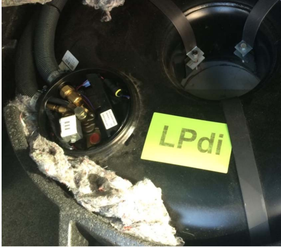
Şekil 4.8. Simit tank üzeri pompa bağlantısı örneği.
