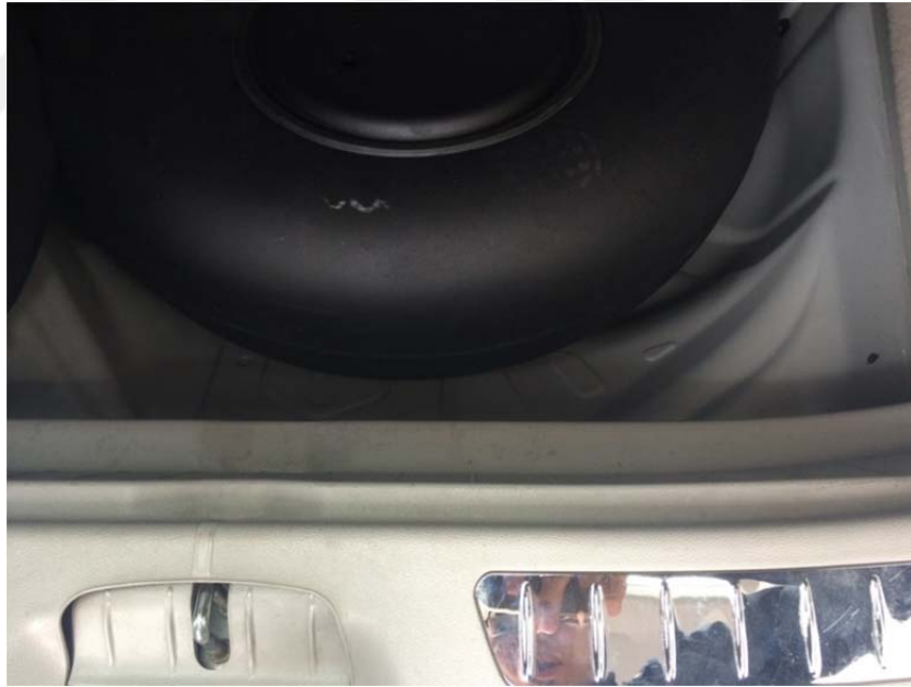
Şekil 4.42. Metalle teması kesilmemiş uygunsuz simit tank montajı örneği.
