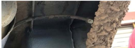
Şekil 4.101. PVC kaplaması soyulmuş uygunsuz LPG bakır boru örneği.
