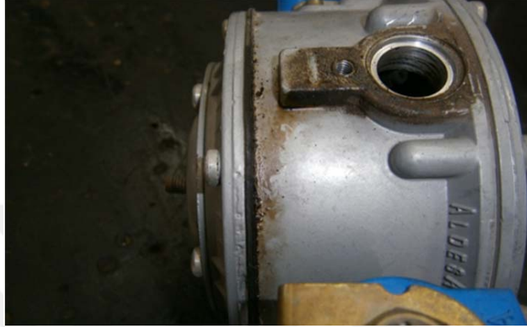
Şekil 4.119. Yağ sızıntısı mevcut, uygunsuz regülatör örneği (MMO, 2017).
