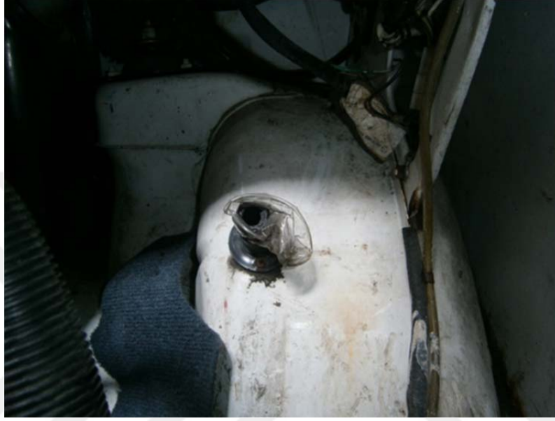
Şekil 4.83. Tekerlek boşluğundaki uygunsuz havalandırma bacası örneği (MMO, 2017).
