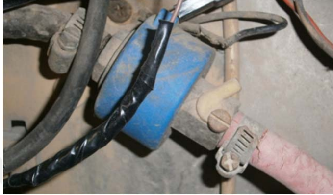
Şekil 4.115. Benzin hortumu çatlamış uygunsuz montaj örneği (MMO, 2017).
