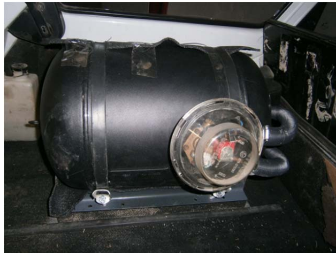
Şekil 4.31. Multivalf montaj açısı 30° den küçük olan uygunsuz tank montajı örneği.
