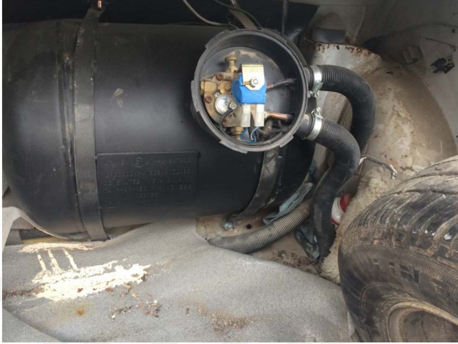
Şekil 4.34. Sehpasız ve düz zemine monte edilmemiş, uygunsuz tank montajı örneği.
