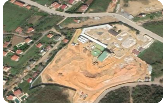
Şekil 3.2. Cevher zenginleştirme fabrikası.
