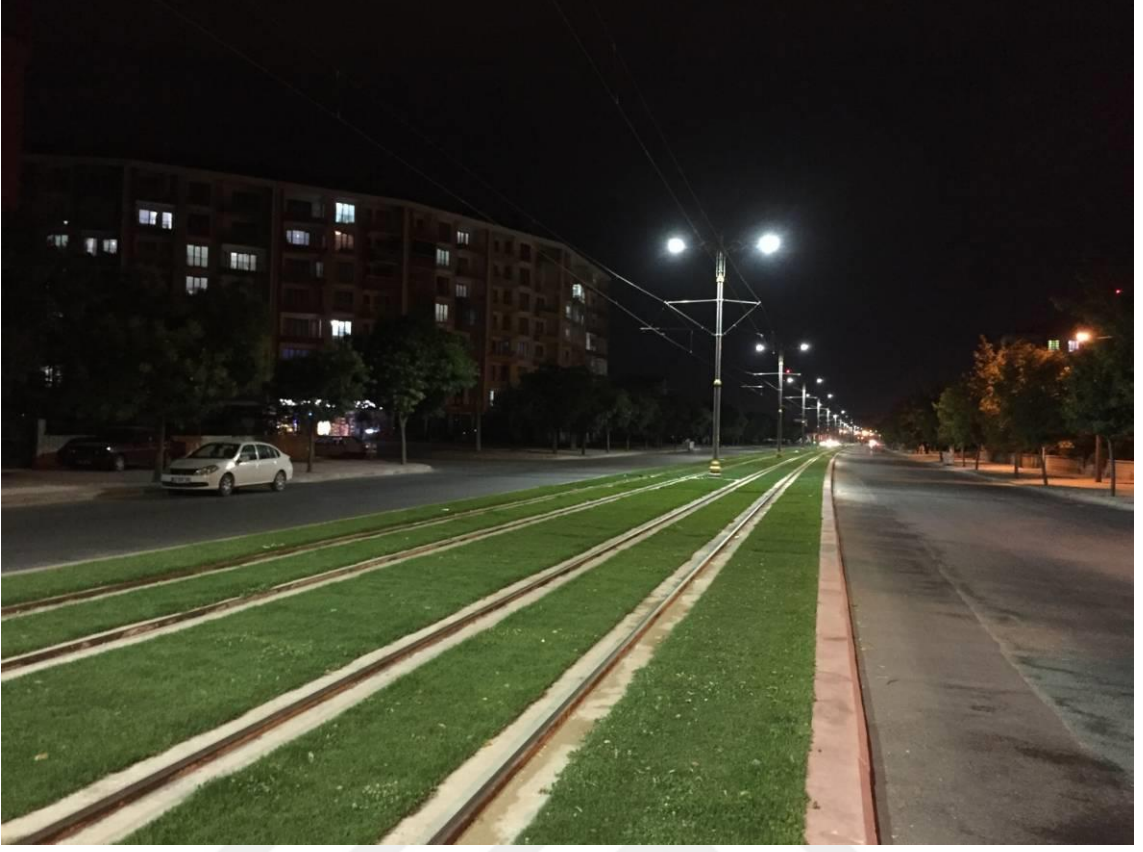
Şekil 5.28: Tramvay Yolu Aydınlatması Gece Görünüşü
