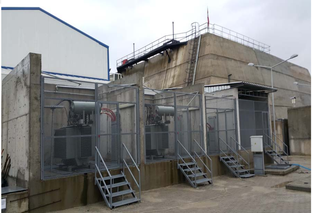
Şekil 1.5. Yuvacık HES'teki Elektrik İletim Panoları ve Trafolar [13]
