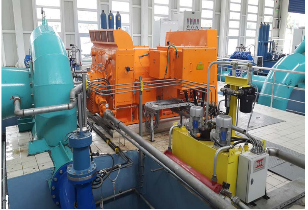
Şekil 1.7. Yuvacık HES'teki Asenkron Jeneratörler [13]
