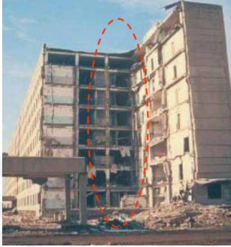
Şekil 3. 11. Derzi Olmayan Yapı Geometrisi Bozuk Yapı Hasarı [15]
