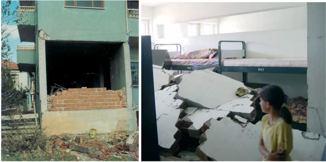
Şekil 1.1. Betonarme çerçeve içerisinde bulunan dolgu duvarın depremden dolayı düzlem dışı davranışı(a:1995 Dinar Depremi; b: 2003 Bingöl Depremi) [5]
