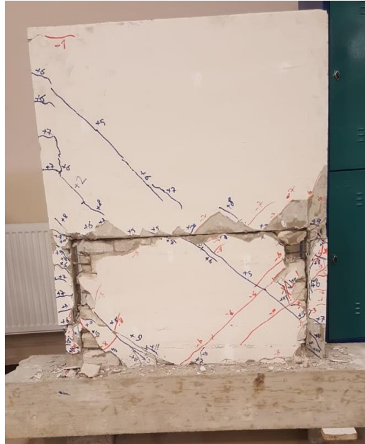
Şekil 4.22. Deney numunesi 3’de oluşan çatlakların ve hasarların, ön ve arka yüzden şematik olarak gösterimi
