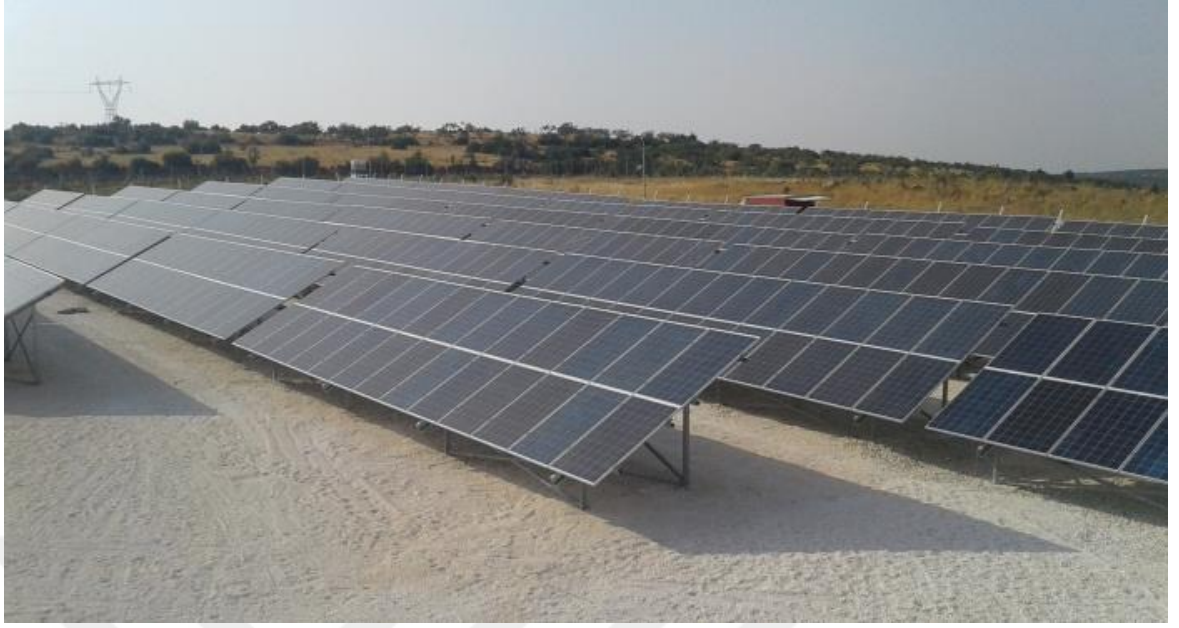
Resim 2.1 GASKİ güneş enerji santralinin yandan görünümü
