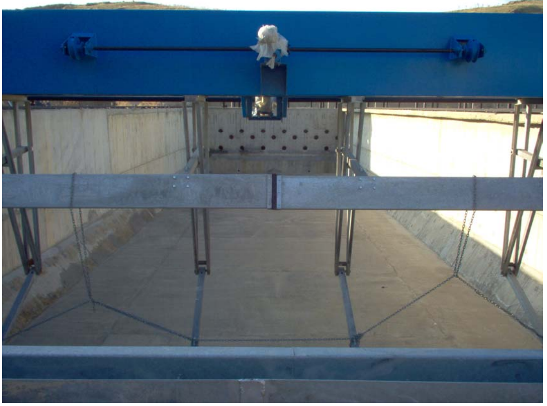
Şekil 2.4 Denizli (Merkez) Atıksu Arıtma Tesisi ön çökeltme havuzları doğrusal sıyırıcılar
