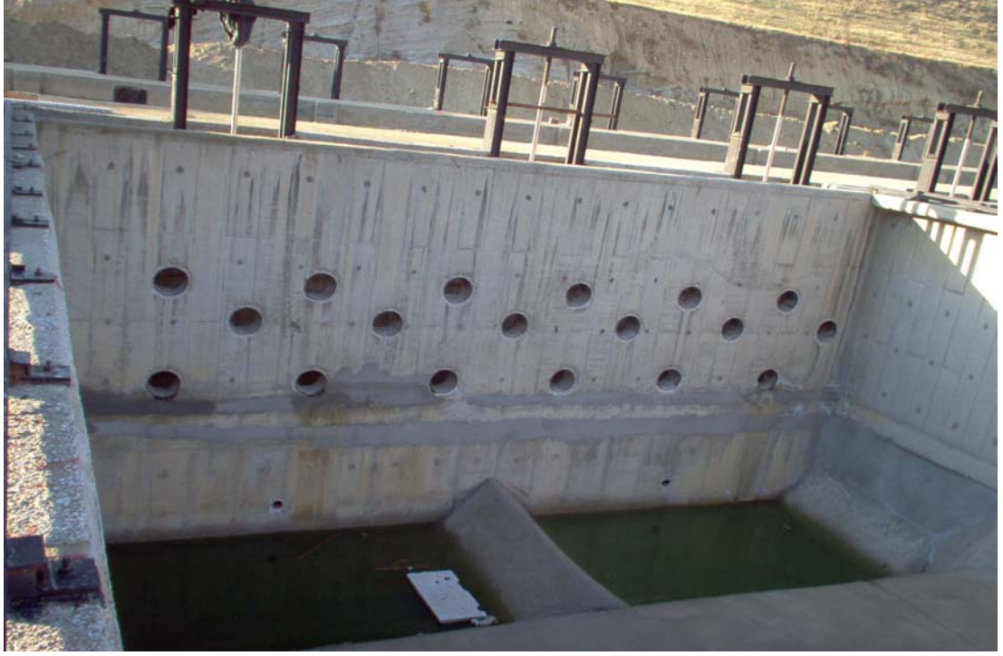
Şekil 2.9 Denizli (merkez) Atıksu Arıtma Tesisi ön çökeltme havuz giriş tertibatı
