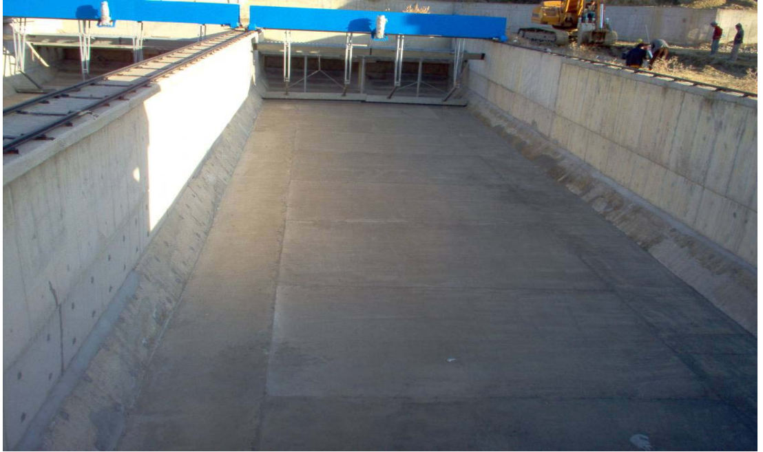
Şekil 2.3 Denizli (Merkez) Atıksu Arıtma Tesisi ön çökteltme havuzları doğrusal sıyrıcılar
