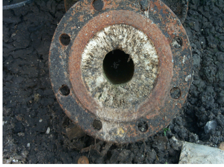
Şekil 3.1 : Struvit Oluşumu ile Kesit Daralması
