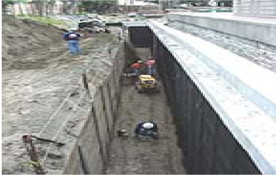
Şekil 3.8: Los Angeles belediye binası temel güçlendirmesi için oluşturulan istinat duvarı ve bırakılan sismik boşluk ([28]’den alınmıştır.)
