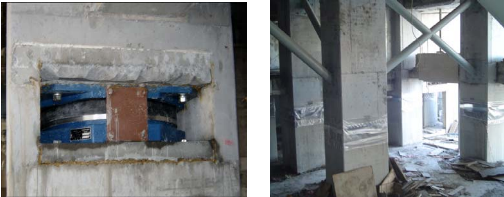
Şekil 7.17: Kolonlara yerleştirilen sürtümlü sarkaç tip izolatör ve kolonların diyagonaller ile desteklenmesi (özel çekim)
