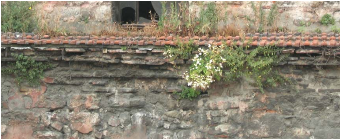
Şekil C.5-123: Güneybatı kornişi; bozuk örgü ve bitkilenme
