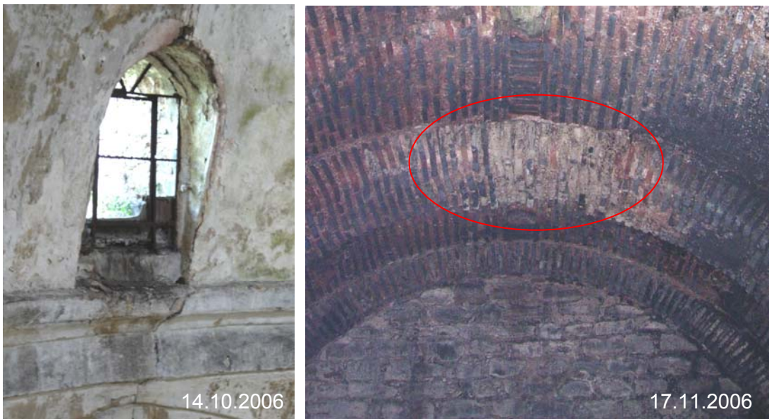
Şekil C.7-40: Silmedeki çatlak Şekil C.7-41: Kùlhan; destek kemerinde onarım izi
