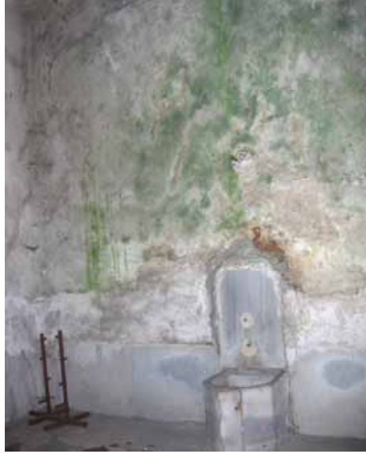
Şekil C.3-226: Z05-3; güneydoğu duvarındaki bozulmalar
