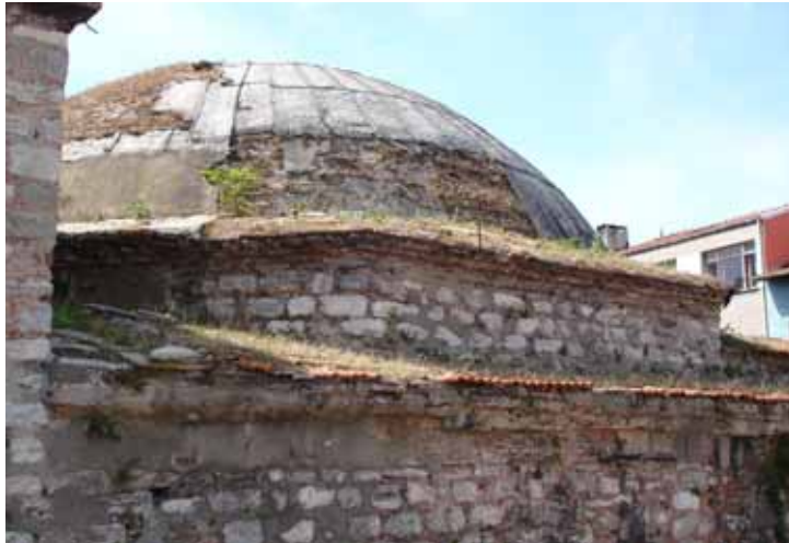
Şekil C.2-33: Kadınlar Bölümü; soyunmalık kubbesi, eksik kurşun örtü
