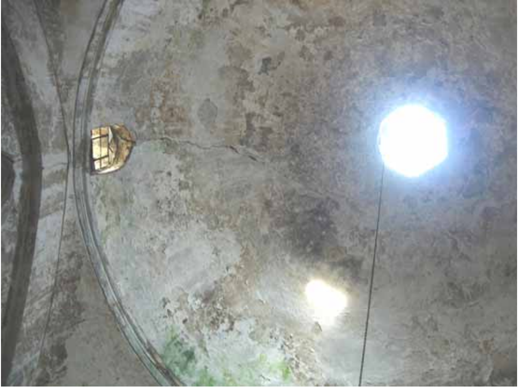
Şekil C.3-44: Kubbenin kuzeybatısındaki yapısal çatlak [Aralık 2006]
