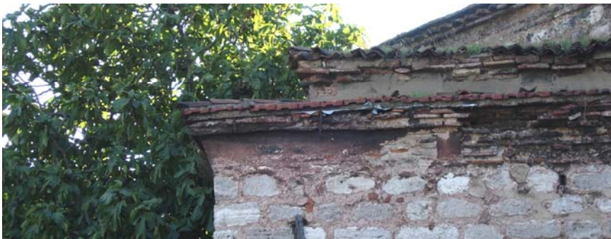
Şekil C.5-114: Kuzeydoğu kornişi- bozuk örgü
