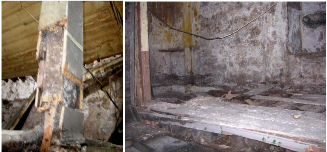
Şekil C.7-37: Ahşap elemanlarda gözlenen çürüme (01.11.2006)
