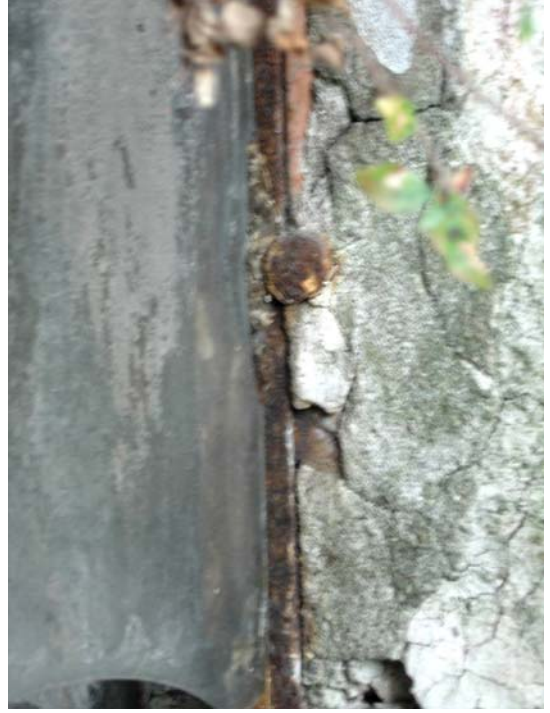
Şekil C.6-15: Güneydoğu penceresi; tesbit çivisi
