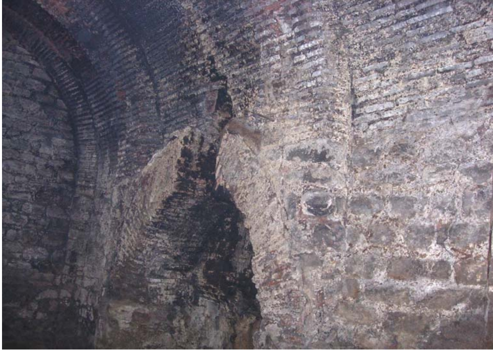
Şekil C.7-38: Külhanın duvarlarındaki bozulmalar (18.11.2006)
