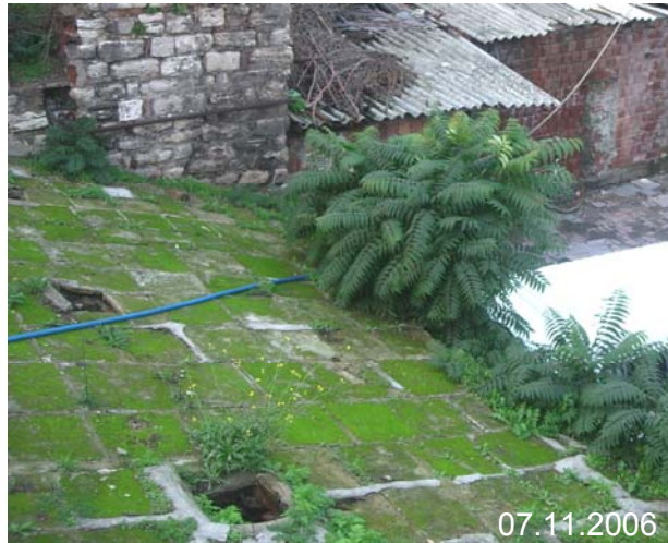
Şekil C.7-23: Külhanın taş örtüsündeki yosunlanma
