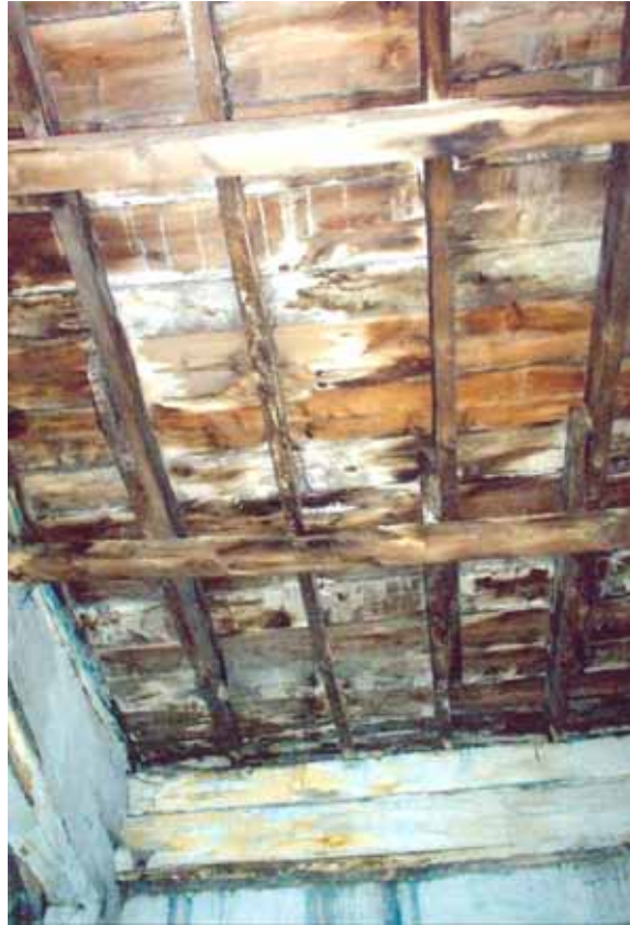
Şekil C.3-7: Z01; koruyuculuğunu yitirmiş ahşap çatı
