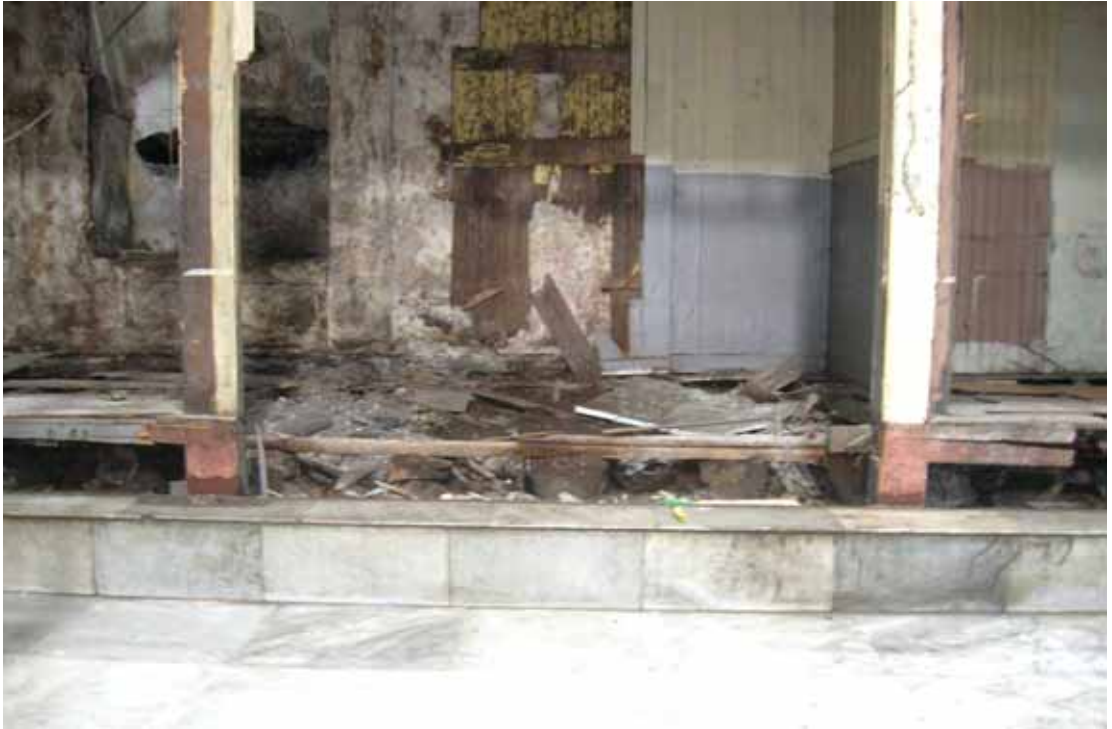
Şekil C.3-46: Z02e; ahşap döşemenin durumu
