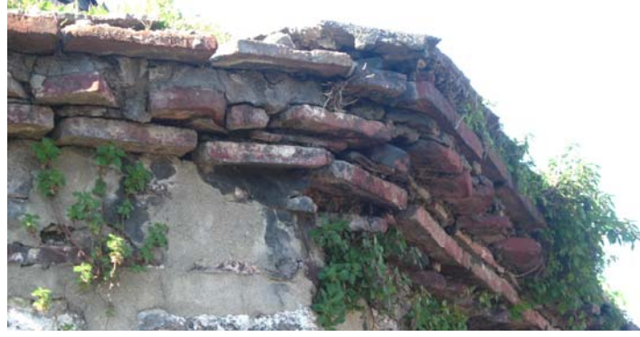
Şekil C.5-159: Kasnak doęu duvarı- kuzey köşe (bozuk örgü)
