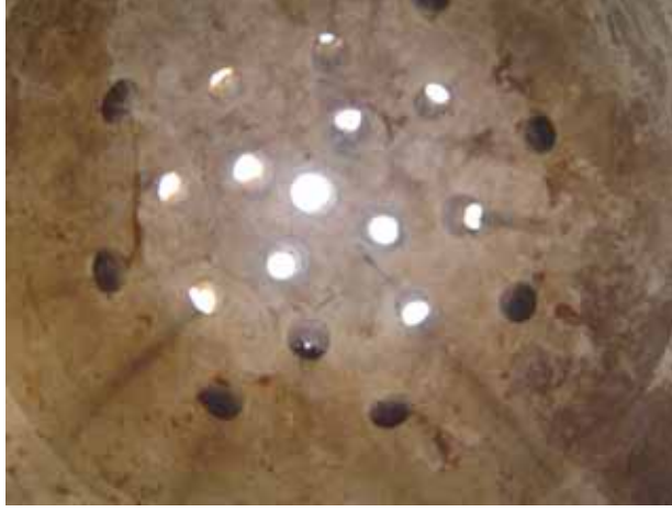
Şekil C.2-31: Kadınlar Bölümü; kubbede görülen bozulma
