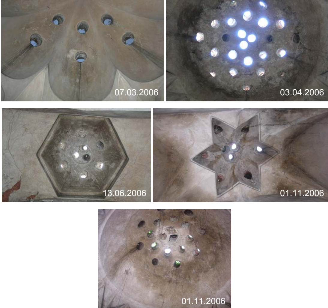
Şekil C.7-31: Kubbelerde nemden kaynaklanan renk değişimleri
