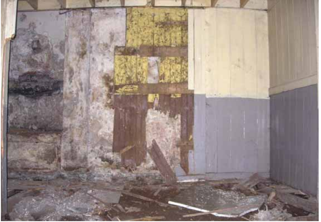
Şekil C.3-47: Z02e; ahşap duvar kaplamasının durumu
