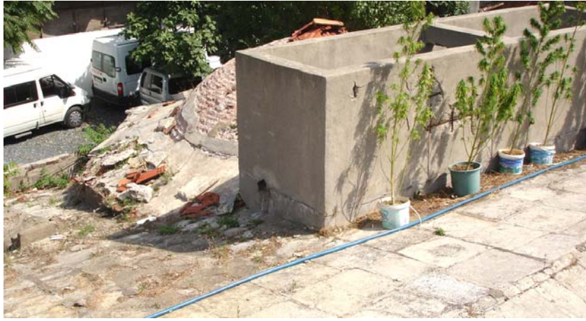
Şekil C.7-25: Su kulesinin kubbesindeki çimentolu onarım izi
