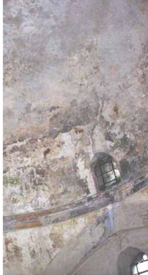
Şekil C.3-77: Kubbenin güneydoğusundaki yapısal çatlak [Aralık 2006]
