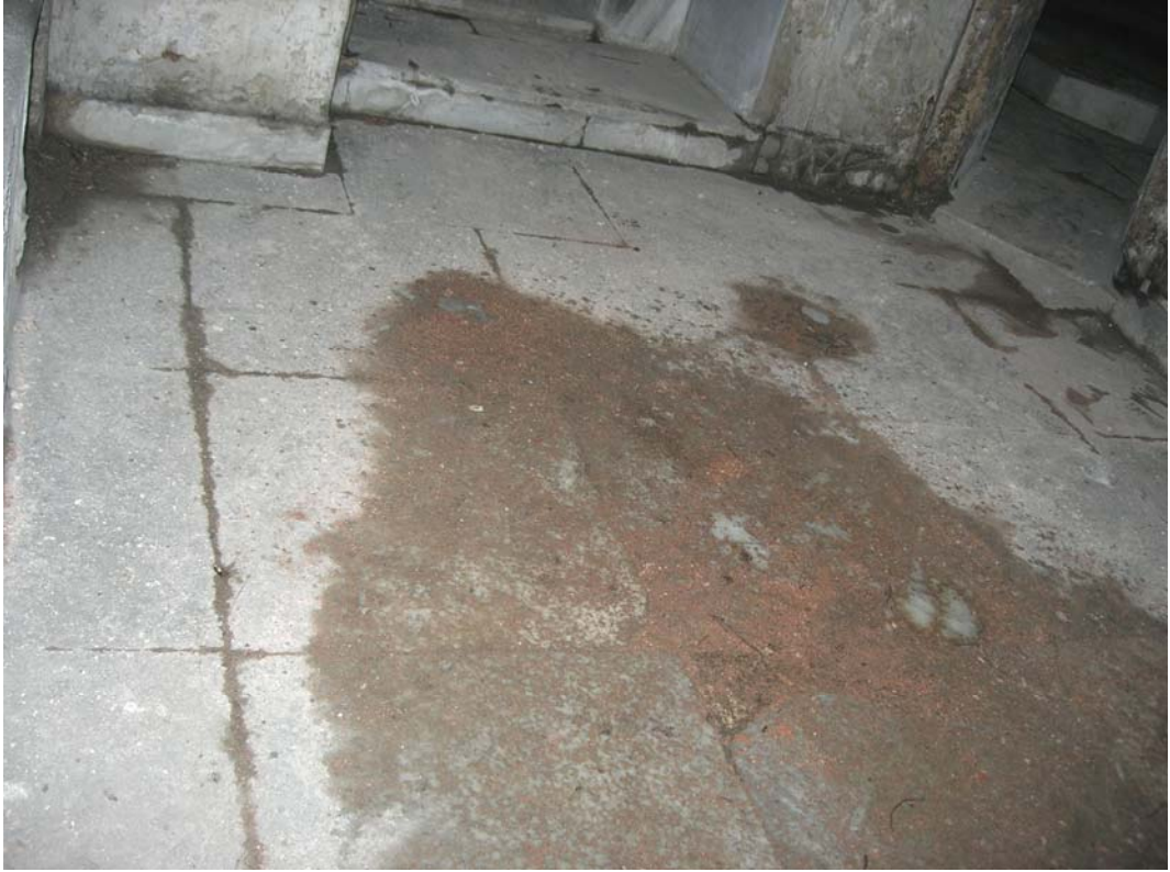
Şekil C.5-9: Z03'ün döşemesindeki bozulma
