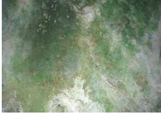
Şekil C.3-223: Z05-3; kuzeydoğu duvarındaki bozulmalar
