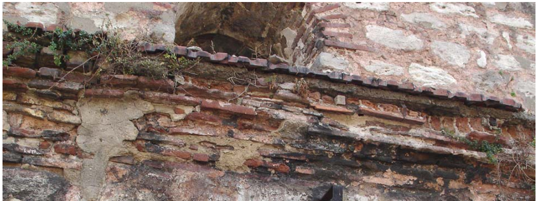
Şekil C.5-108: Z02 kuzeydoğu beden duvarı korniş; bozuk örgü
