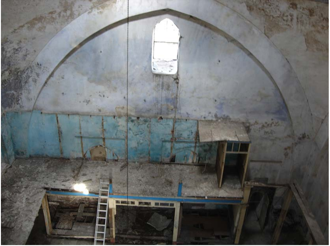
Şekil C.6-49: Şirvan; kuzeydoğu bölümü (14.10.2006)
