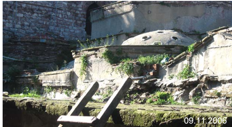
Şekil C.7-6: Güneydoğu cephesinde çimentolu onarımlar
