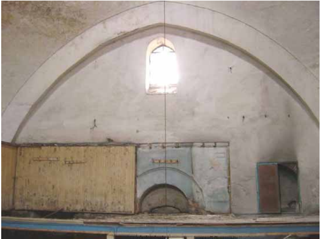
Şekil C.3-32: Güneybatıdaki şirvanın çökmeden önceki durumu [Ocak 2006]
