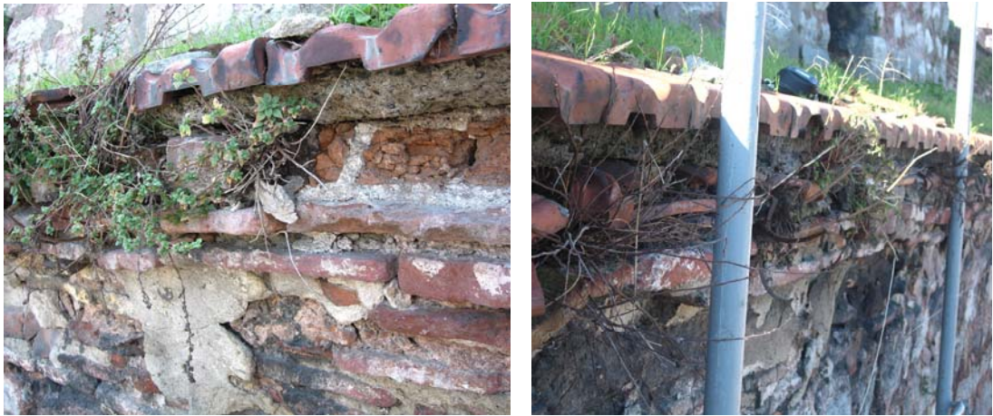
Şekil C.5-117: Kuzeydoğu kornişi; derzlerde büyüyen bitkiler
