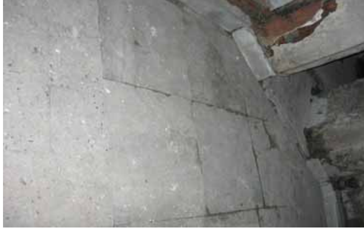
Şekil C.3-113: Z05 döşemesi; güneydoğu bölümü
