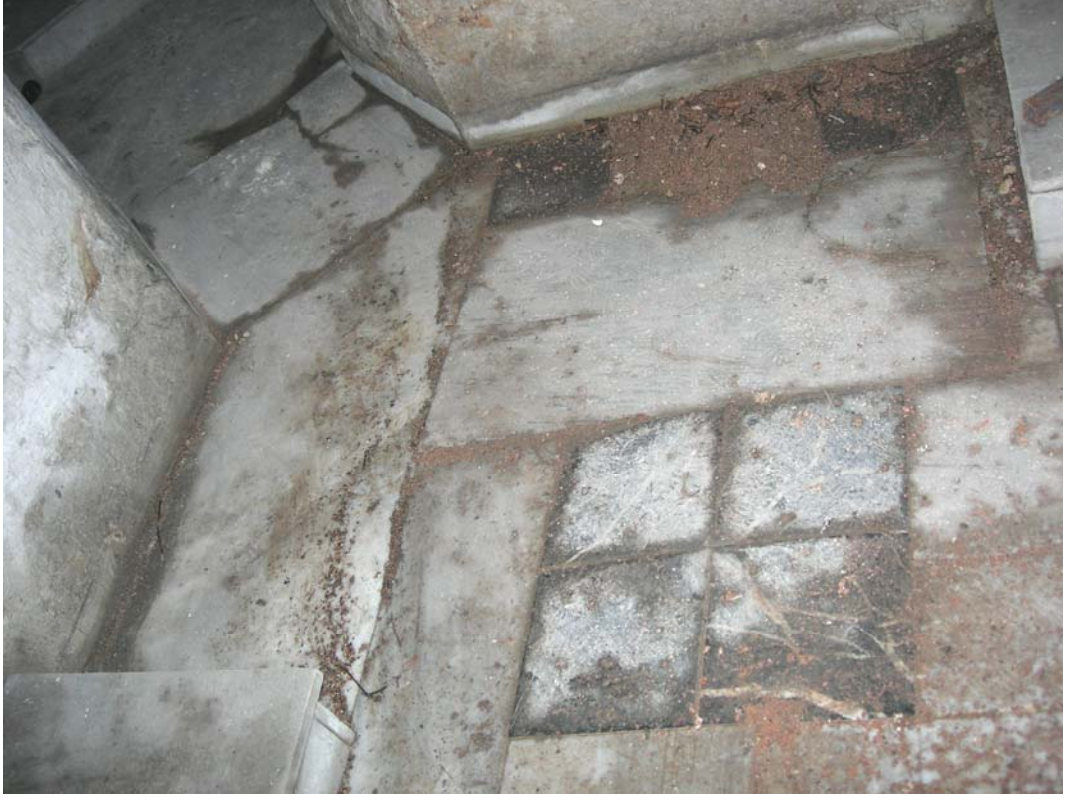
Şekil C.5-29: Z05-2 döşemesinde görülen bozulma
