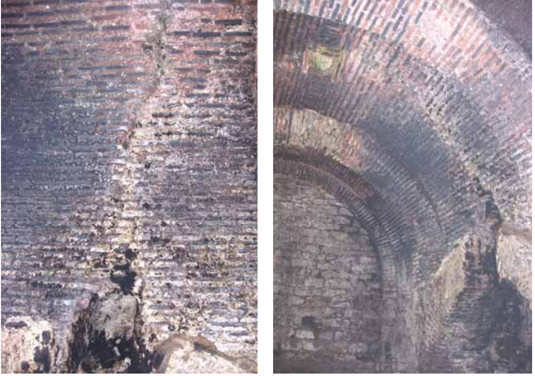
Şekil C.3- 259: Z07 tonozu; yapısal çatlak (18.11.2006)
