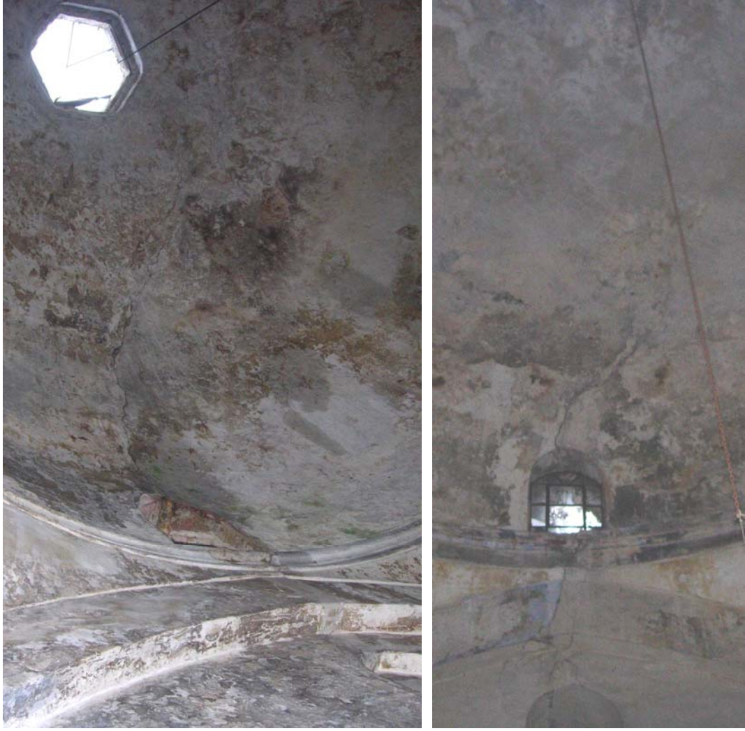
Şekil C.7-39: Soyunmalık kubbesindeki yapısal çatlak (01.11.2006)
