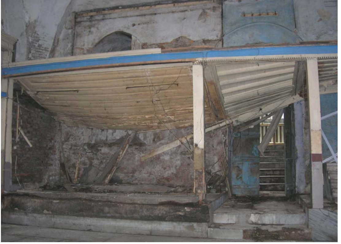
Şekil C.6-47: Şirvan; güneybatı bölümündeki çökme (13.06.2006)
