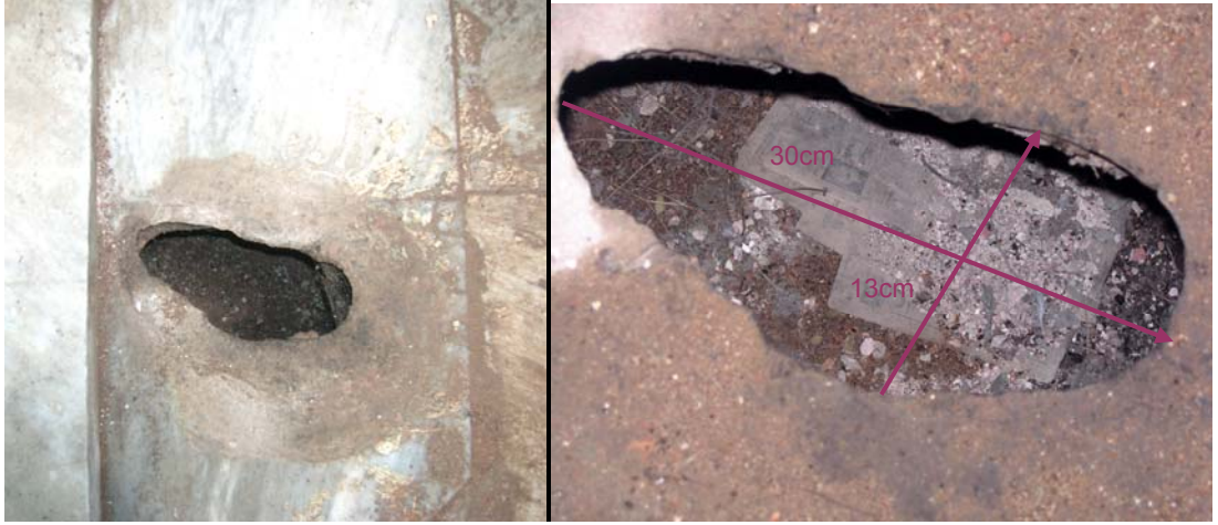
Şekil C.5-33: Z05-3 döşemesinin kuzeybatısındaki delik
