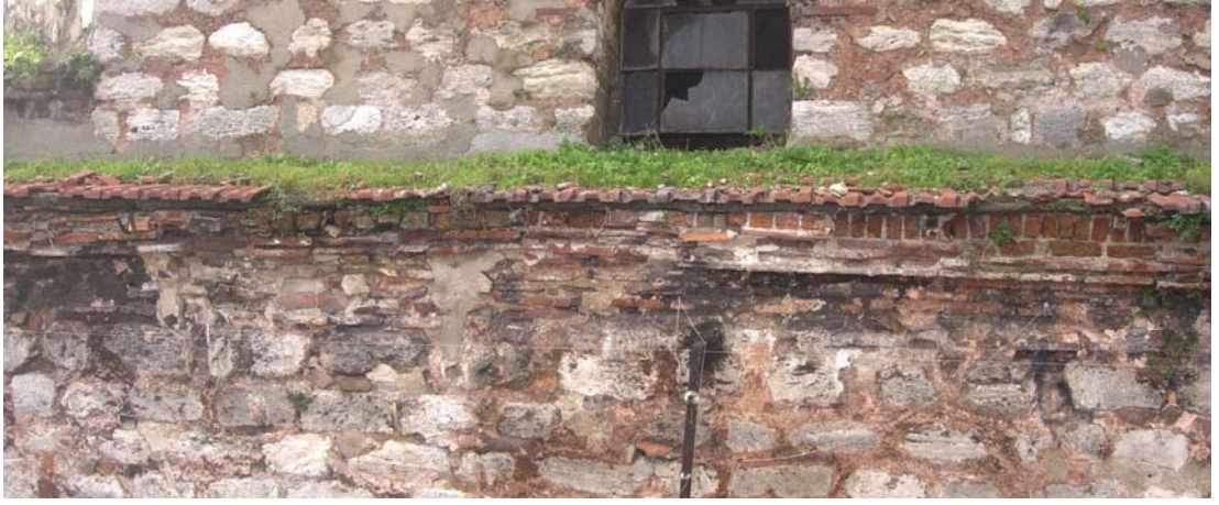
Şekil C.5-109: Z02 kuzeydoğu beden duvarı kornişi; bozuk örgü
