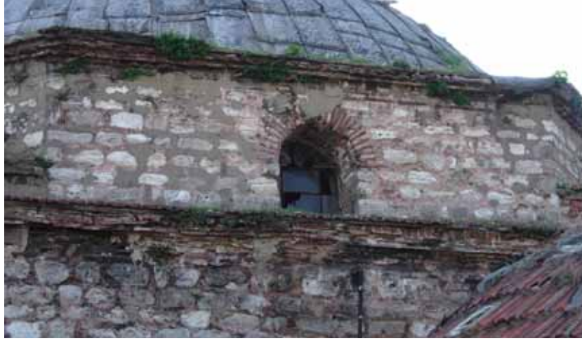
Şekil C.4-15: Kuzeydoğu cephesi; çimentolu onarımlar
