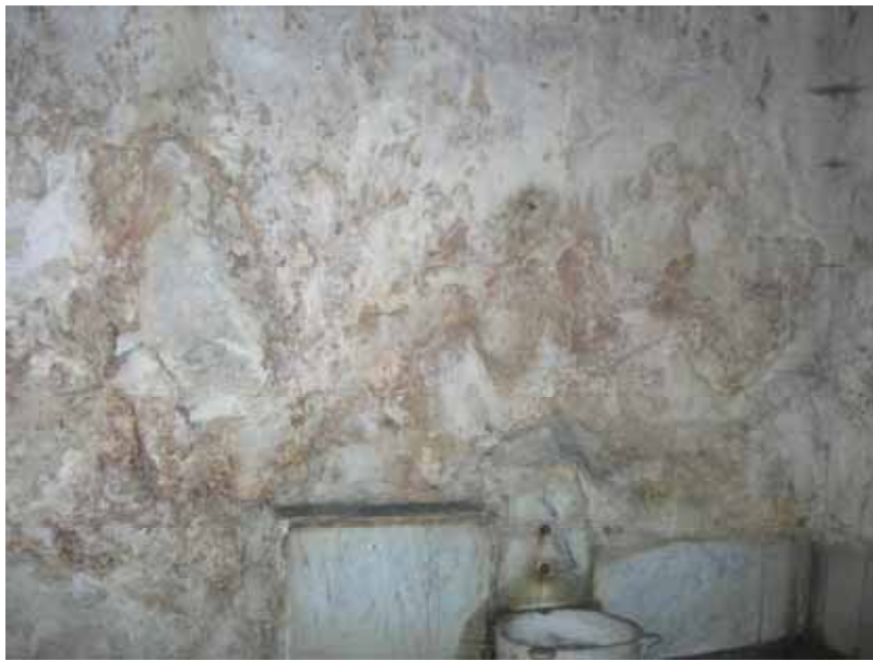
Şekil C.3-200: Z05-2; güneybatı duvarındaki bozulmalar
