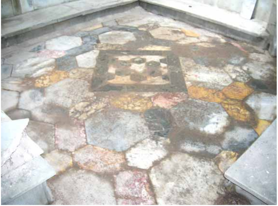
Şekil C.3-188: Z05-1 döşemesinin genel görünümü
