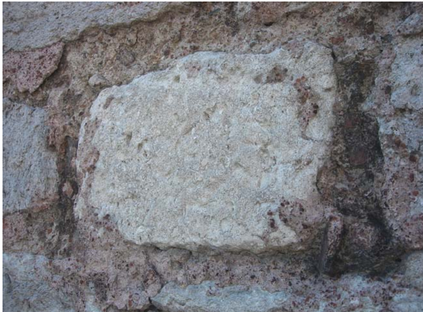
Şekil C.7-26: Soyunmalık kuzeydoğu cephesindeki derz boşalması
