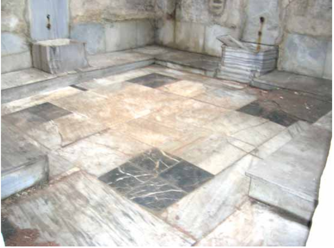
Şekil C.3-208: Z05-2 döşemesinin genel görünümü
