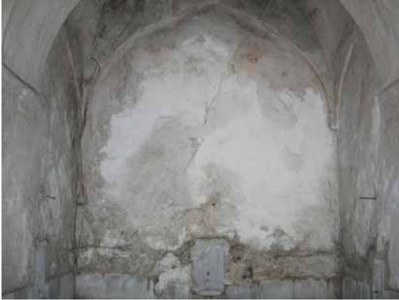
Şekil C.3-155: Z05c; kuzeydoğu duvarındaki bozulmalar
