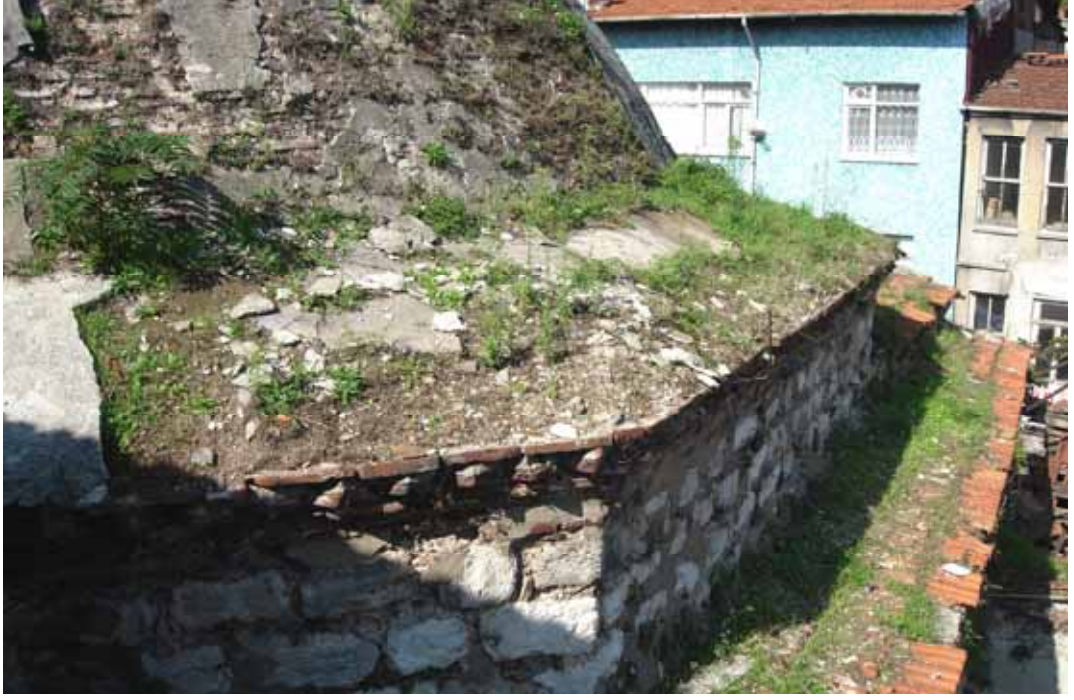
Şekil C.2-34: Kadınlar Bölümü; soyunmalık kubbesi, eksik kurşun örtü
