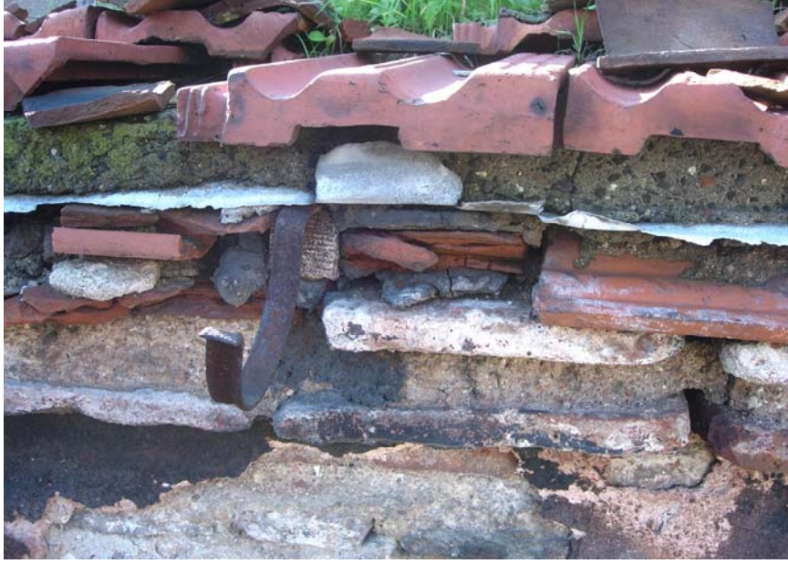
Şekil C.5-112: Kuzeydoğu kornişi; kötü onarım
