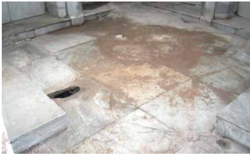
Şekil C.3-230: Z05-3 döşemesinin genel görünümü
