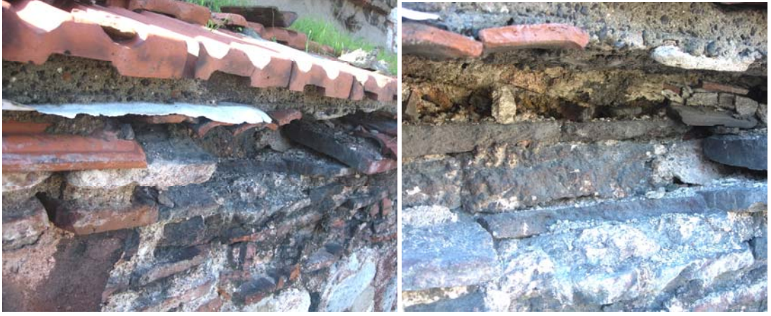
Şekil C.5-115: Kuzeydoğu kornişi; eksik saçak tuğlaları
