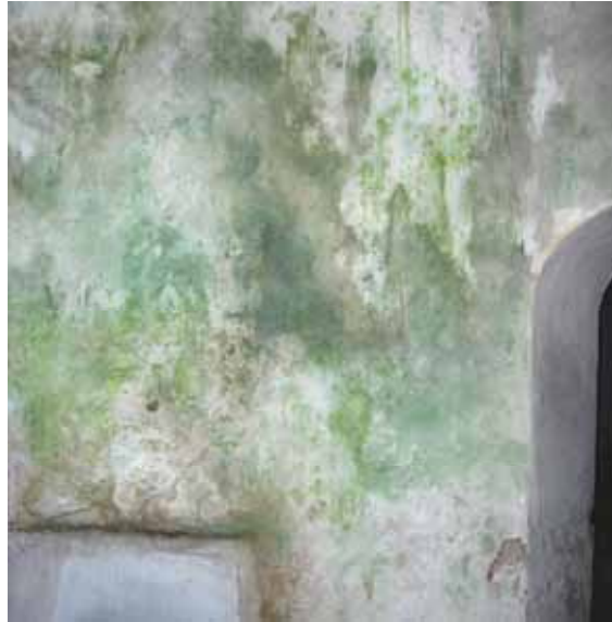
Şekil C.3-229: Z05-3; güneybatı duvarındaki bozulmalar
