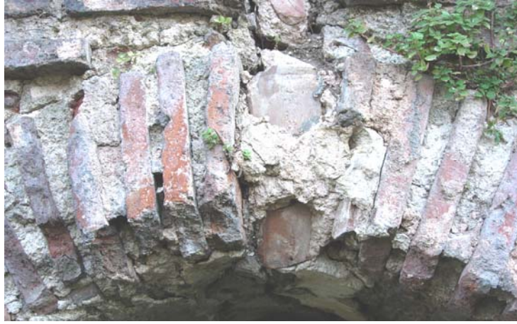
Şekil C.5-138: Kuzeybatı kasnak penceresindeki onarım izi
