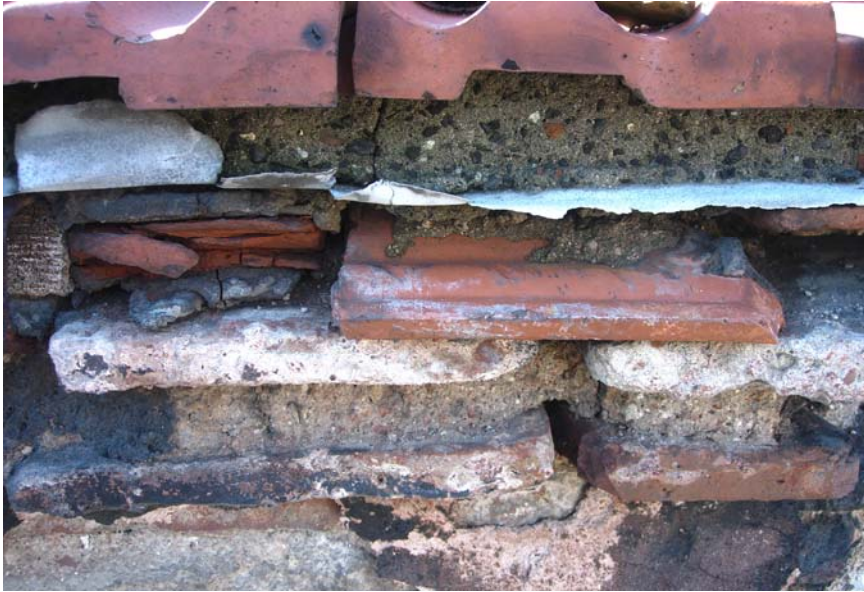
Şekil C.5-113: Kuzeydoğu kornişi; kötü onarım
