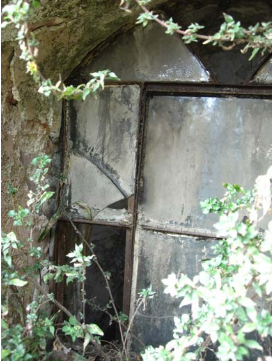
Şekil C.6-14: Güneydoğu penceresi kırık camlar
