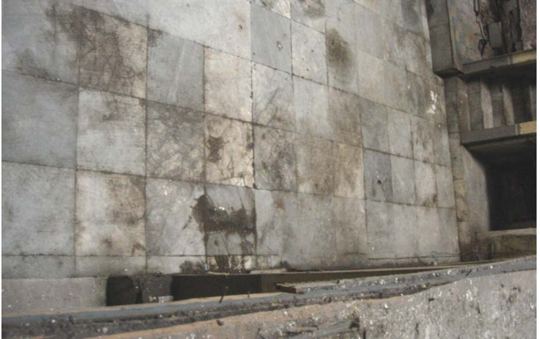
Şekil C.5-5: Z02 döşemesi; güneybatı bölümündeki hasar
