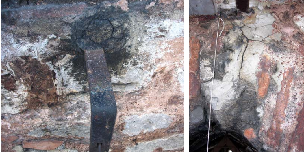
Şekil C.7-28: Soyunmalık kuzeydoğu cephesindeki onarım izleri
