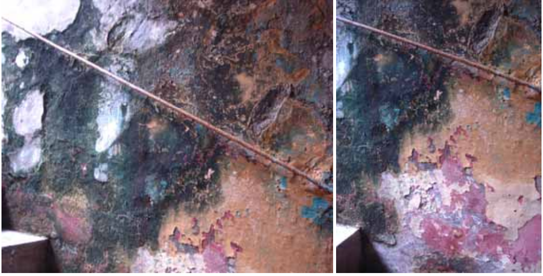
Şekil C.3-8: Z01; duvarlarda görülen bozulma
