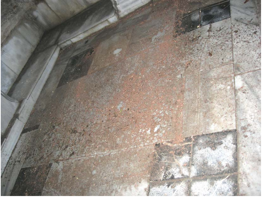
Şekil C.5-30: Z05-2 döşemesinde görülen bozulma
