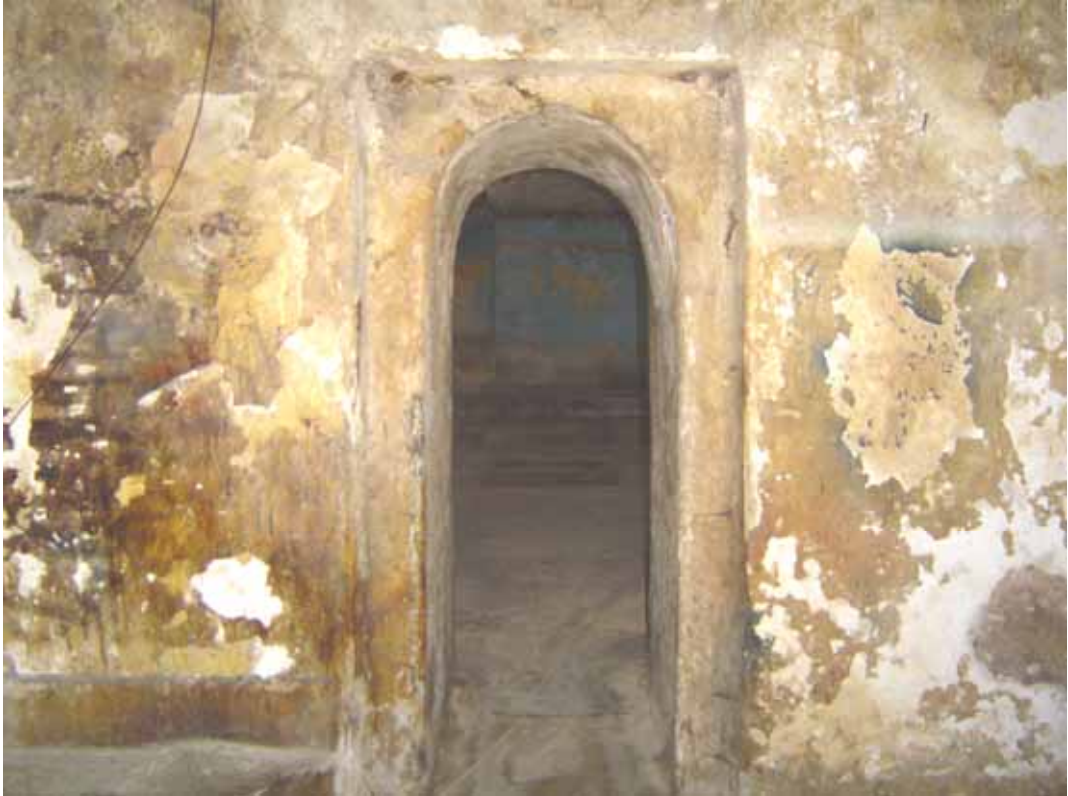
Şekil C.2-30: Kadınlar Bölümü; duvarda görülen bozulmalar
