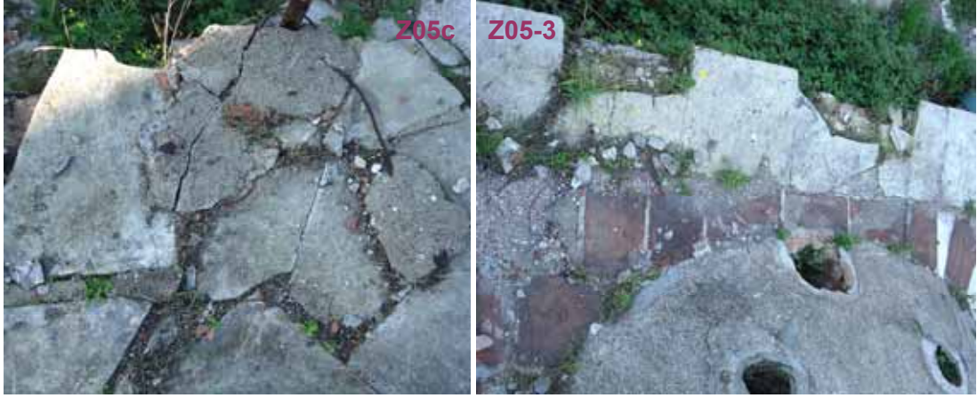
Şekil C.5-83: Kasnak saçaklarındaki bozulmalar
