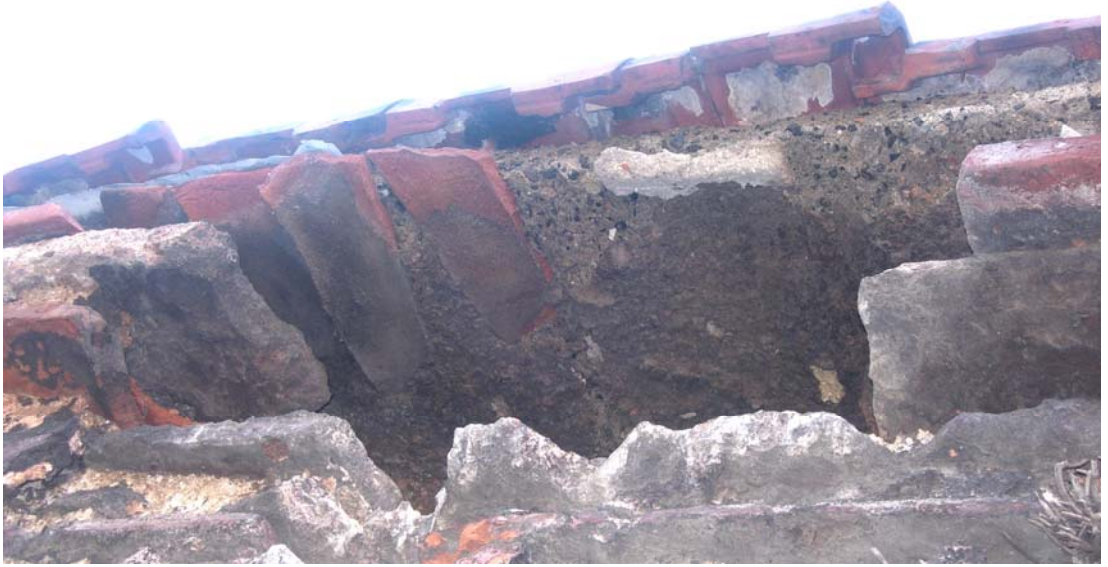
Şekil C.5-116: Kuzeydoğu kornişi; derin oyuk
