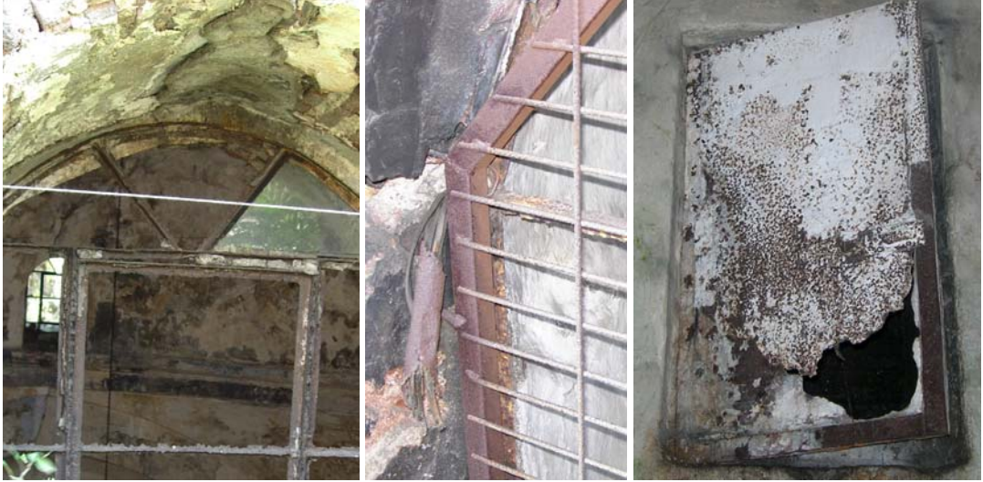
Şekil C.7-36: Demir elemanlarda gözlenen paslanma
