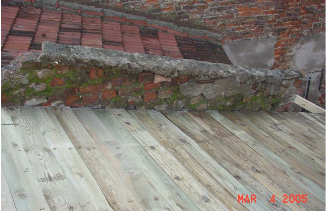
Şekil E.11: Emprenye edilmiş ahşap çatı kaplaması [AHUNBAY, Z.; 04.03.2005] [Zeyrek, İbadethane Sok. No:46'daki evin Restorasyonu]
