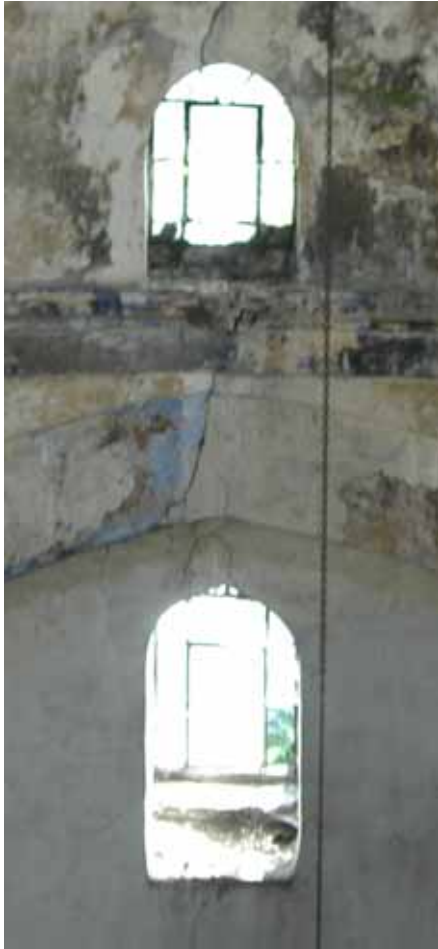
Şekil C.3-76: Güneydoğu penceresi ve yapısal çatlak
