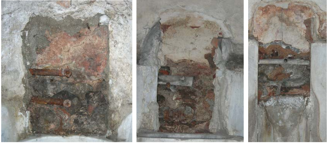
Şekil C.7-17: Sökülen ayna taşlarına ait izler
