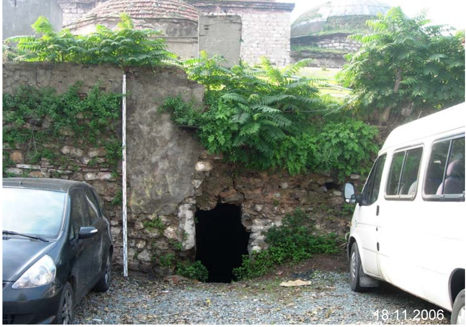
Şekil C.7-7: Külhan cephesindeki çimentolu sıva izleri
