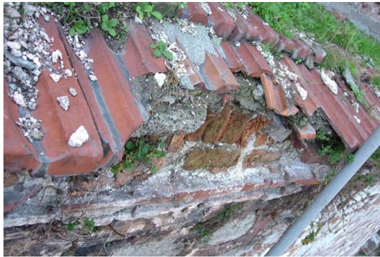
Şekil C.5-111: Kuzeydoğu kornişi; kırık kiremitler
