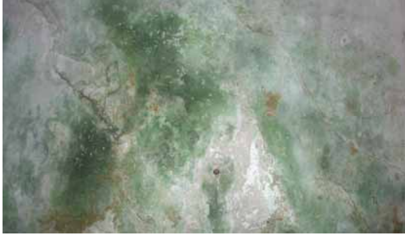
Şekil C.3-219: Z05-3; kuzeybatı duvarındaki bozulmalar
