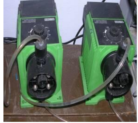
Şekil 3.20 : Geri yıkama pompaları.
