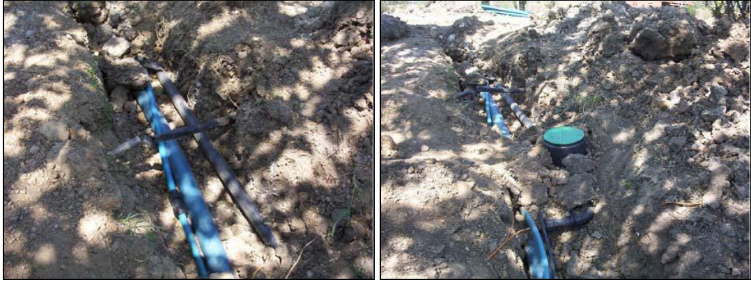
Şekil 4.3 : Döşenmiş sulama boruları ve cansuyu vanası (Url 6).
