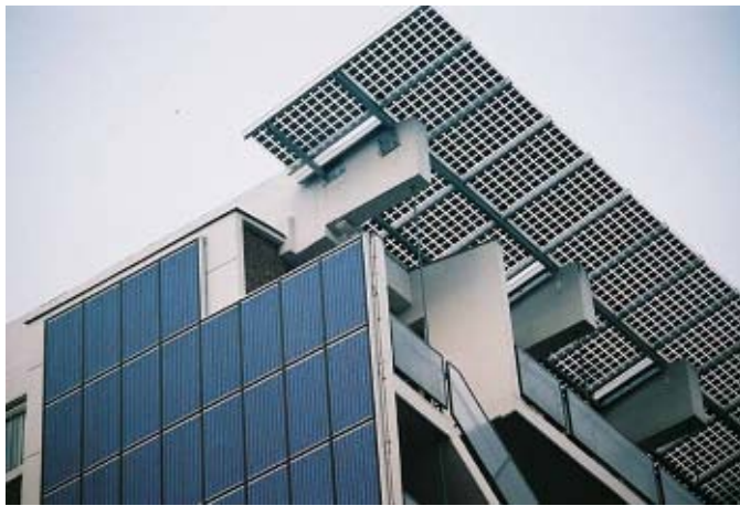
Şekil 2.6 : Delft'te cephe ve güneş kırıcı fotovoltaik uygulaması.
