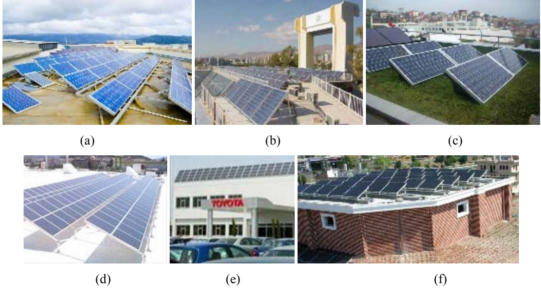
Şekil 1.1 : Teras çatı sistemi üzerine eklenen fotovoltaik sistemlerin ülkemizdeki uygulamaları.
