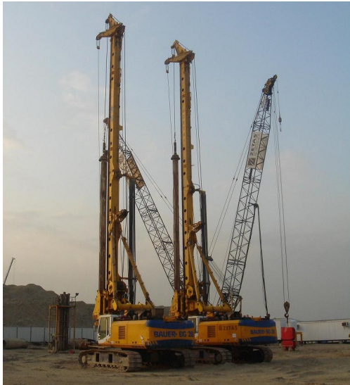
Şekil 3.3 : Hidrolik delgi makineleri ve servis vinçleri
