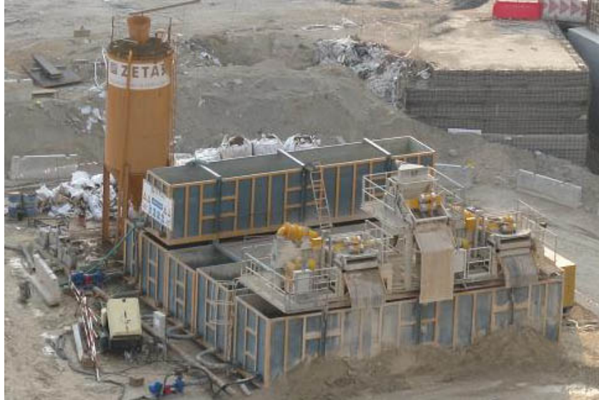
Şekil 3.15 : Diyafram duvar bentonit tesisi
