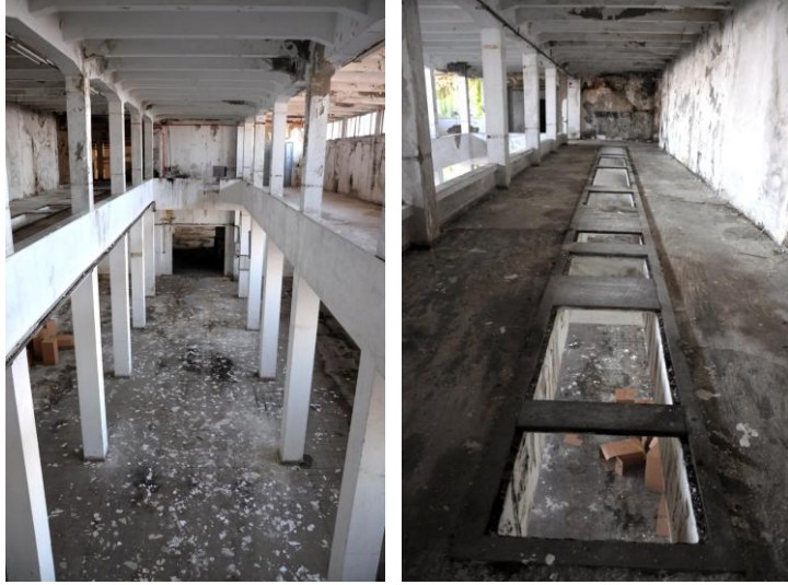
Şekil 5.25 : Söndürme dairesindeki galeri boşluğu ve döşemedeki diğer yırtıklar.
