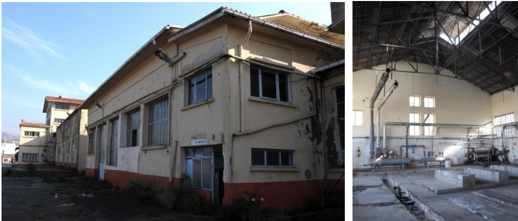
Şekil 5.37 : Bugünkü kazan dairesi ön cephe ve iç mekan görüntüleri Fotoğraf: M. Gülcan Şahin, 2010.
