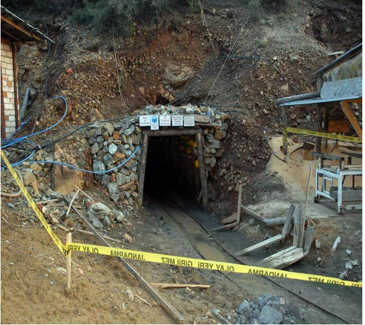
Fotoğraf 3: 1800 Yılında Kullanıma Açılan Bolkar (Bulgar) Kazası Maden Ocağının Günümüzde Çökme Tehlikesi Nedeniyle Tedbiren Kapatılmış Hali
