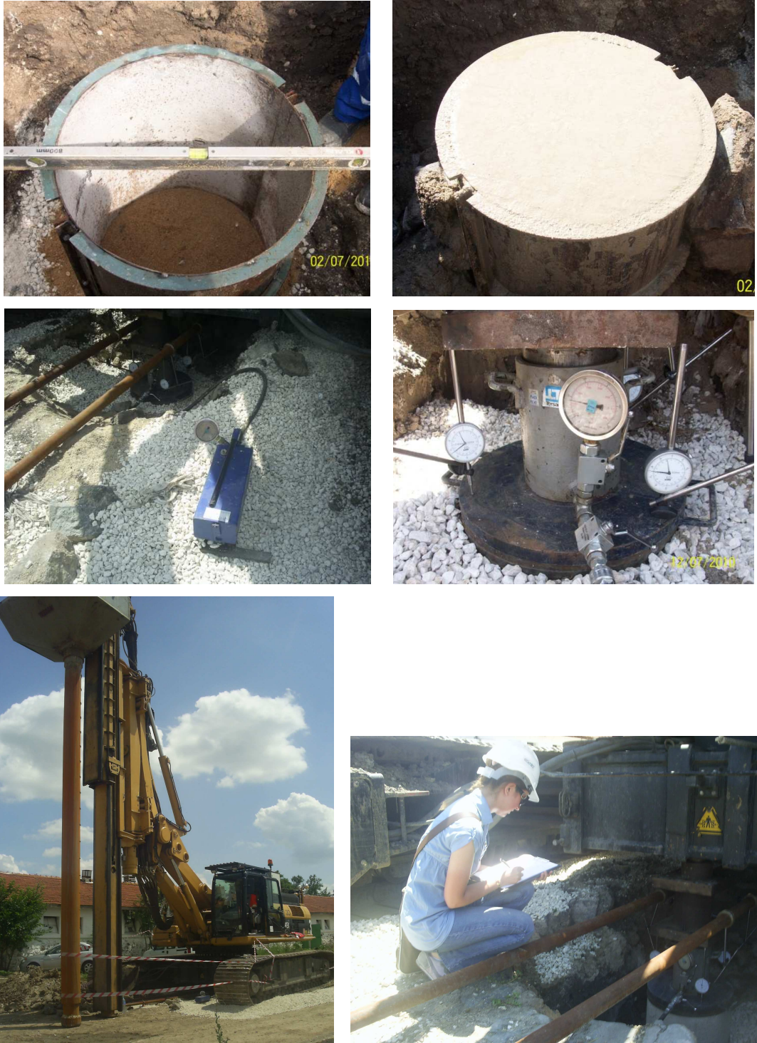
Şekil 4.11 : DKK ve TK elemanları üzerinde uygulanan yükleme testleri.
