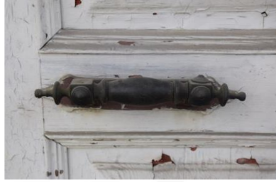
Fotoğraf 267. Doğu Cephe Giriş Kapısı Çekeceği
