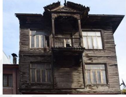
Fotoğraf 154. Gölbucağı Mahallesi 114. Cadde 2 Numaralı Ev
