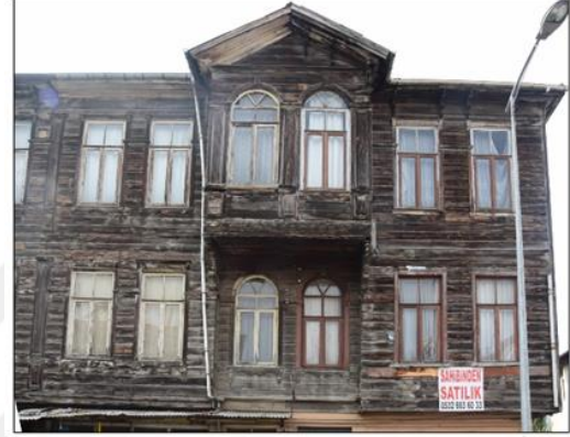
Fotoğraf 446. Gölbucağı Mahallesi 114. Cadde 33 Numaralı Ev
