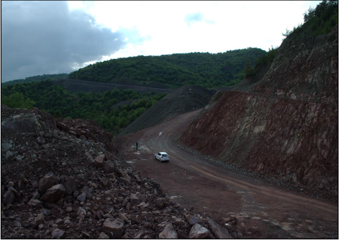
Fotoğraf 2. Araştırma alanının güney kesimini (Kışlaköy ve çevresi) Araç'a bağlayan yolun yüksek eğimli sahadan geçtiği bölümde yol yapım çalışmaları
