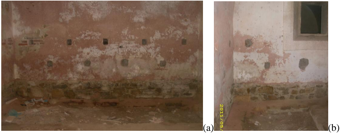
Şekil 5.29: (a)Z08 no'lu mekanın duvarlarında yer alan havalandırma boşlukları (b) duvar yüzeylerinde çimento sıva ile yapılan müdahale.
