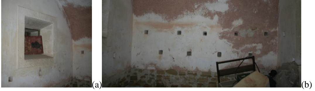
Şekil 5.54: (a) Z14 no'lu mekan ile arasında yer alan havalandırma açıklığı (b) Duvarlar üzerindeki havalandırma boşlukları ve özgün döşeme kotu izi.
