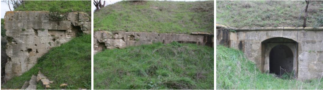
Şekil 5.46: Top yeri II, kendi içinde kırılarak iki duvar yüzeyinden oluşan Bonet II'nin bai duvarı ve cephane sevkiyat koridorundan top yerine açılankapı
