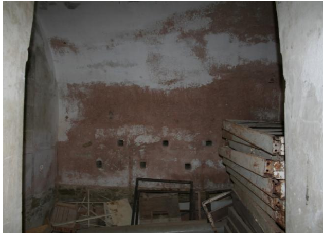
Şekil 5.37: Z10 no'lu mekanın giriş sahanlığı ve duvar üzerinde yer alan havalandırma boşlukları.
