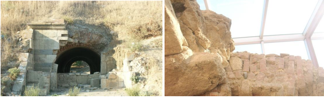
Şekil 5.58: Namazgah Tabyası, I. Dünya Savaşı esnasında top etkisi ile yıkılan alan, örtü sistemi detayı, restorasyon öncesi ve sonrası.
