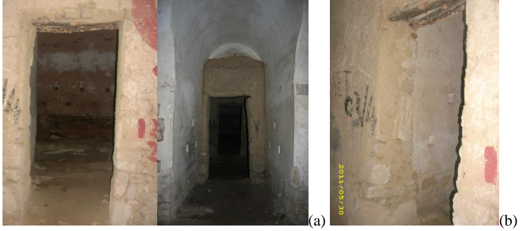
Şekil 5.36: (a) Z10 no'lu mekanın giriş kapısı, (b) Kapı üzerinde yer alan ahşap lento detayı.
