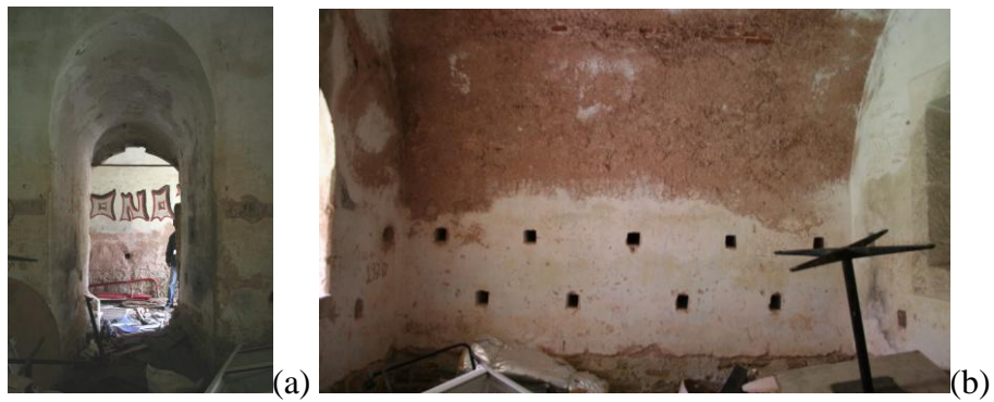
Şekil 5.51: (a) Z14 no'lu mekanın giriş sahanlığı (b) Z14 no'lu mekanın duvarlarında yer alan havalandırma boşlukları.
