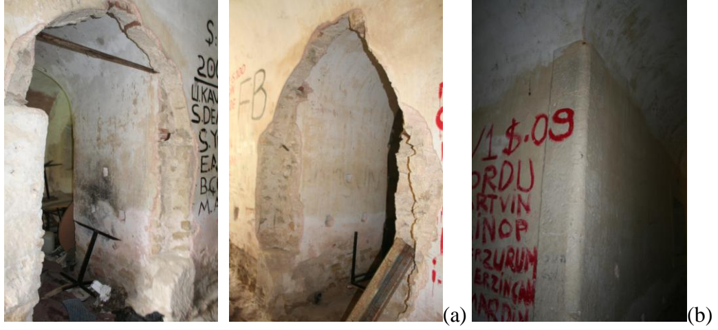
Şekil 5.50: (a) Z13 no'lu mekandan cephane odalarına açılan kapı açıklıkları (b) Holün cephane sevkiyat koridoruna dönüşünde yer alan plastr.
