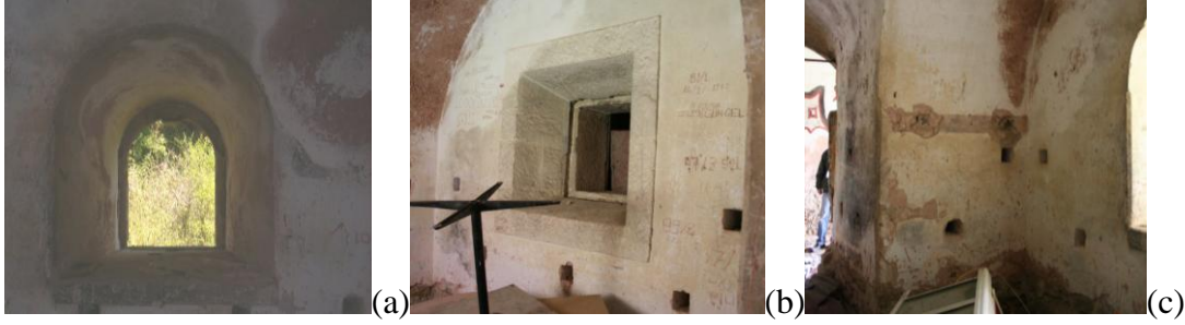
Şekil 5.52: (a) kemerli pencere açıklığı (b) Z15 no'lu mekan ile arasındaki havalandırma açıklığı (c) duvarlarda yer alan havalandırma boşlukları.
