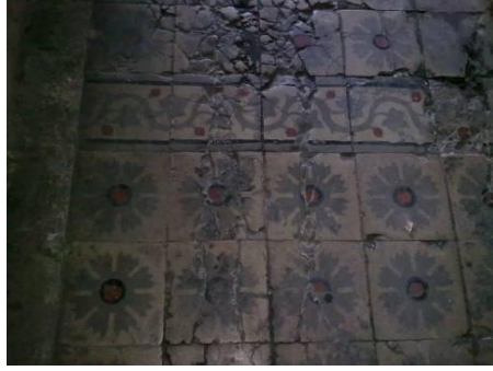
Şekil D.60 : 64 numaralı yapının karo siman döşemesi.
