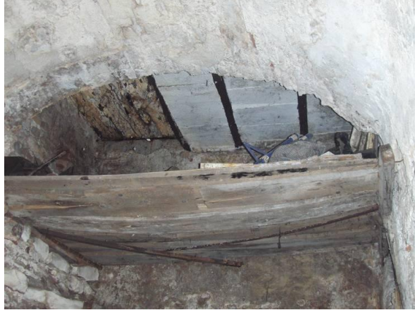
Şekil D.39 : 44 numaralı kârgir yapının bodrum katındaki kemerin üzerinde görülen volta döşeme ve tahtalar.
