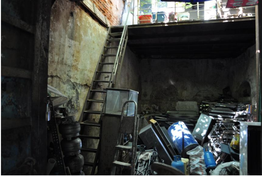
Şekil D.89 : 96 numaralı (68 ada 6 parseldeki) harap tescilli yapının iç mekânı.
