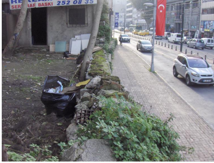
Şekil D.42 : 46 numaralı (127 ada 28 parseldeki) taş duvar kalıntıları ve bu kota ulaşmayı sağlayan baraka.
