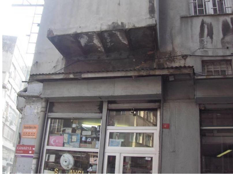
Şekil D.37 : 43 numaralı (125 ada 1 parseldeki) tescilli yapı ve cumbasındaki volta döşeme.
