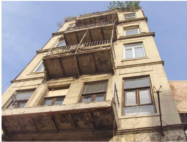
Şekil D.38 : 44 numaralı yapının cumbalarındaki sıva döküldüğü için görülen volta döşemeler.
