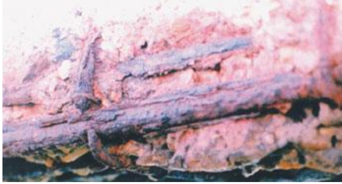
Şekil 10.12 : Korozyona uğramış perde donatısı [57].
