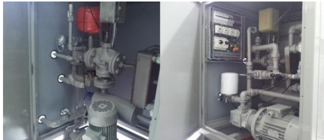
Şekil 5.25 : Motor suyu (solda) ve yağı (sağda) şartlandırma sistemleri.
