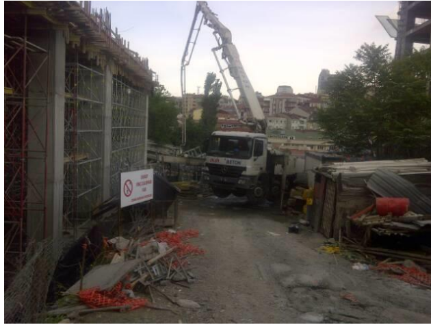
Şekil 6.7: Risk Değerlendirmesinin yapıldığı beton pompası.
