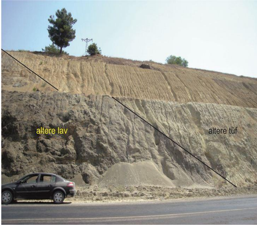
Şekil 4.2.1.1d : Çanakkale-Çan yol yarmasında altere lav-kaolenleşmiş tüfün faylı dokanağı (463252/4435112).
