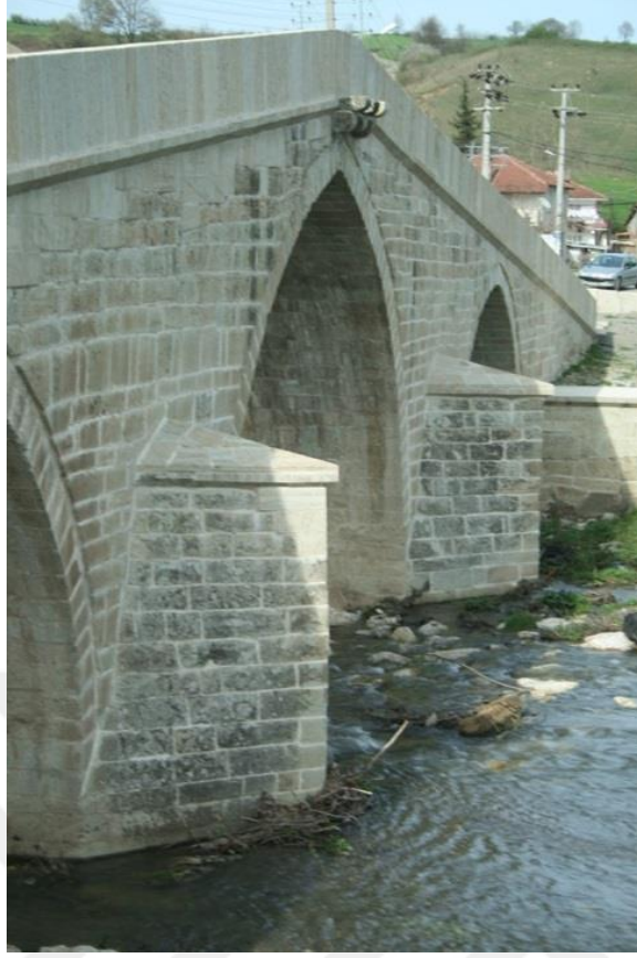
Şekil 5.147 : Köprünün güneydoğu tarafında yer alan selyaranlar.
