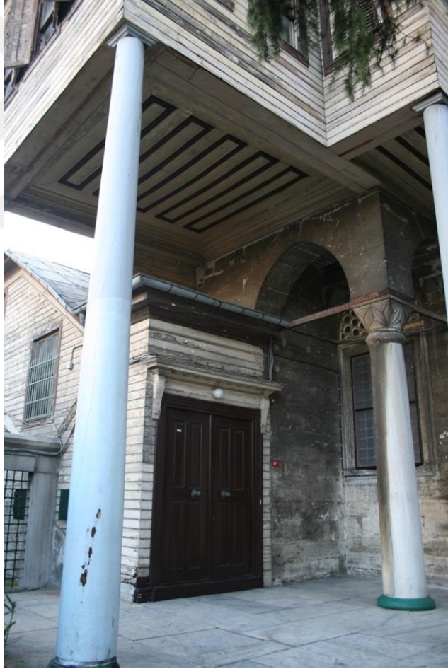
Şekil 5.211 : Hünkâr kasrının girişine bitişik kâgir altyapı, sivri kemerler ve baklava dilimli başlıklı mermer sütun.
