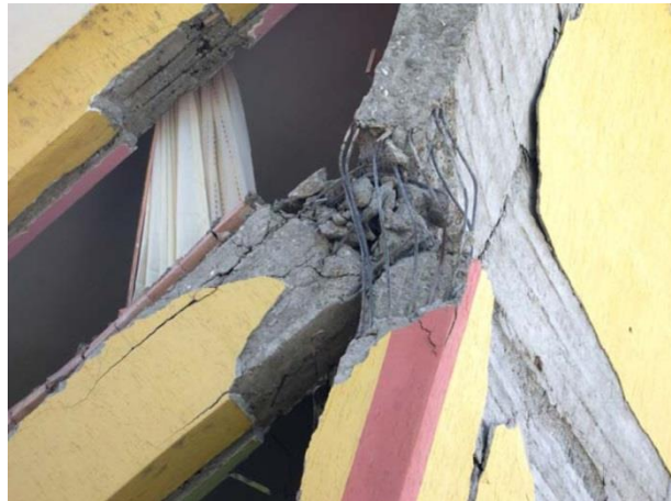
Şekil 2.14 : Hasar durumu göçme olan yapı elemanları (2) (Van 2011 Depremi – Gedikbulak İlköğretim Okulu Binası)
