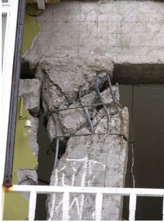
Şekil 2.15 : Hasar durumu göçme olan yapı elemanları (Van 2011 Depremi)
