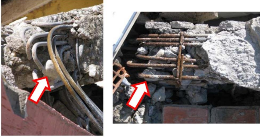
Şekil 2.13 : Hasar durumu göçme olan yapı elemanları (Van 2011 Depremi – Gedikbulak İlköğretim Okulu Binası)
