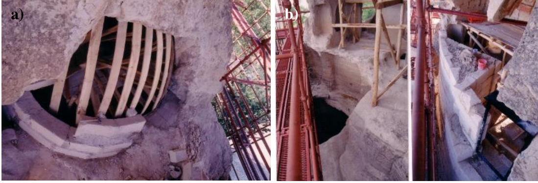
Şekil 3.34 : a) El Nazar Kilisesi yıkılan apsis duvarının taş duvar ile bütünlenmesi (R. İşler). b) El Nazar Kilisesi yıkılan batı cephesinin taş duvar ile bütünlenmesi (R. İşler).
