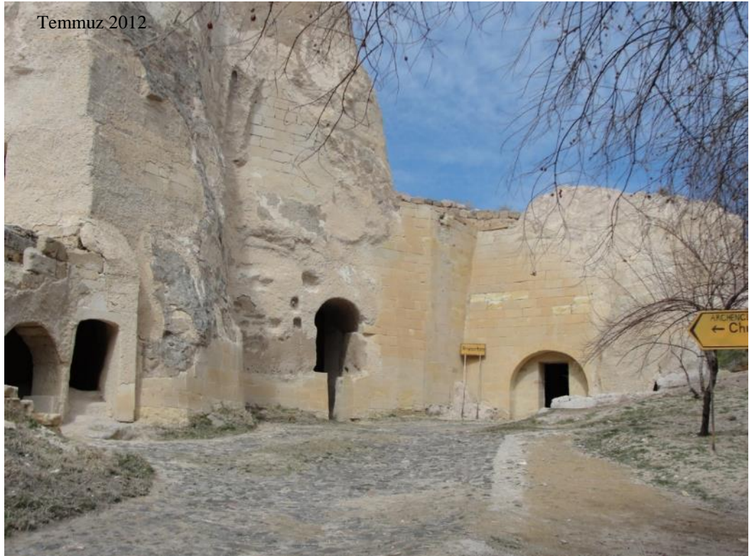
Şekil 4.46 : Manastır yemekhanesinin mevcut durumu. Örülen duvar ve doldurulan oyuklar.
