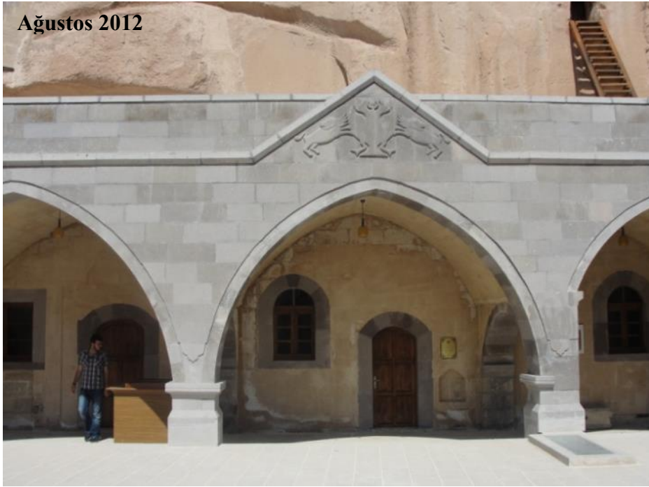
Şekil 4.255 : Aya Nikola Manastırı, rekonstrüksiyonu yapılan dış narteksin mevcut durumu, duvar yüzeylerinde nem ve çiçeklenmeler.
