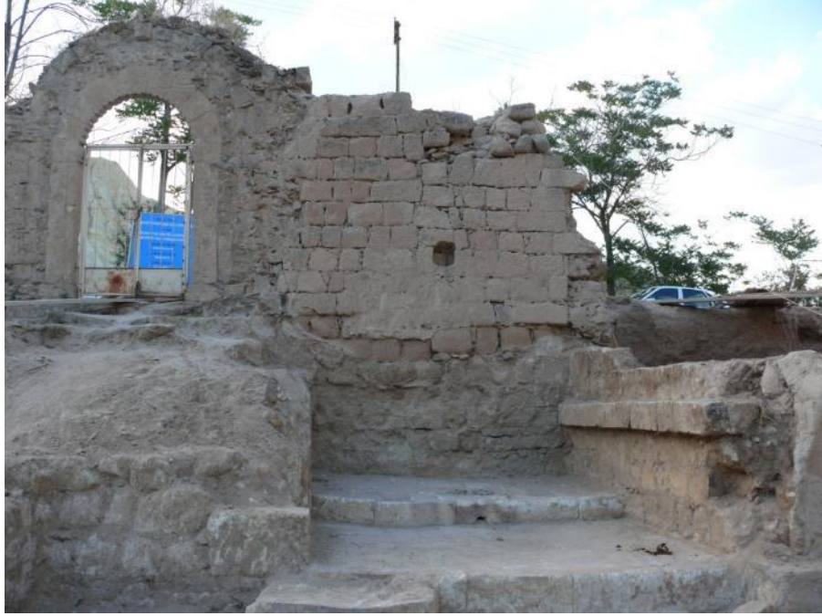
Şekil 4.264 : Aya Nikola Manastırı, kuzey avlu duvarlarına ve 1 no'lu kilisenin yok olan batı bölümüne avludan bakış onarım öncesi (F. Sağcan).
