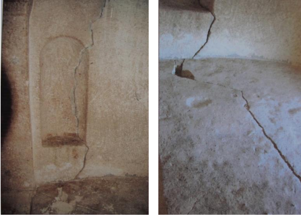
Şekil 4.166 : Kayakapı Kilisesi apsis duvar ve zemininde devam eden çatlaklar (NKK Arşivi).
