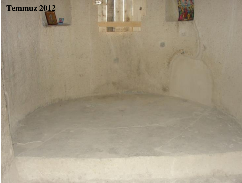
Şekil 4.167 : Kayakapı Kilisesi apsis duvar ve zemininde enjeksiyon yöntemiyle doldurulan çatlaklar ve nişin altındaki doldurulmuş oyuk.
