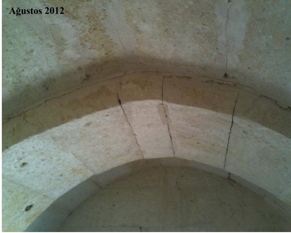
Şekil 4.268 : Aya Nikola Manasırı avlu odalarında tonoz örtü kemerlerinde çatlak ve derzlerde ayrılma.
