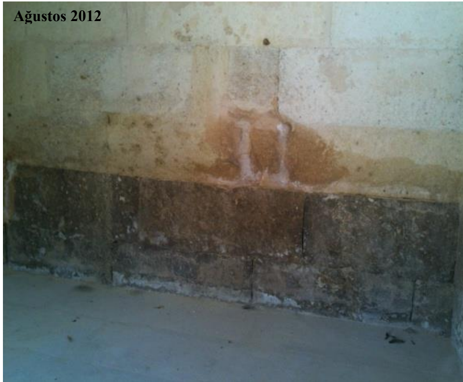
Şekil 4.269 : Aya Nikola Manasırı avlu odalarında zeminden yükselen nem ve çiçeklenmeler.
