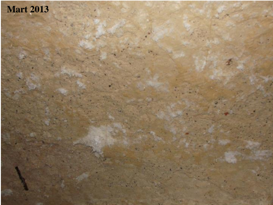
Şekil 4.239 : Aya Nikola Manastırı, 3 no'lu kilise apsisinin arkasındaki odanın doğu tarafı, onarılan kısım, nem ve neme bağlı küflenme, korozyona uğrayan donatı.
