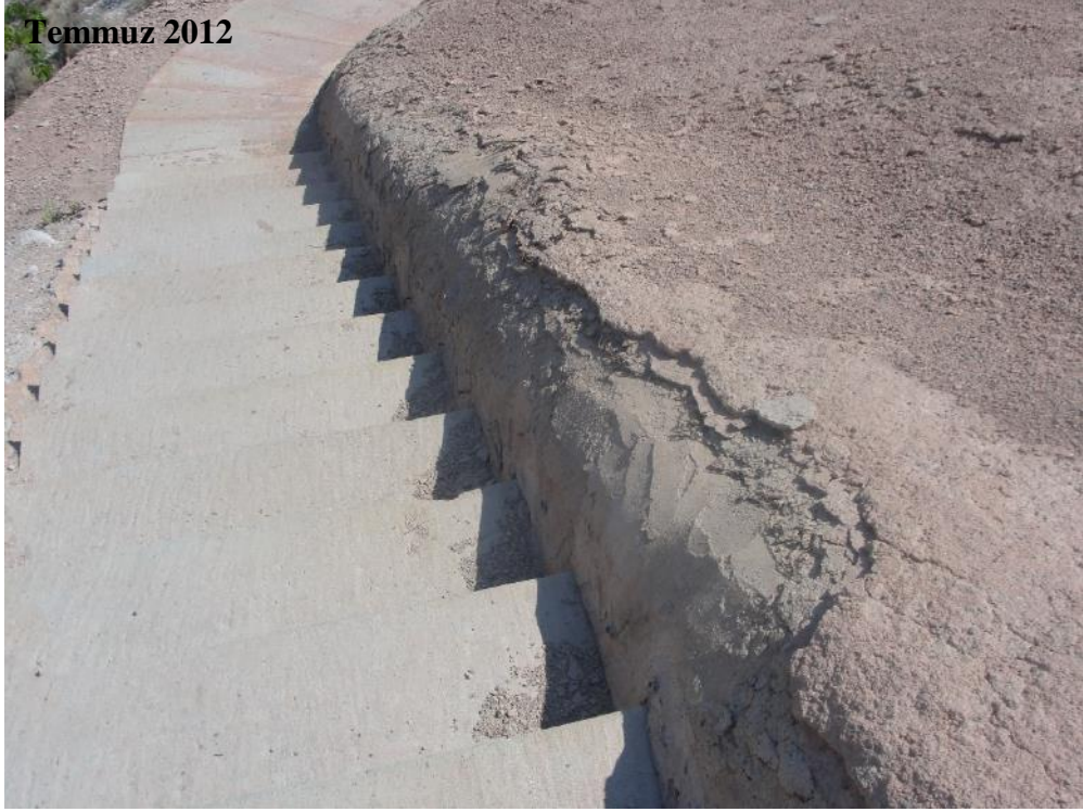
Şekil 4.137 : Sarıca Kilise terasına ulaşan merdiven ve bozuşan sıva tabakaları.
