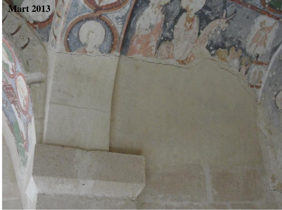
Şekil 4.89 : Birleşim noktasından ayrılan ve fresk kaplı yüzeyde devam eden çatlak.
