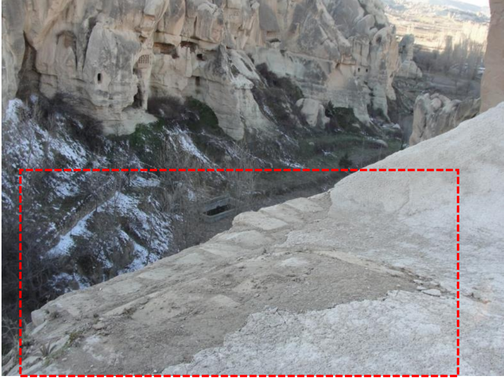
Şekil 4.38 : Elmalı Kilise giriş saçığının üstten görünüşü ve yerinden oynaya taş blokları.
