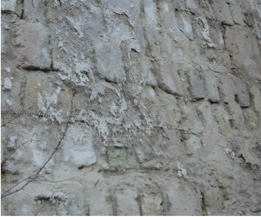
Şekil 4.40 : Elmali Kilise istinat duvarı güney tarafı sıva, taş ve rabitz teli bozulmaları.
