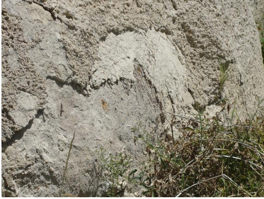
Şekil 4.65 : Dökülen imitasyon sıva ve korozyona uğrayarak bir parçası kopmuş sıva teli.
