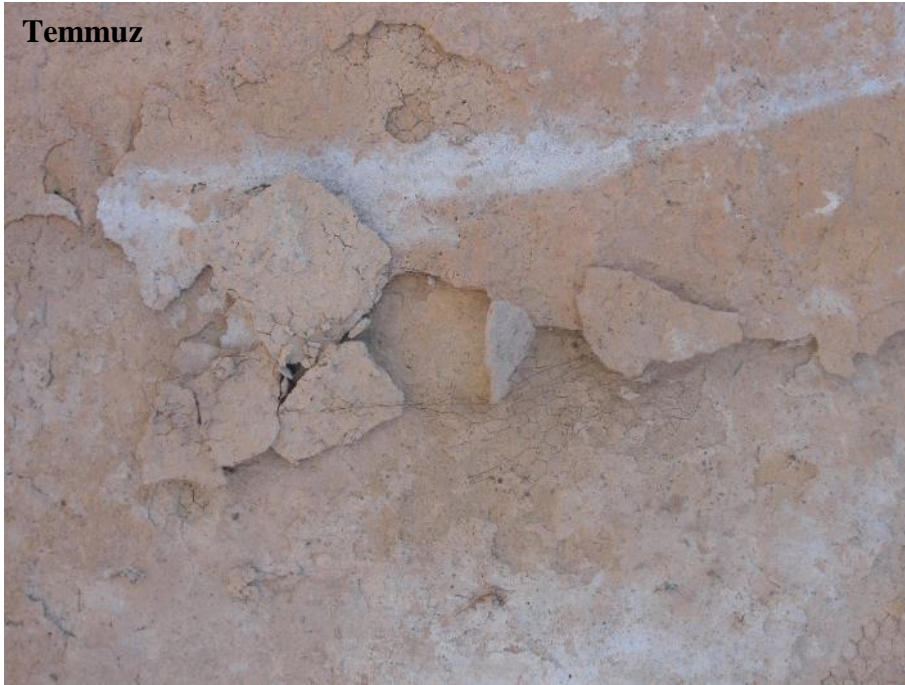
Şekil 4.136 : Sarıca Kilise dökülen sıva tabakası, çiçeklenmeler, korozyona uğrayan ve dağılan rabitz teli.
