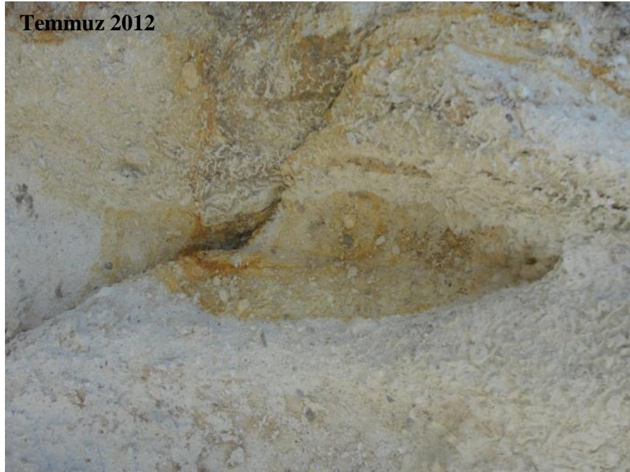
Şekil 4.177 : Kilise batı cephesinde tufün bünyesindeki metallerin oksidasyonu sonucu oluşan renk değişimleri.
