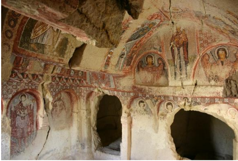
Şekil 3.3 : Göreme AHM. Meryem Ana Kilisesi'ndeki yapısal çatlaklar.
