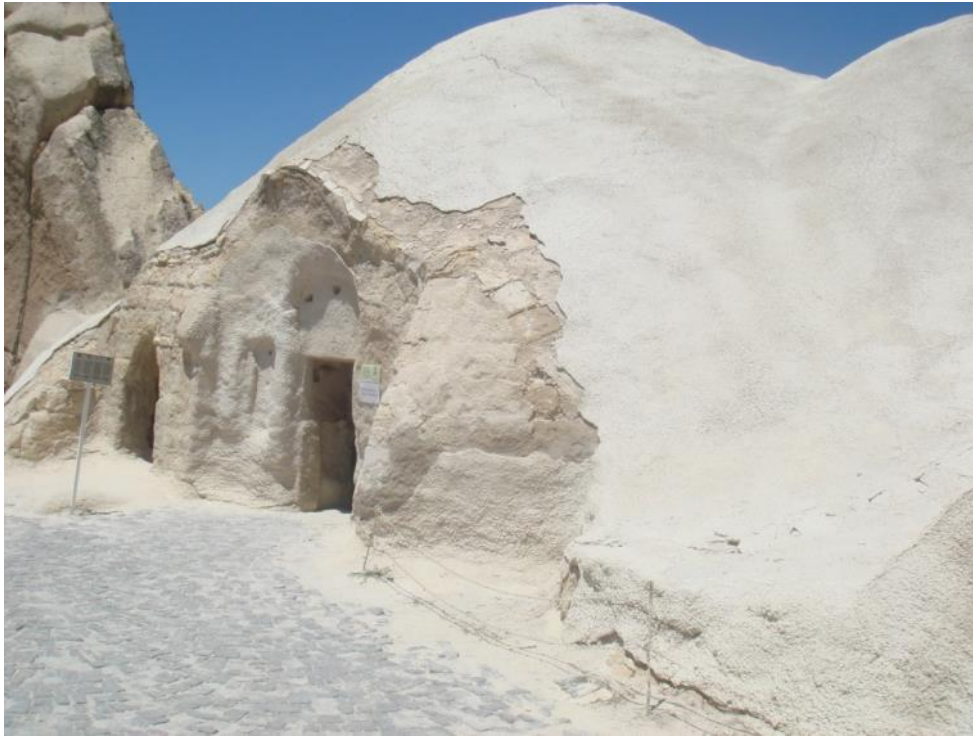
Şekil 4.35 : Azize Barbara Kilisesi güney cephesi dökülen sıva tabakası.
