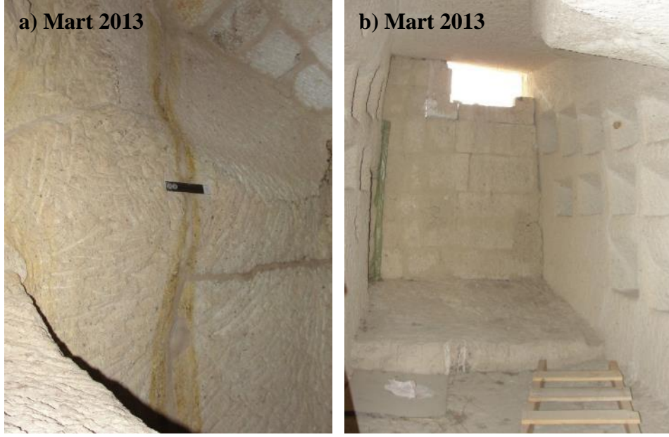
Şekil 4.176 : a) Güvercinlik mekânında doldurulmuş çatlaklar ve çatlak izleme monitörü. b) 1. kat güvercinlik mekânının mevcut durumu.
