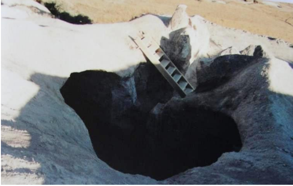
Şekil 4.119 : Sarıca Kilise doğu mekânı (trapeza) yıkılan üst örtüsü (NKK Arşivi).
