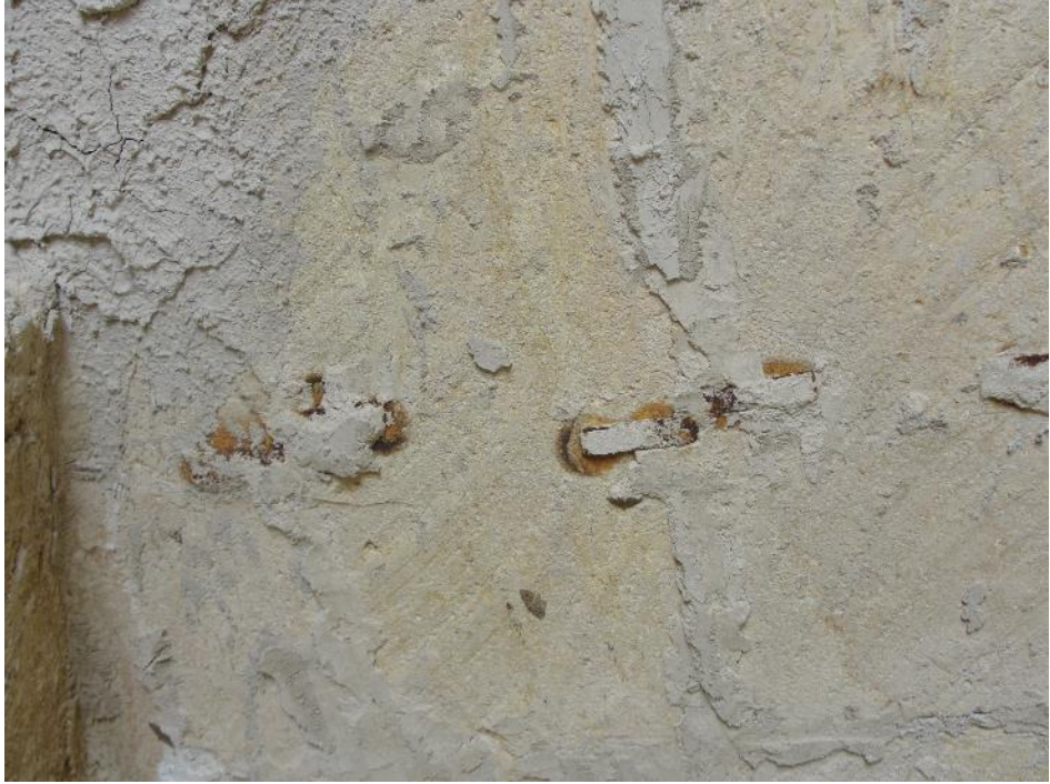
Şekil 4.70 : Ayazma önüne inşa edilen 2. girişin tavanı ve korozyona uğrayan kenet elemanları.
