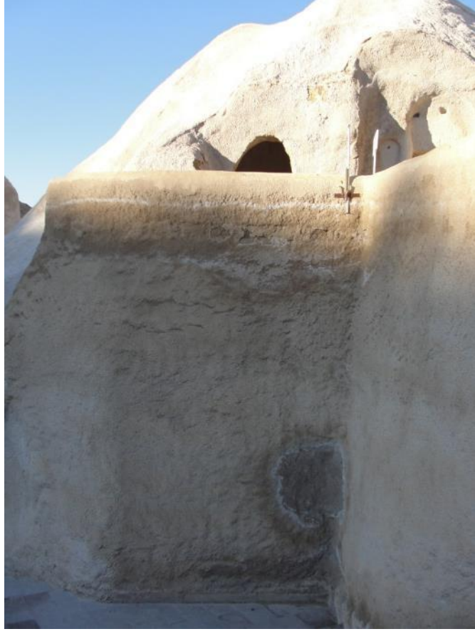
Şekil 4.42 : Azize Barbara Kilisesi'ne bakış, nemlenmeler, çiçeklenmeler ve sıva dökülmeleri.
