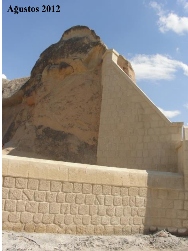
Şekil 4.263 : Aya Nikola Manastırı, kuzey avlu duvarlarında mevcut durum.
