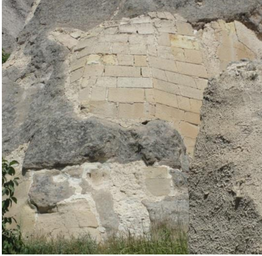
Şekil 4.61 : Doldurulmuş derin oyuklar, sıva tabakasının dökülmesi, örgü tekniği problemi.
