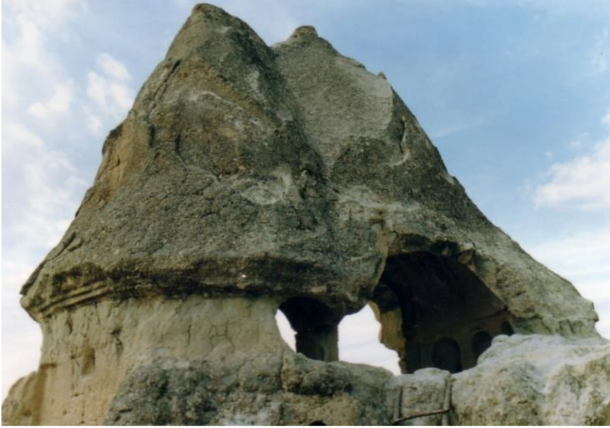
Şekil 4.79 : El Nazar Kilisesi güneydoğu cephesi yıkılan kaya cidarı, çatlaklar ve kavlamalar (R. İşler).
