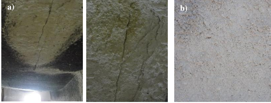
Şekil 3.8 : a) Göreme AHM yemekhane tavanı is kaplı yüzeyler ve çatlaktan sızan suya bağlı erozyon. b) Göreme kaya yüzeyde atmosfer şartlarına bağlı ileri derecede bozuşmuş, topraklaşmış tuf malzeme.
