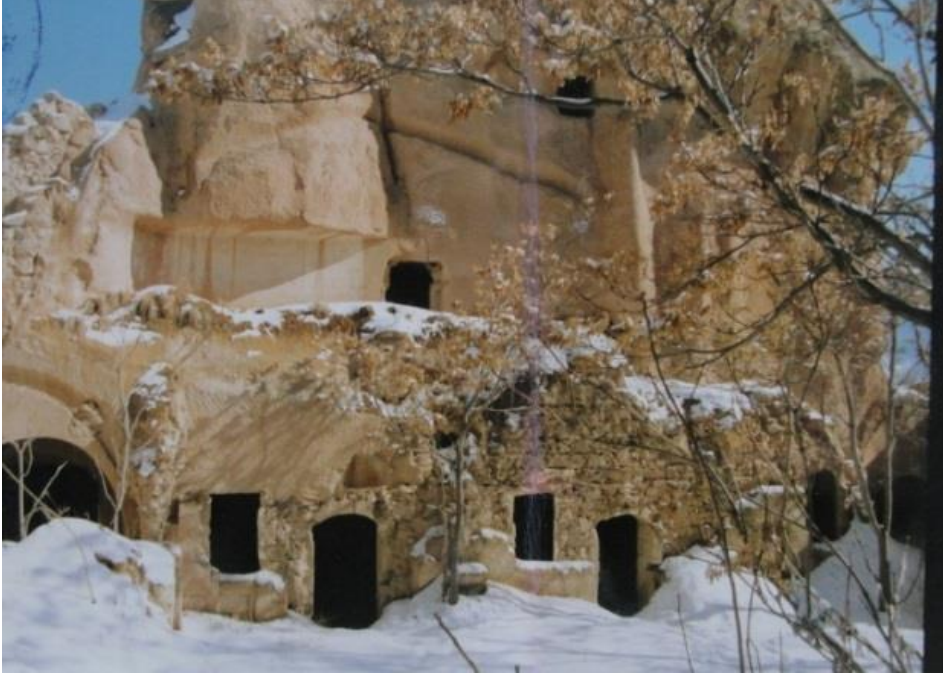
Şekil 4.198 : Aya Nikola Manastırı, batı cephesinin avlu içinden görünüşü, onarım öncesi (NKK Arşivi).
