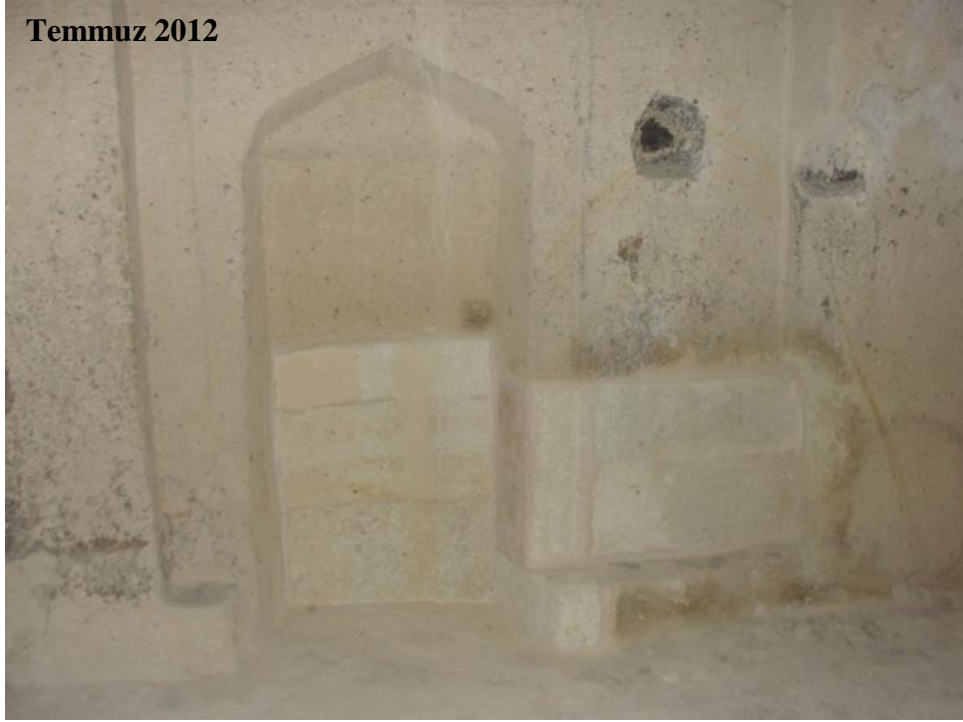
Şekil 4.184 : Mihrap nişinin mevcut durumu.
