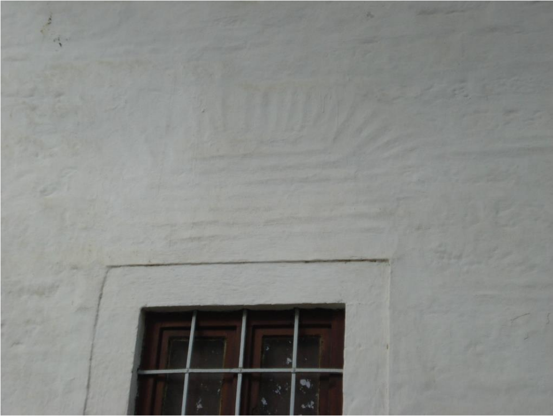
Şekil B.84: Güney cephesi pencere üzerinde bulunan kemer izi.
