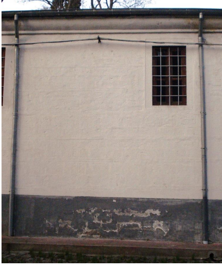
Şekil B.145: Cephede görülen sıva dökülmelerine örnek.
