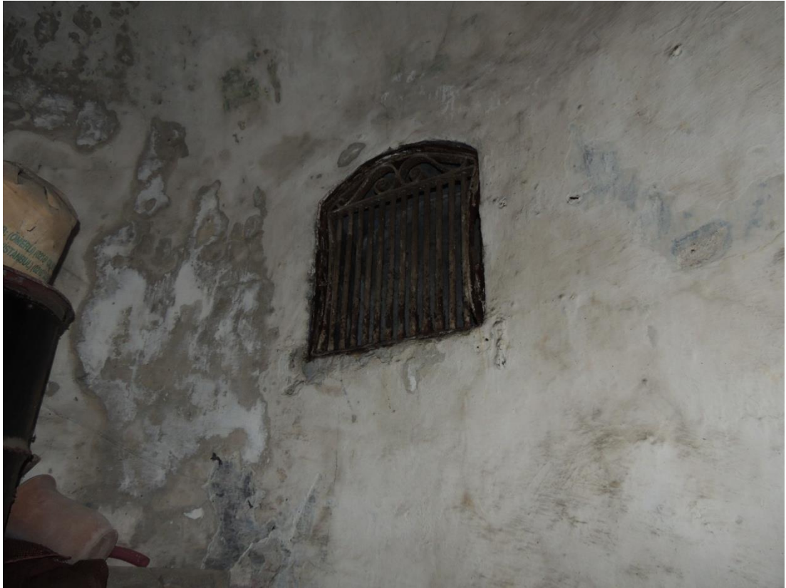
Şekil B.118: Z09 mahalli duvarlarında gözlemlenen sıva dökülmeleri.
