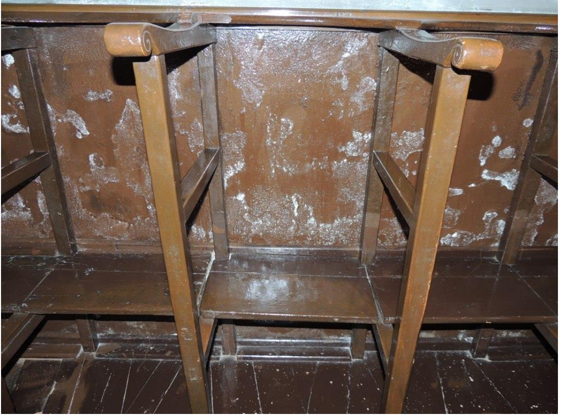
Şekil B.151: Nemden kaynaklanan sıva dökülmeleri ve tozuma.
