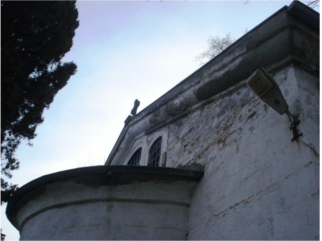
Şekil B.102: Doğu cephesi sıva dökülmesi taş dokusu.
