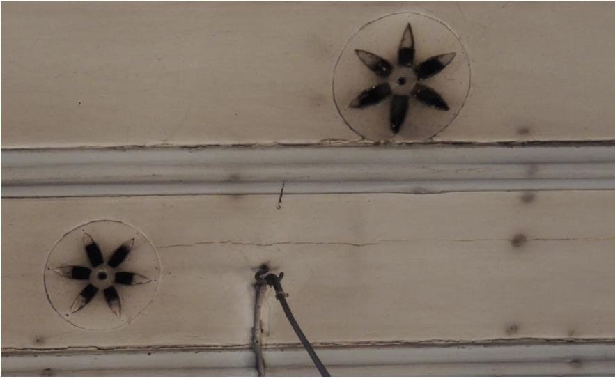
Şekil B.129: Ahşap tavan kaplaması içinde yer alan havalandırma delikleri.
