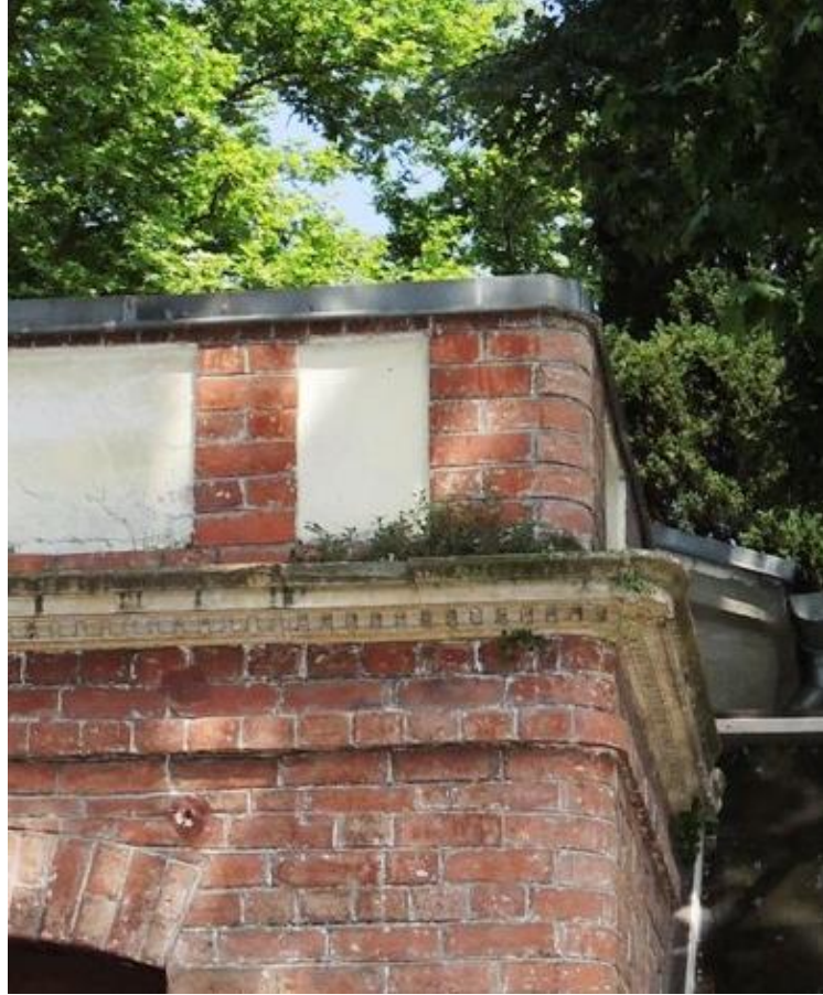
Şekil B.148: Silmelerde görülen bitkilenmeler.
