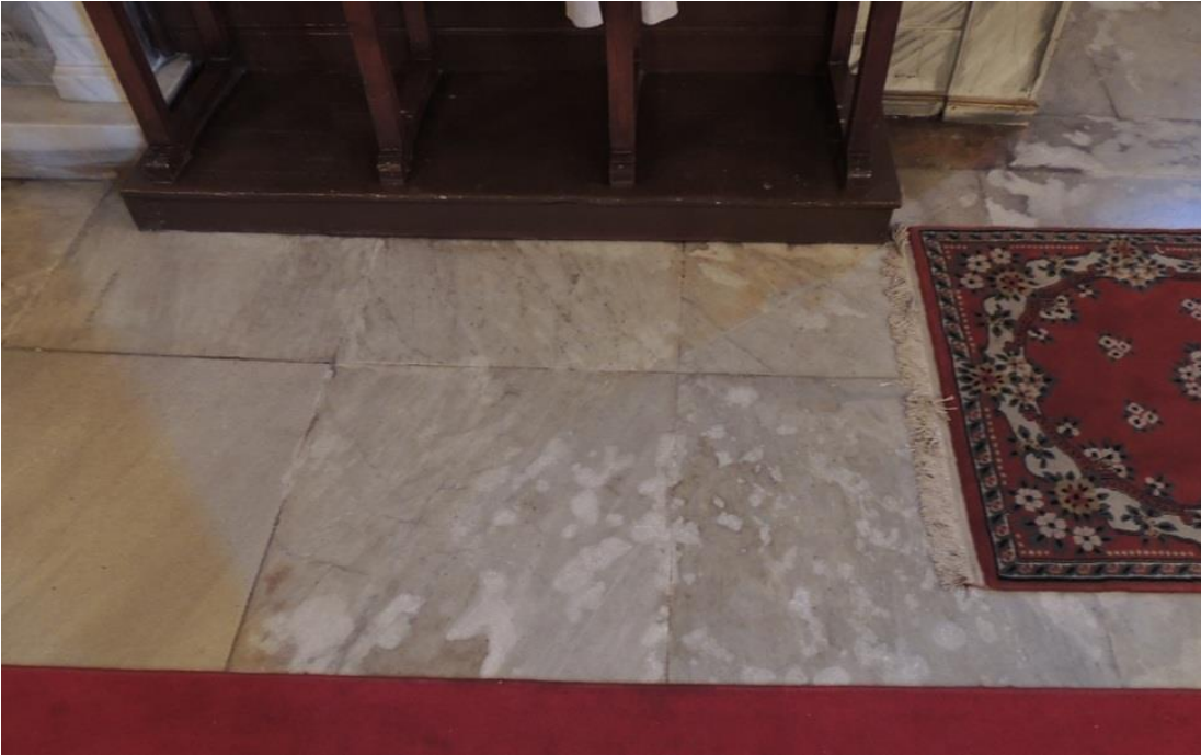
Şekil B.142: Naos mermer döşeme kaplamalarındaki yüzey kirliliği.
