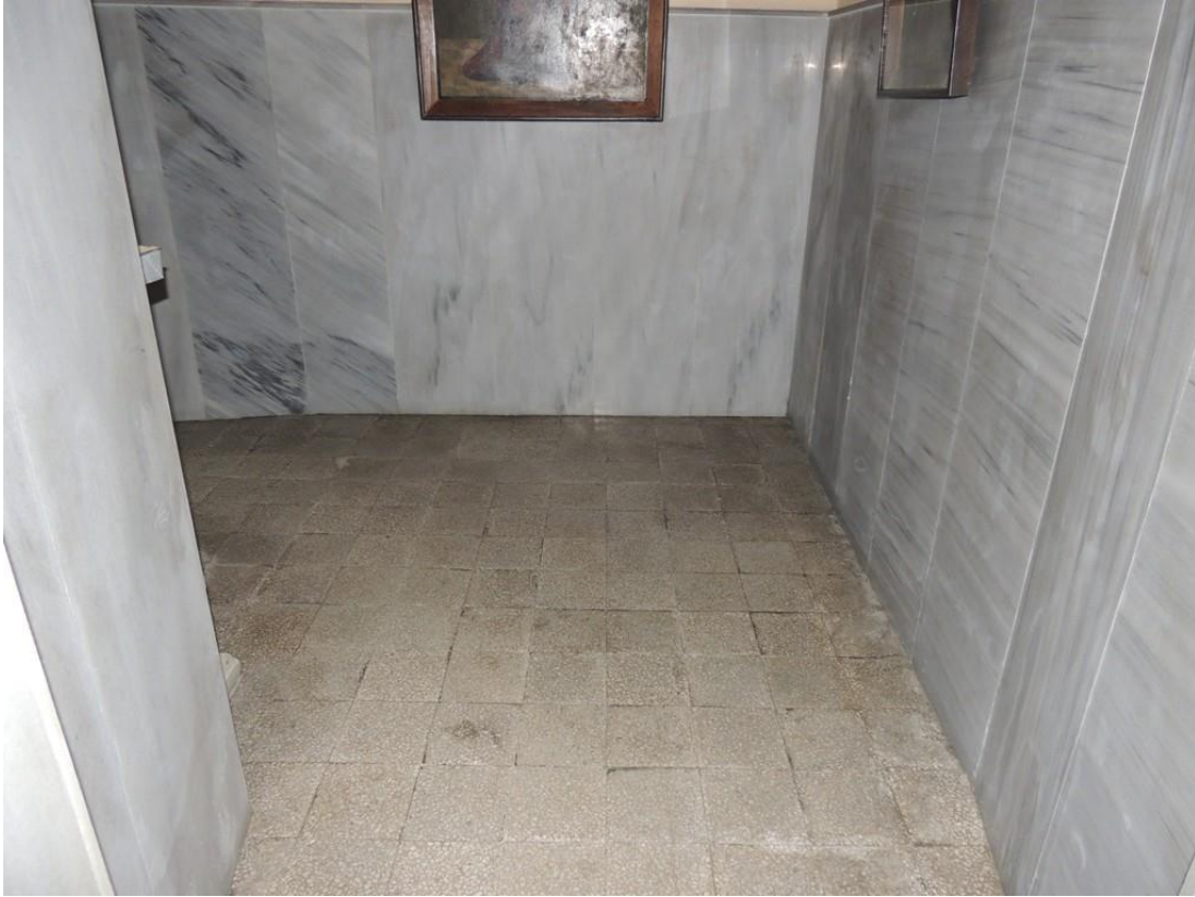
Şekil B.31: Z07 mahalli döşeme kaplaması.
