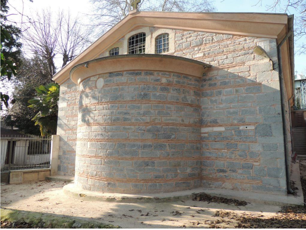
Şekil B.111: Sıva raspaı sonrası doęu cephesi.
