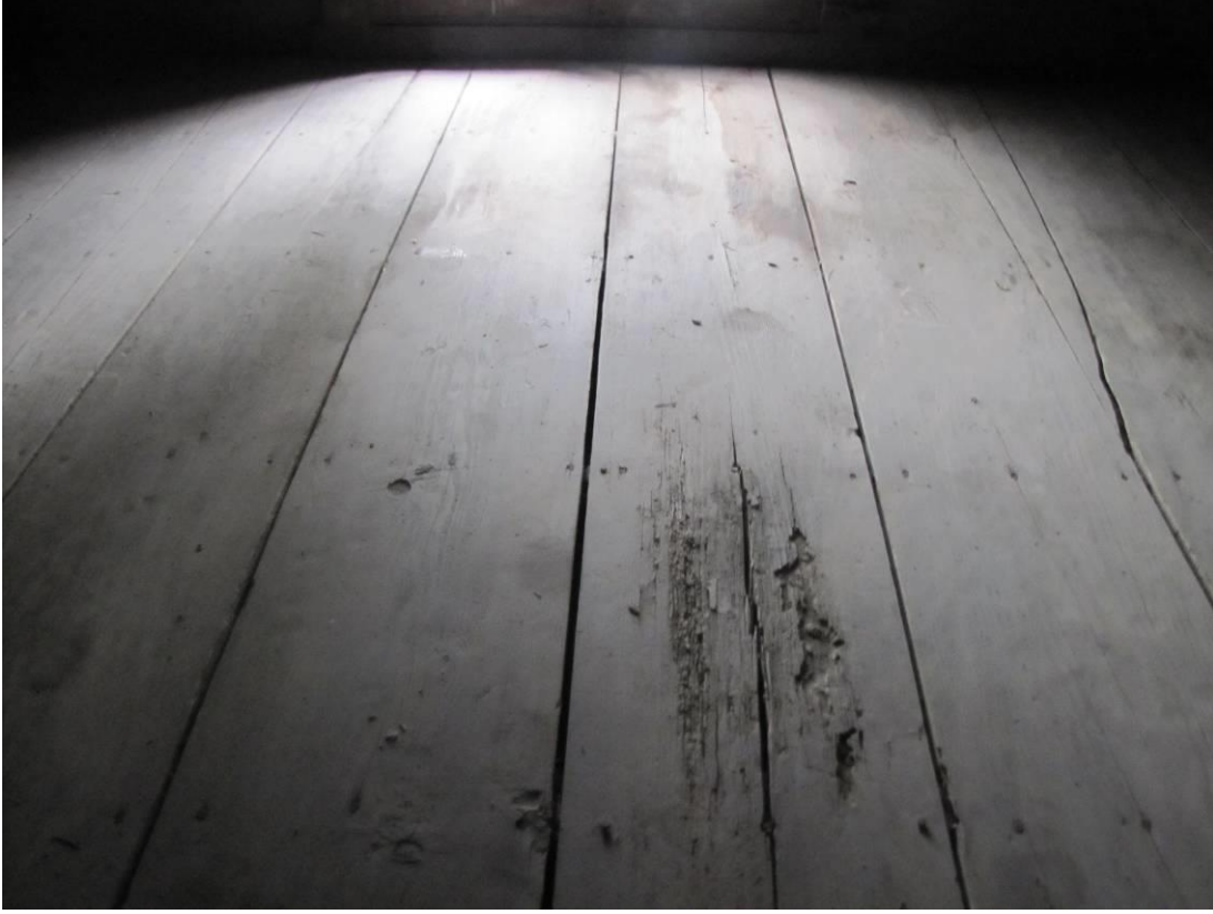
Şekil C.41: ÇK03 Çatı arası mekanı döşeme kaplamalarında bozulma.
