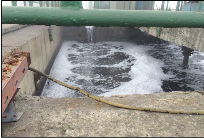
Şekil 3.15 : Nötralizasyon ünitesi fotoğrafı.
