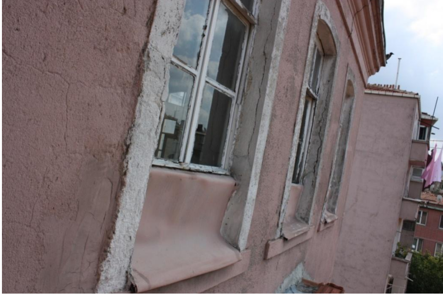
Şekil 4.167 : İkinci kat kuzeybatı sövelerin iç yüzeylerinde yer alan çatlaklar
