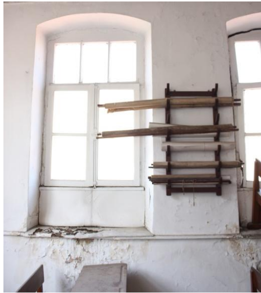
Şekil 4.173 : Pencere altlarında nemden dolayı duvarda boya dökülmesi ve çürüme belirtileri
