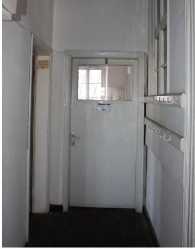
Şekil 4.128 : 204 numaralı öğretmen odası özgün olmayan ahşap kapı
