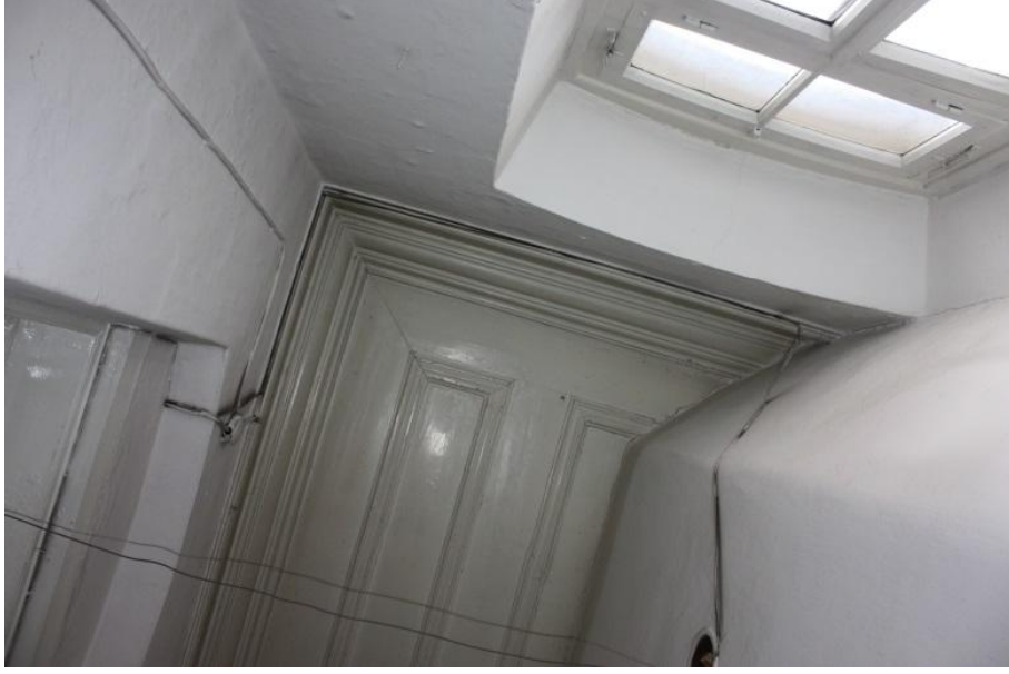
Şekil 4.36 : Duvarın kırılarak cepheye saplandığı ve tavan silmesinin kesintiye uğradığı bölge
