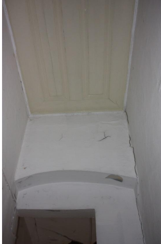
Şekil 4.163 : 107 numaralı koridorun kuzey köşesinde yer alan çatlağın üst kata devamı
