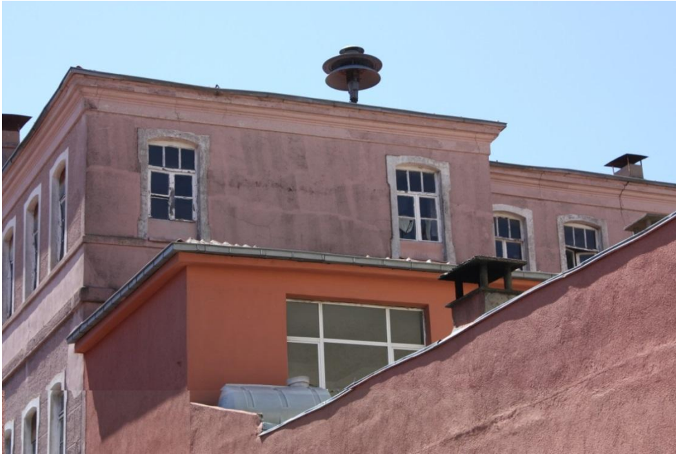
Şekil 4.166 : Yapının ikinci kat kuzeybatı cephesindeki çatlaklar
