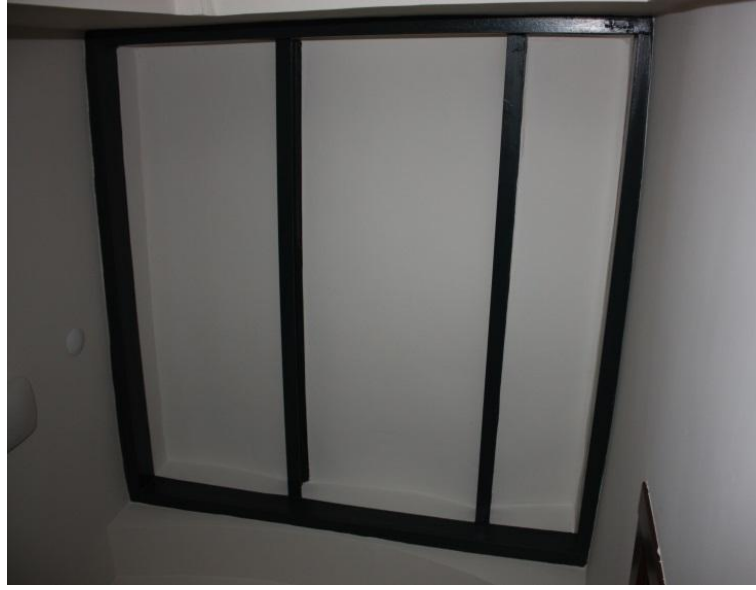
Şekil 4.13 : Volta döşemeli kısım ve yapılan güçlendirme
