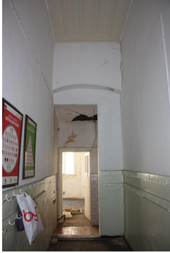
Şekil 4.162 : 107 numaralı koridorun kuzey köşesinde yer alan çatlak
