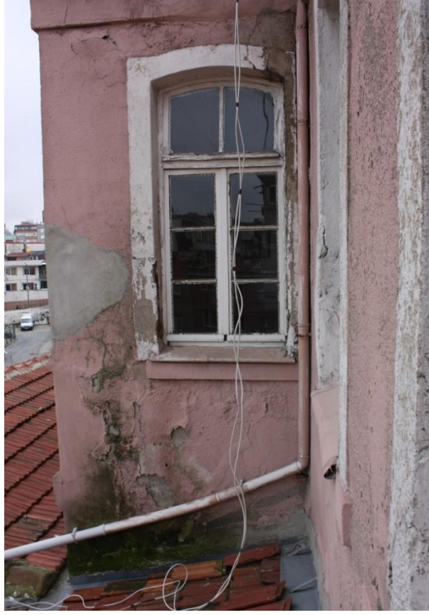
Şekil 4.175 : 206 numaralı mekan batı köşesi nemden dolayı duvarda hasar ve yosunlanma
