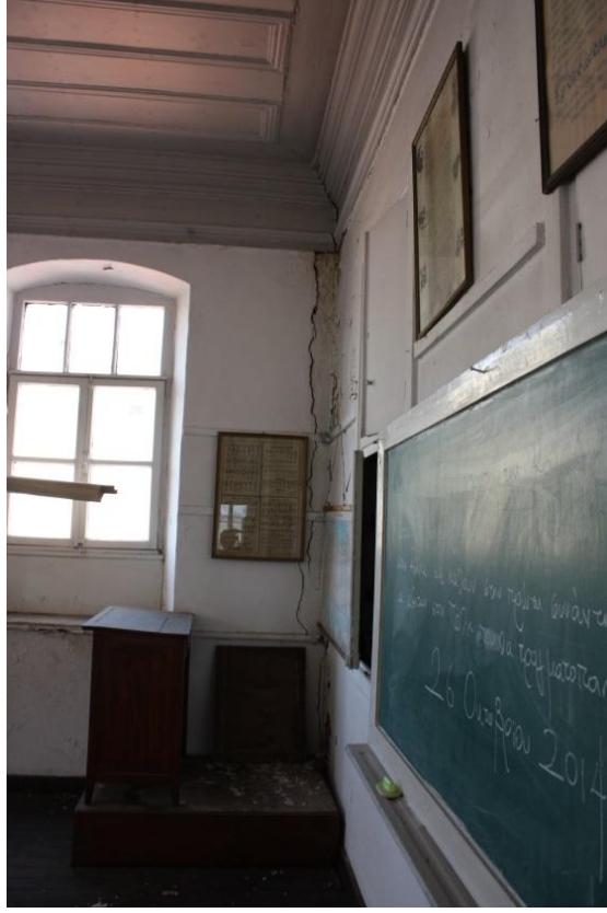
Şekil 4.164 : 207 numaralı mekanın kuzey köşesindeki çatlak
