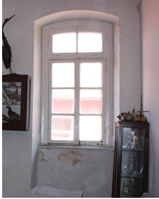
Şekil 4.172 : Pencere altlarında yüzeyde boya dökülmeleri ve çatlaklar
