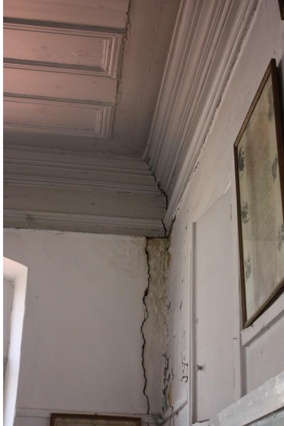
Şekil 4.165 : 207 numaralı mekanın kuzey köşesindeki çatlağın çatıya kadar devamı
