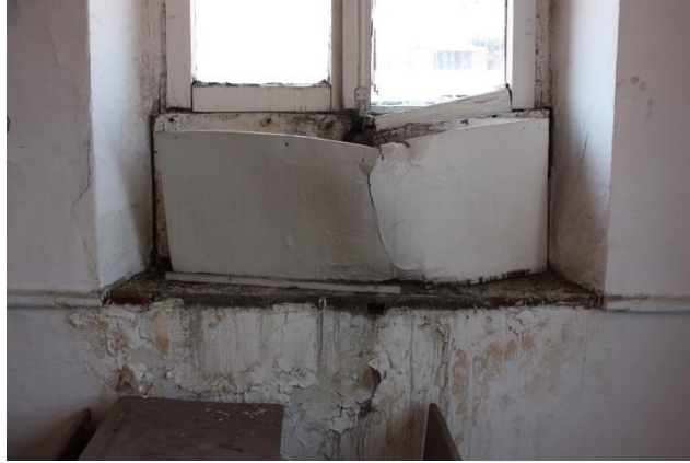
Şekil 4.169 : 207-206 numaralı sınıfların kuzeybatı cephelerinde doğramaların ahşapla kaplanmış kısımlarında çürüme
