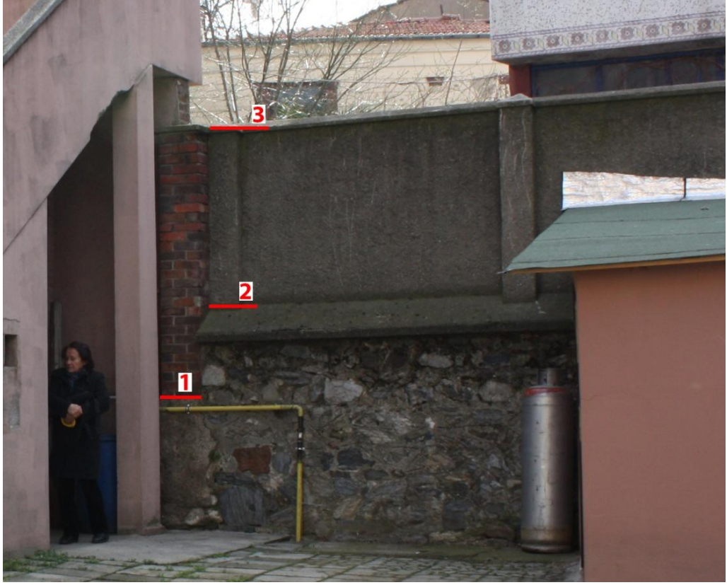
Şekil 5.26 : Okulun bahçesinden duvarın katmanlaşması
