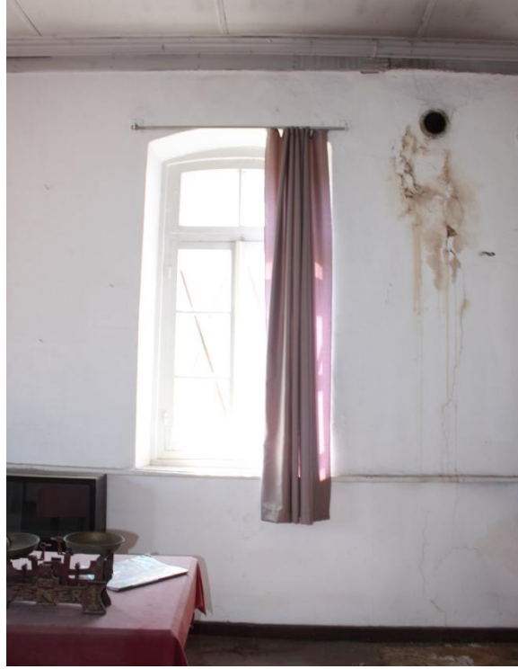
Şekil 4.174 : Soba borularının bağlandığı kısımlarda duvarda kirlenme ve boya dökülmeleri
